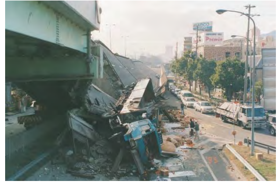
崩壊した阪神高速道路
