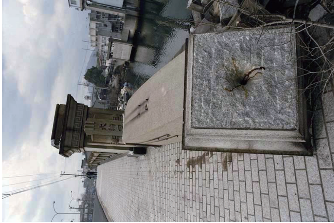
震災で崩壊した大輪田橋の飾り柱（1995年2月18日）
