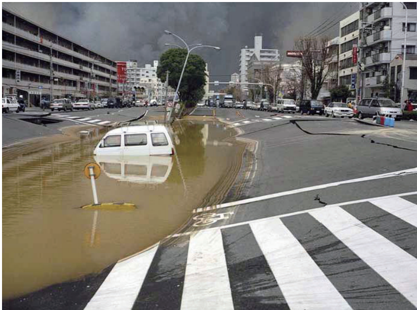
大開通の道路陥没（大開駅の直上）。長田方面（写真上部）で火災の煙が上がっている。（1995年1月17日）
