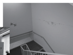
壁に亀裂が入り、破片が落下
