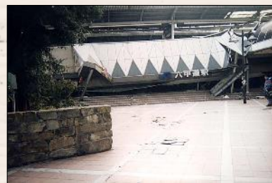
崩れた六甲道駅（撮影:大浦逸人）
