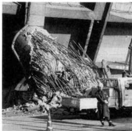
PHOTO7.1.6 HANSHIN EXP.WAY (HIGASHI-NADA-KU, KOBE) 写真7.1.6 阪神高速道路 (東灘区魚崎本町付近)
