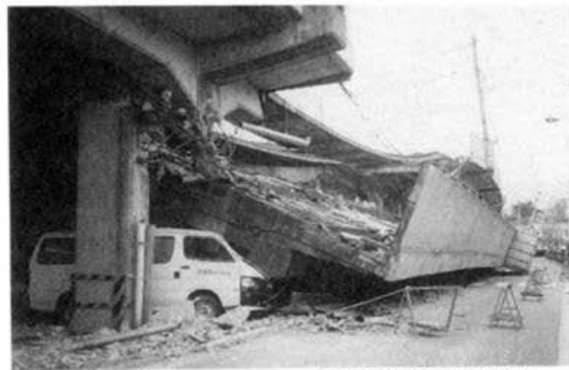
PHOTO8.3.4 JR-TOKAIDO LINE (HIGASHI-NADA-KU, KOBE) 写真8.3.4 JR東海道線 (東灘区御影町群家付近)
