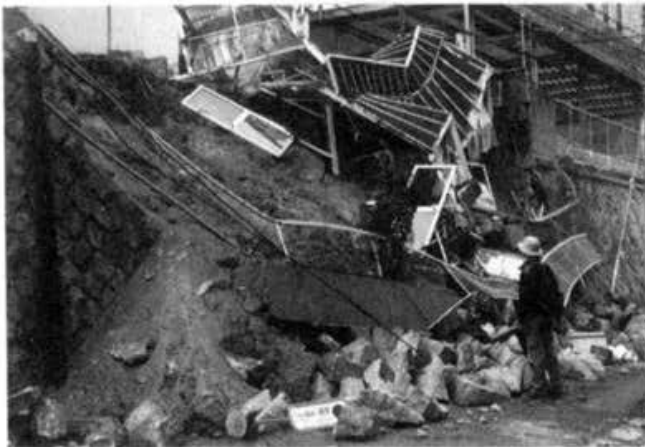
写真4. 4 石積み擁壁の崩壊 (神戸市中央区北野付近)
