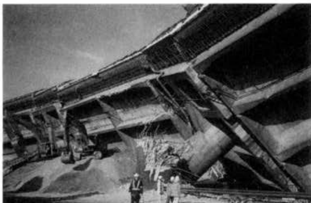
PHOTO7.1.5 HANSHIN EXP.WAY (HIGASHI-NADA-KU, KOBE) 写真7.1.5 阪神高速道路 (東灘区魚崎本町付近)
