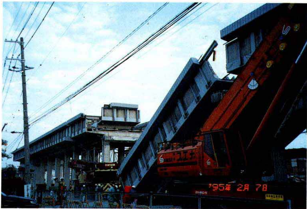
鉄道高架橋の橋桁落下
