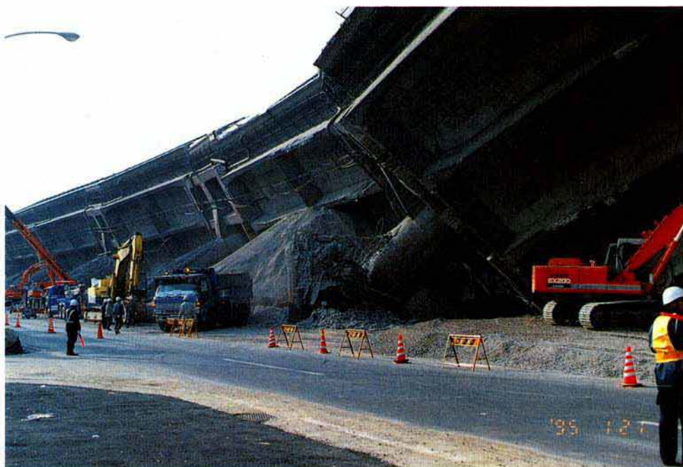
高架道路の倒壊
