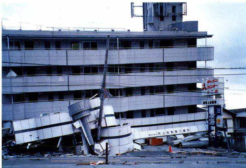
1 階部分の崩壊
