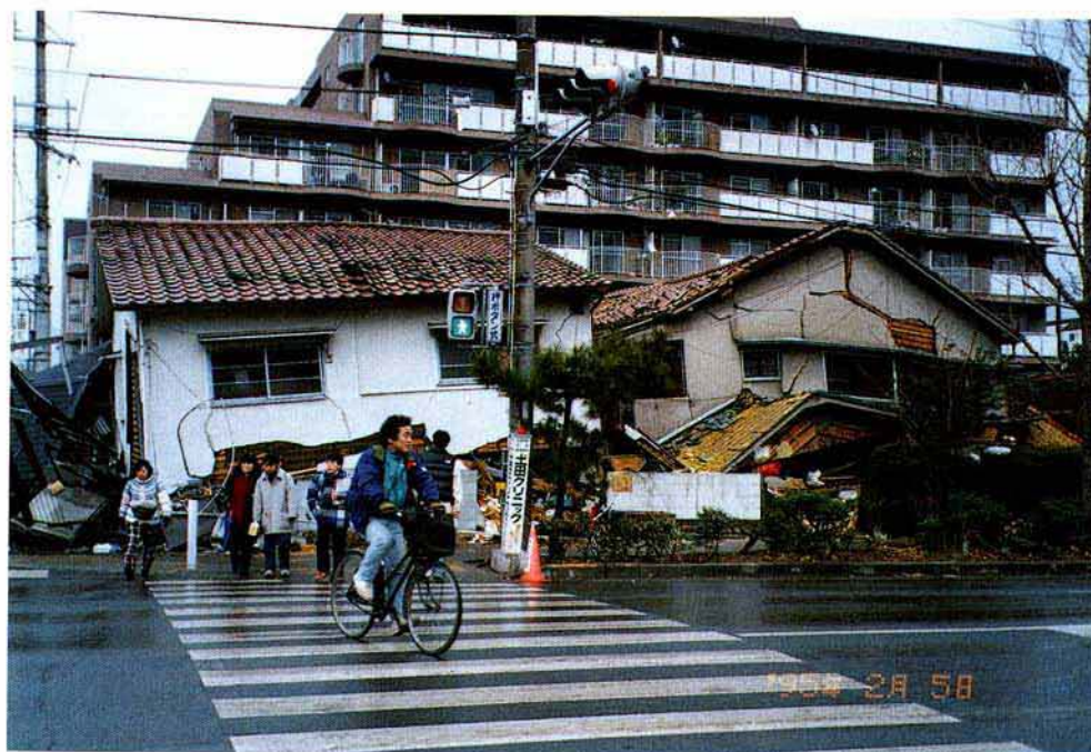
木造住宅 1 階部分の崩壊
