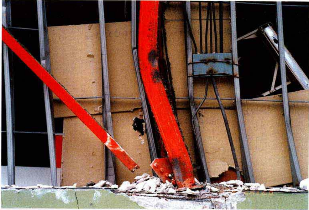
ブレースの破断，柱の座屈
