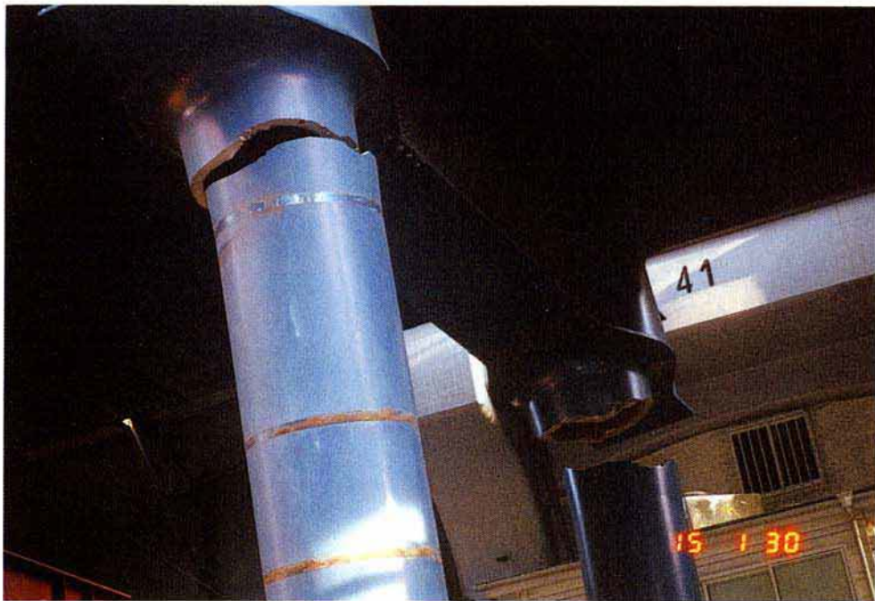
高架橋柱の破断
