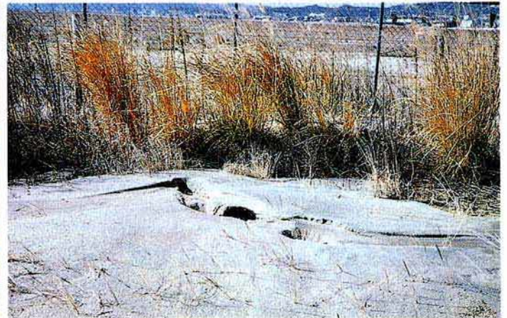
地震による液状化の状況
