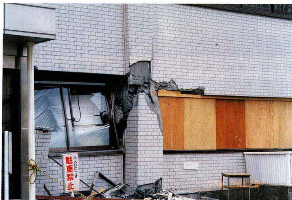
(5) 腰・たれ壁付き柱のせん断破壊例：事務所ビル，短柱がせん断破壊
