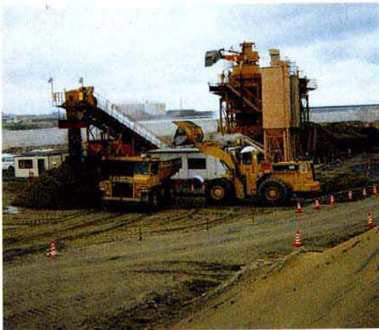
混合プラント
