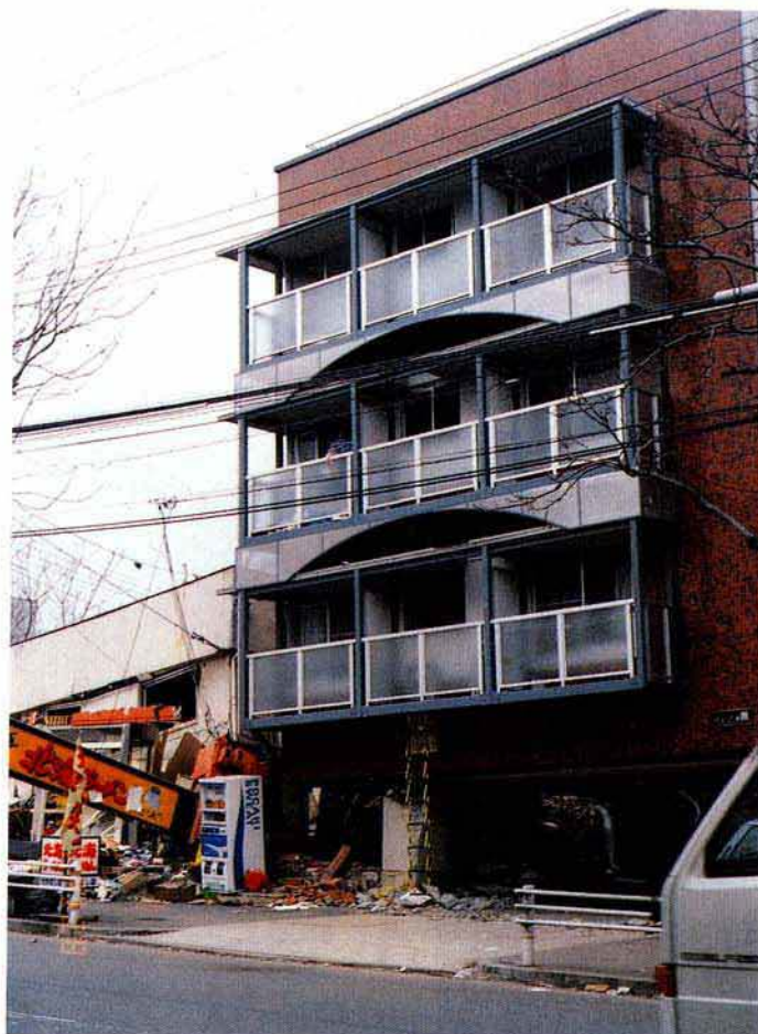
(4) 1階隅柱の曲げ圧壊例：1階が駐車場の集合住宅，層崩壊しなかった
