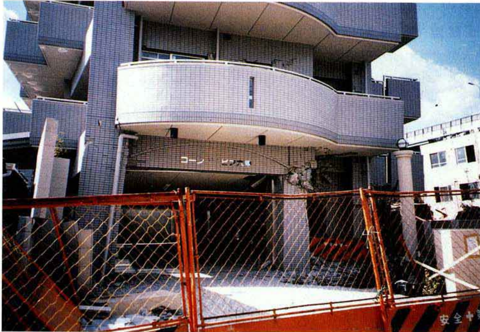
(c) RC造 / 5階建て：1階駐車場：新耐震基準（1階柱頭曲げ破壊）
