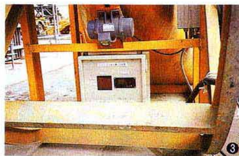
コンクリート自動定量打設装置 (制御盤)
