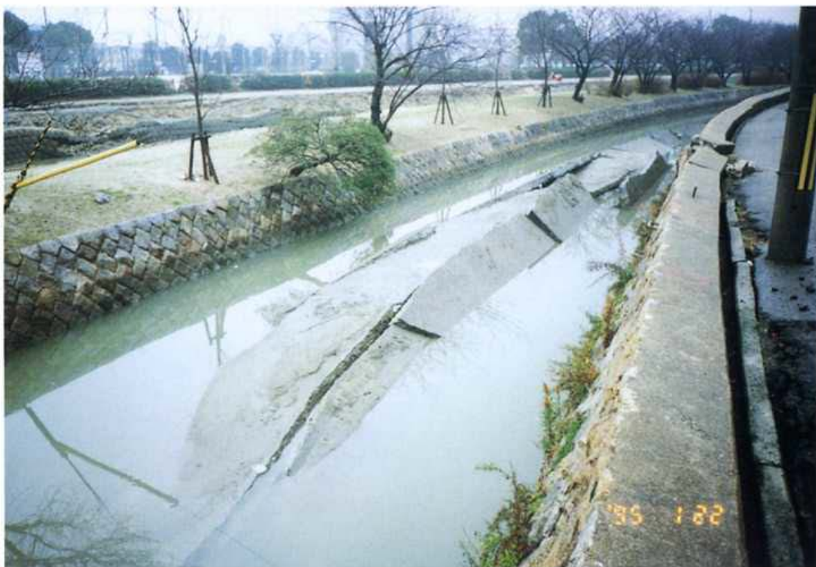
写真55 六湛寺川（西宮市雨水幹線）における河床版の隆起
