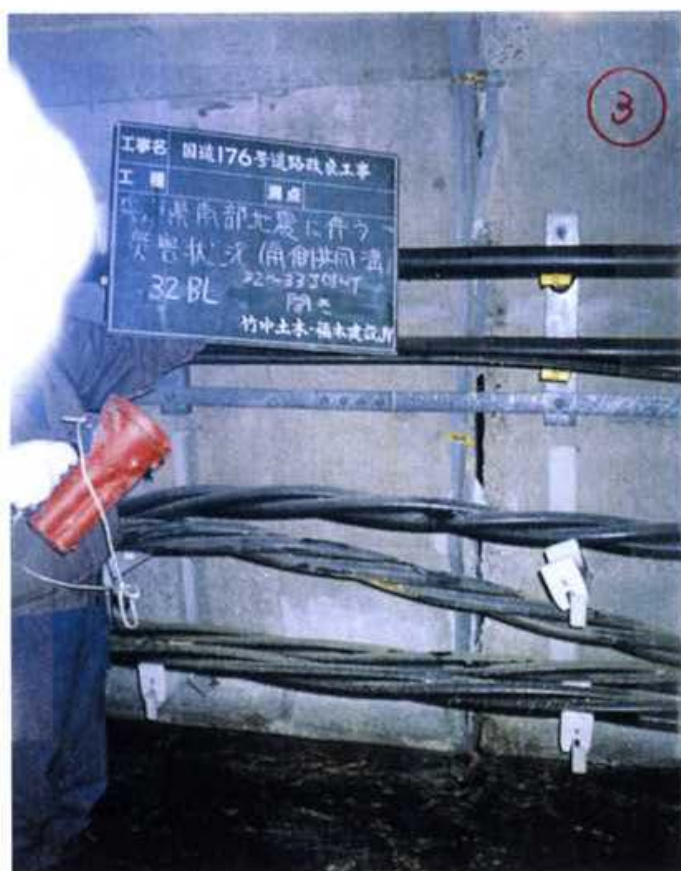
写真50 共同溝目地部のはずれ
