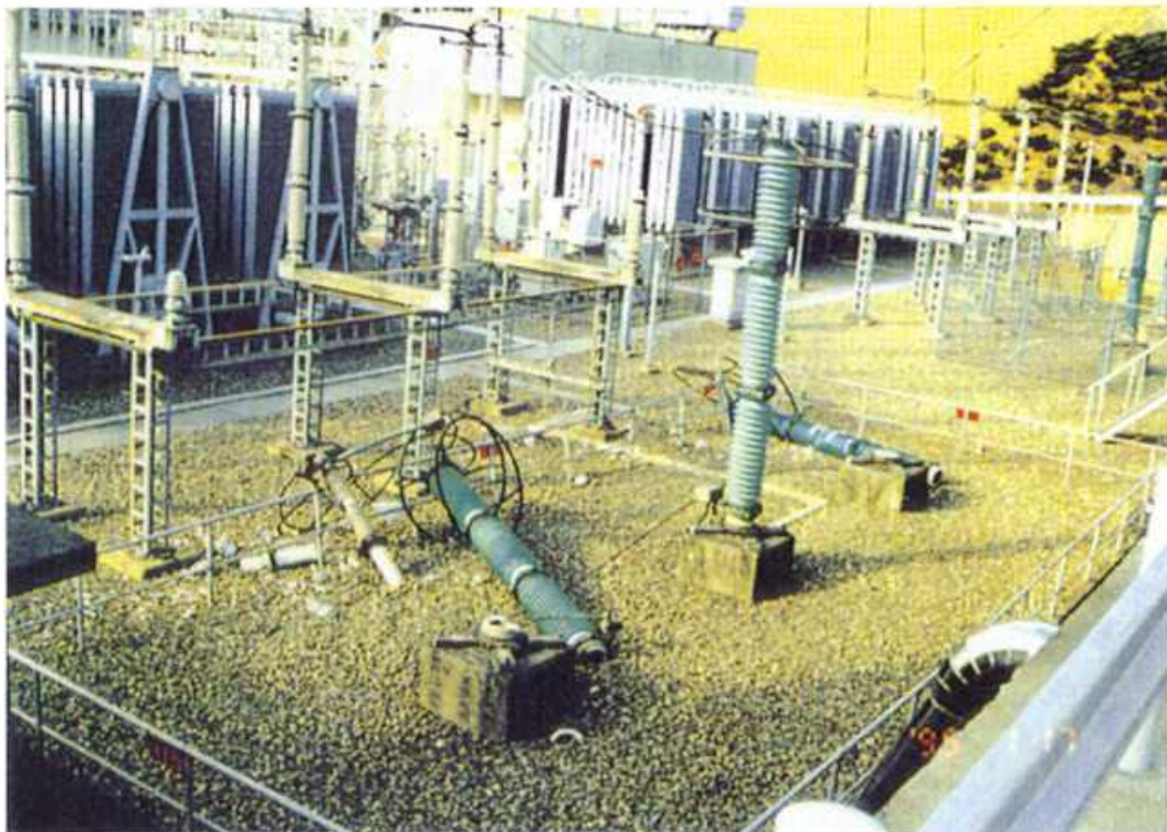
写真37 新神戸変電所の被害
