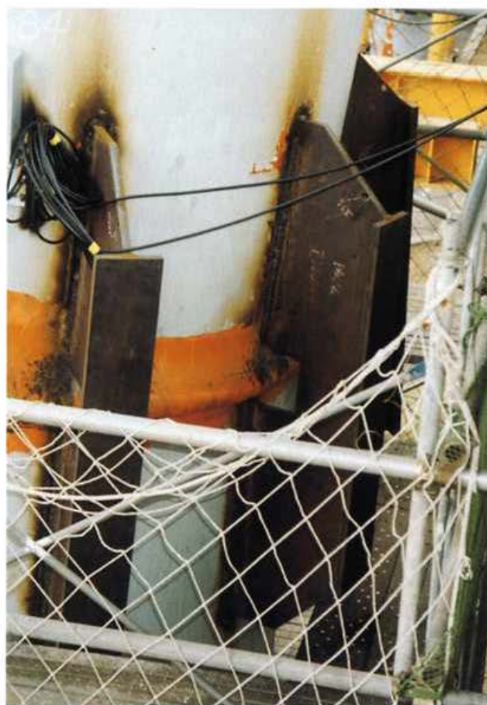
写真28 鋼製単柱式丸柱橋脚の「ちょうちん座屈」現象と 応急復旧の状況
