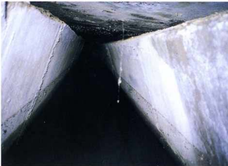
写真35 側壁倒壊（兵庫区 松本通雨水幹線）
