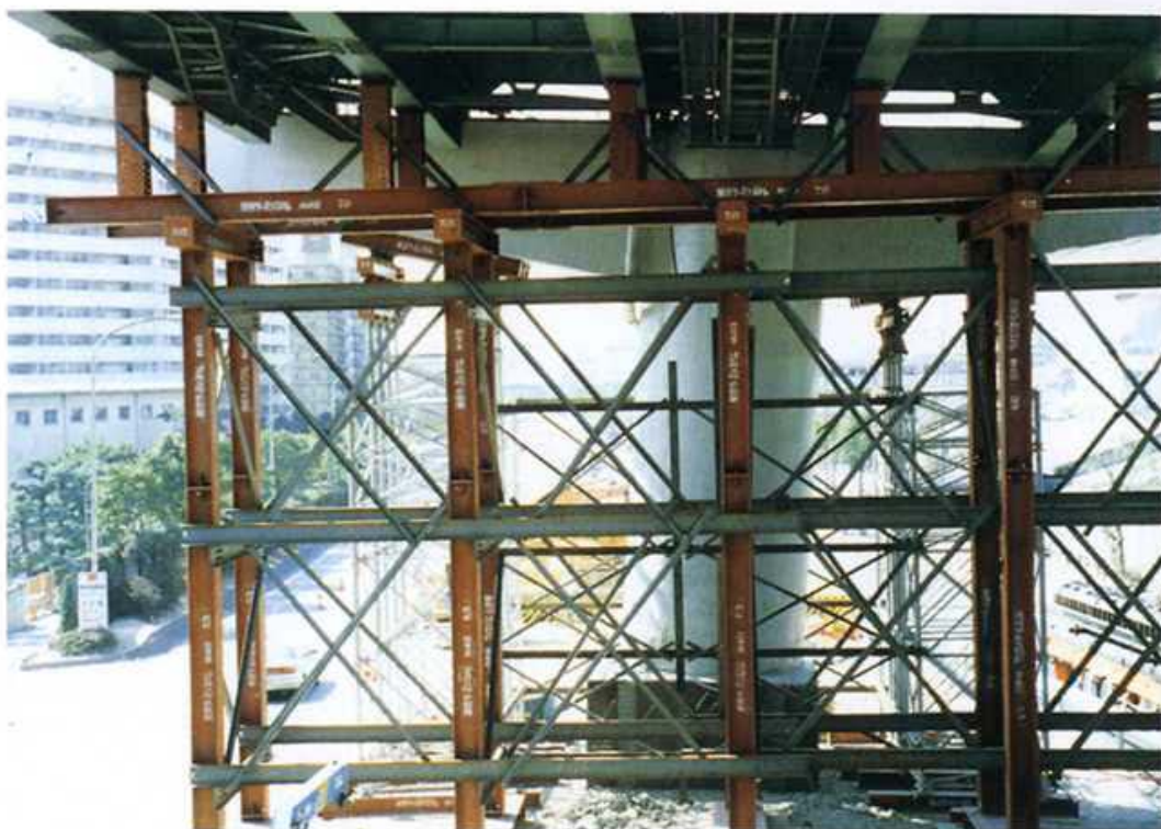
写真27 RC製単柱式丸柱橋脚の損傷と応急復旧の状況
