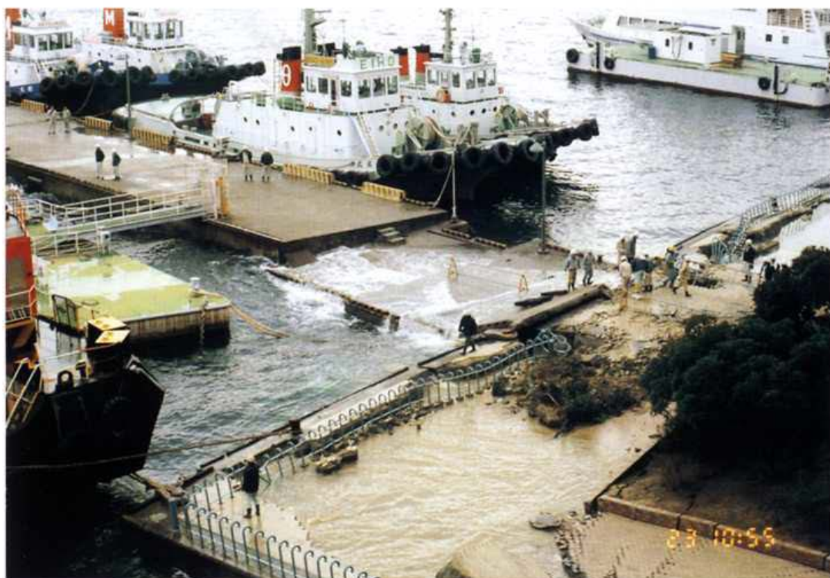
写真61 ポートアイランド北公園北東隅角部波除堤の沈下、護岸の滑動
