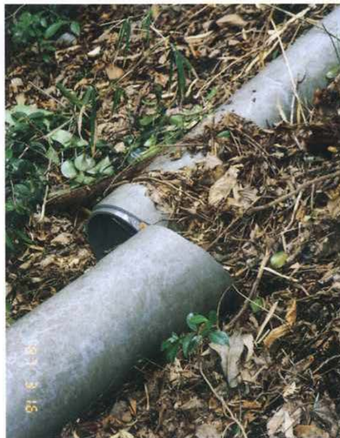
写真44 野島断層近傍の管路破害（2）
