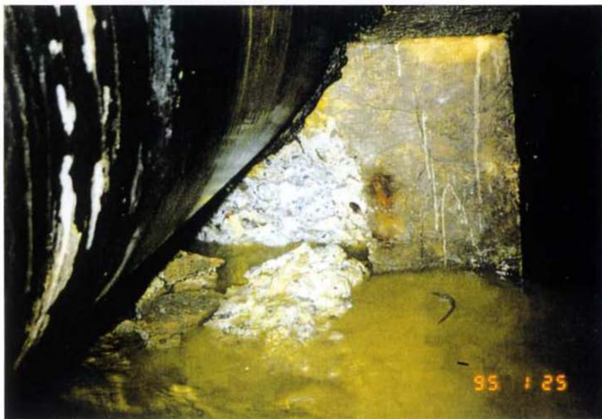
写真48 共同溝内管受台の損傷
