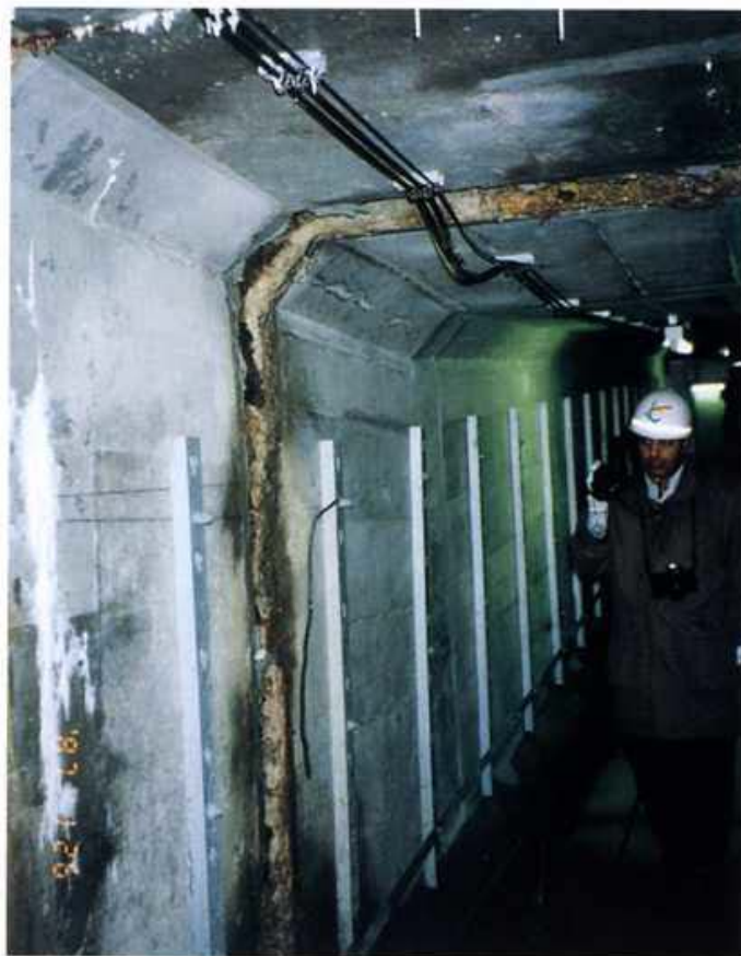
写真51 洞道のジョイント部ずれ
