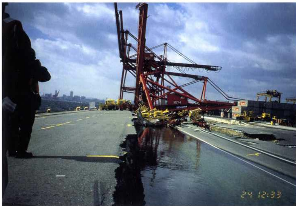
写真60 六甲アイランド南コンテナバス (ケーソンの海側への滑動によるクレーン倒壊、ヤードの沈下)
