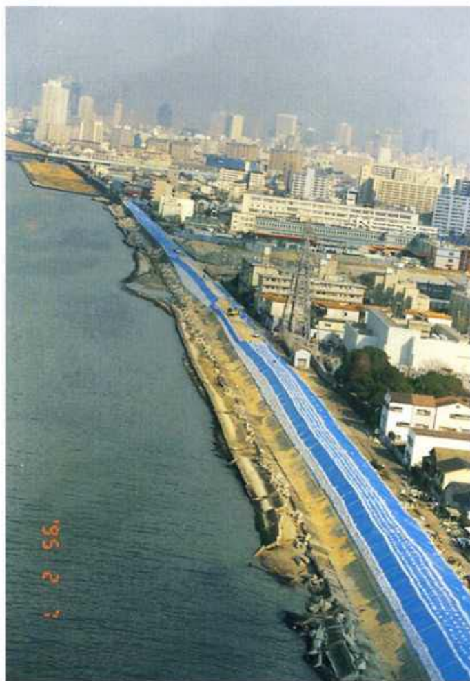
写真53 淀川左岸西島地区の被害（協力：中日新聞）
