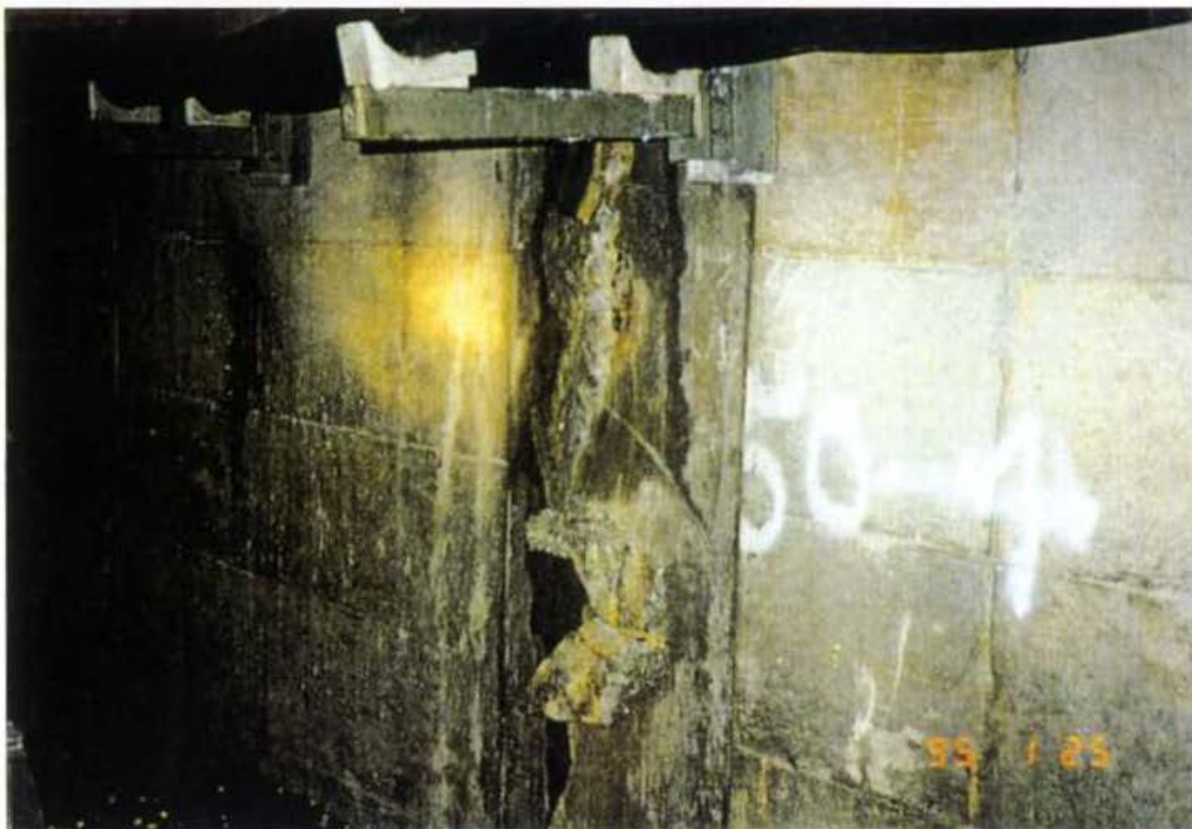
写真47 共同溝躯体クラック
