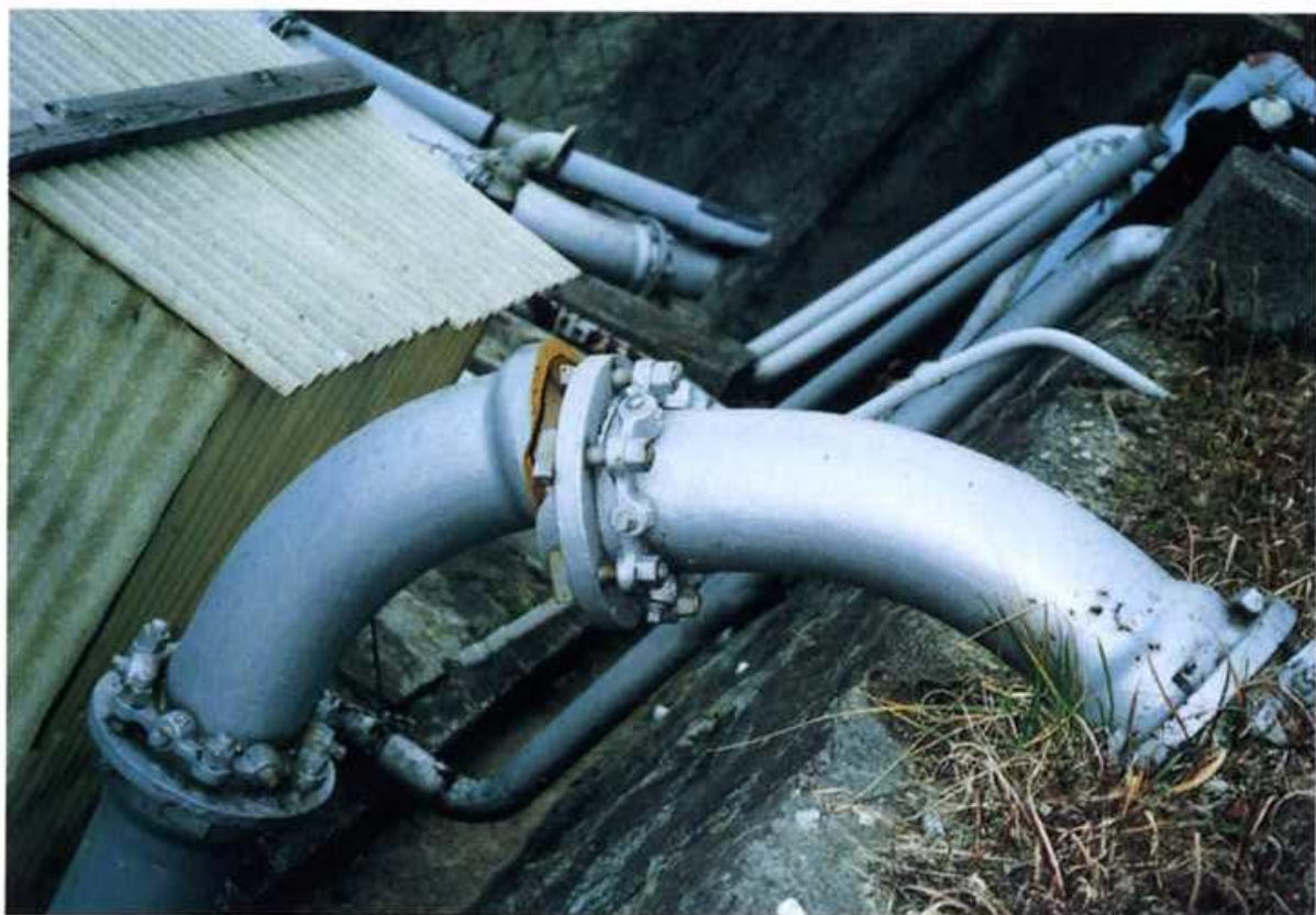
写真42 水道配水管曲り部での折損
