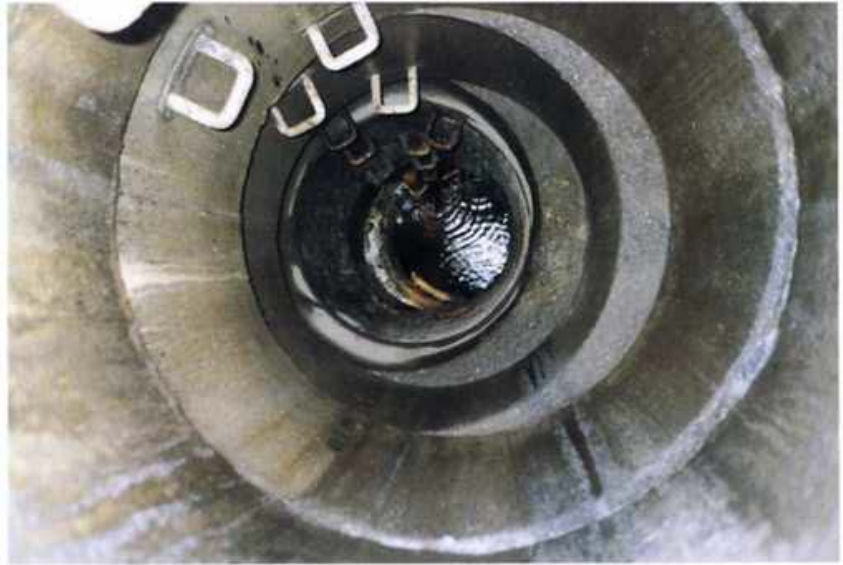
写真34 マンホールブロックのずれ（兵庫区 和田岬雨水幹線）
