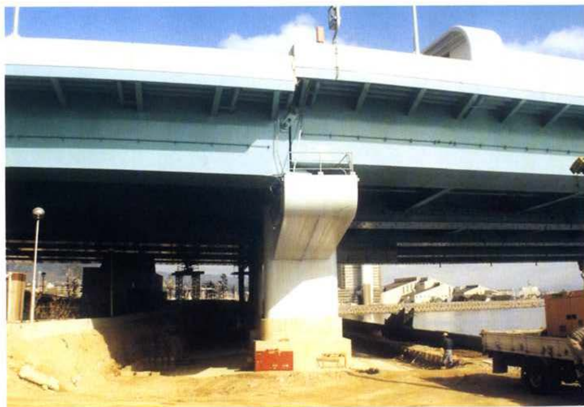
写真24 南芦屋浜埋立地の道路橋梁基礎の変状
