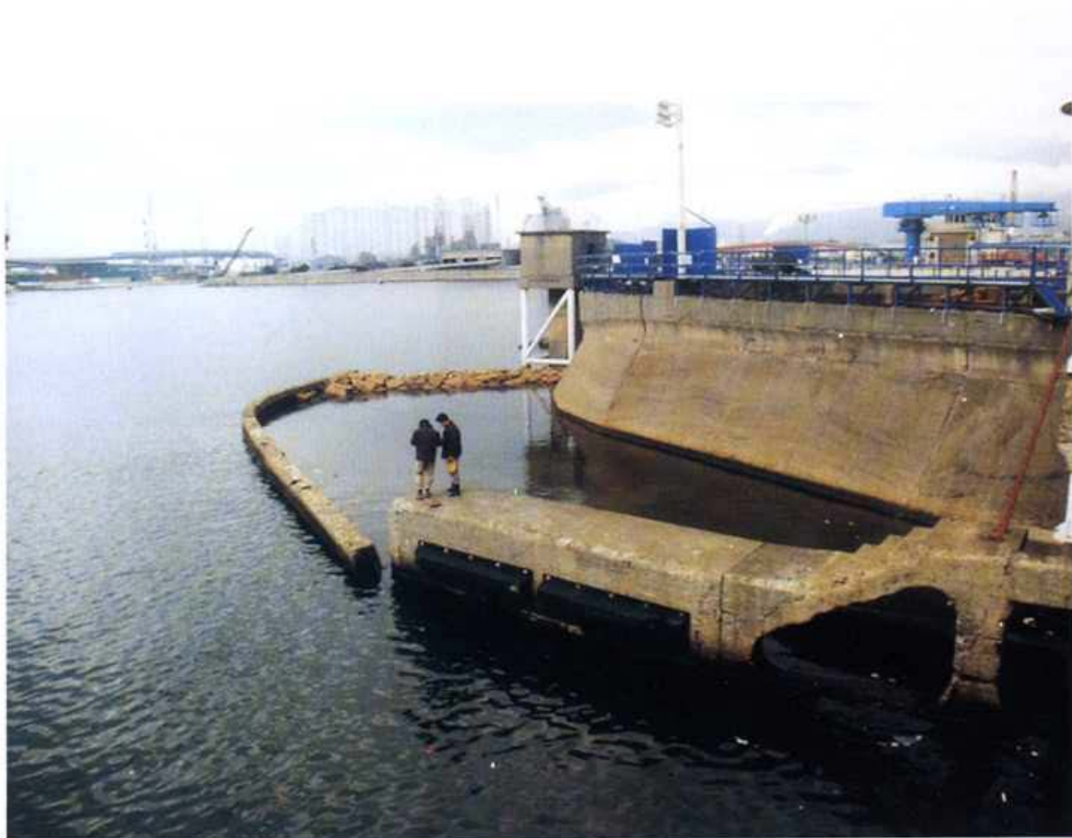
写真23 尼崎閘門付近の護岸構造物の沈下
