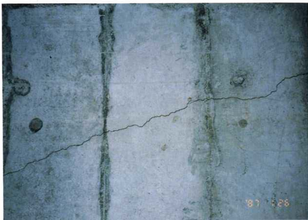
写真45 洞道躯体のクラック
