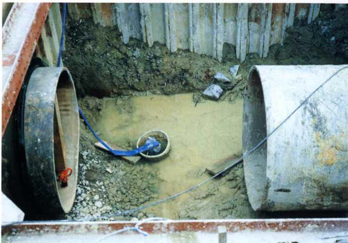
写真41 上ヶ原浄水場の送水管継手部抜け被害
