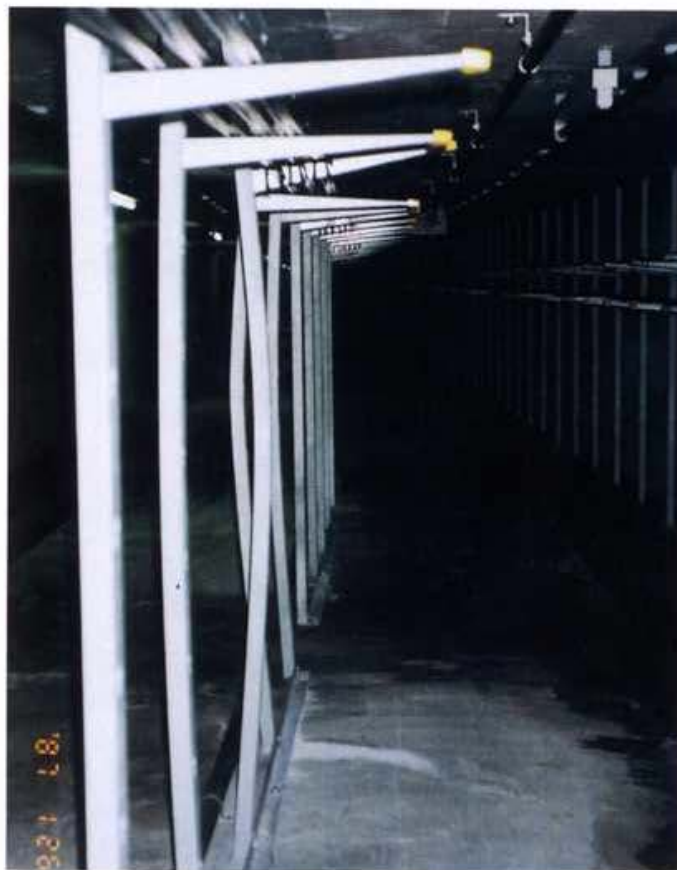
写真52 洞道内支柱の座屈
