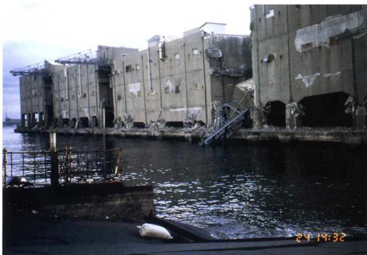
写真58 新港第7突堤上倉庫の1階支柱の崩壊
