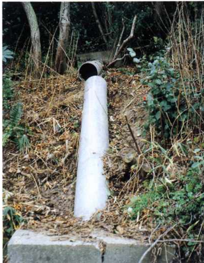
写真43 野島断層近傍の管路破害（1）
