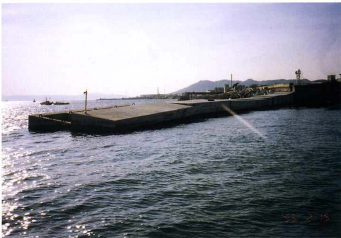
写真25 長田港防波堤ケーソンの傾斜・沈下
