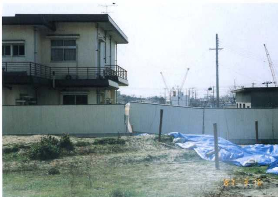
写真4 断層上家屋塀の破壊
