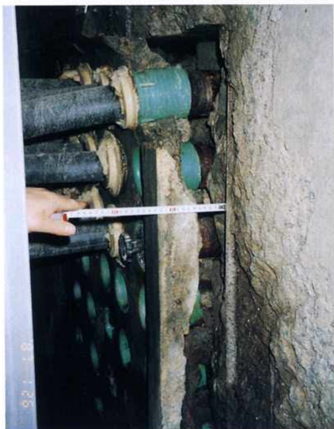
写真49 通信ケーブル管のマンホール部での抜け
