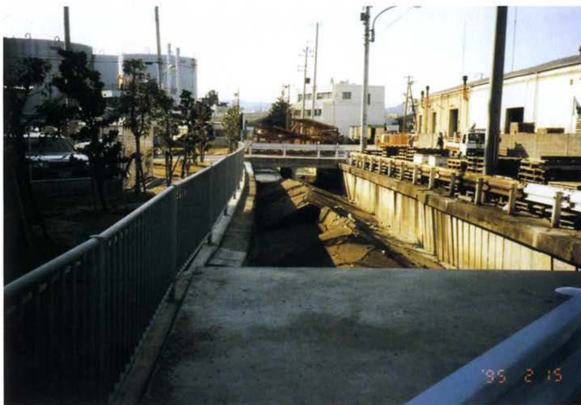
写真26 長田港付近の人工河川床の座屈
