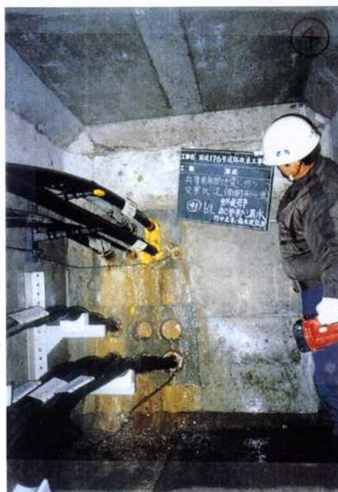
写真46 共同溝内ケーブル貫通部の損傷
