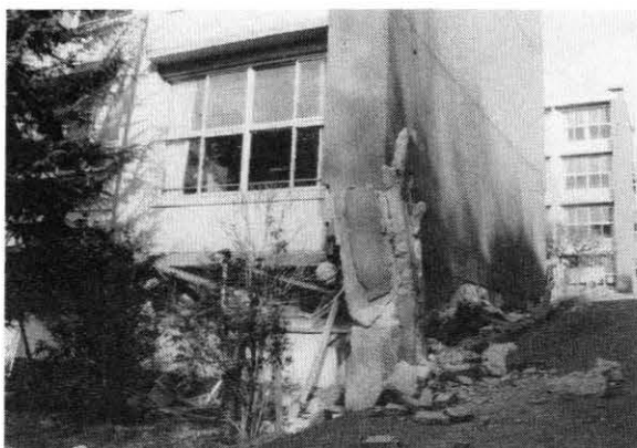
座屈したA棟東側部分
