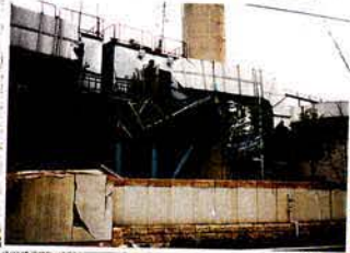
脱臭ダクト破壊
