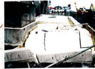
重油タンク破損
