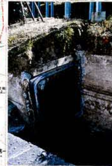
流入水路破損
