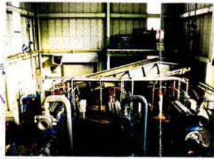
天井クレーン落下
