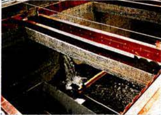
最終沈殿池破壊漏水
