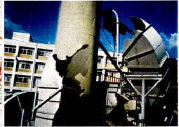
脱臭ダクト破壊
