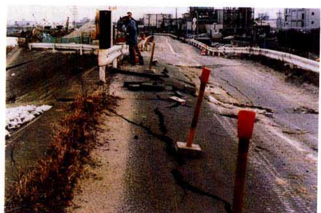
写真4 神崎川(天端の亀裂、沈下)
