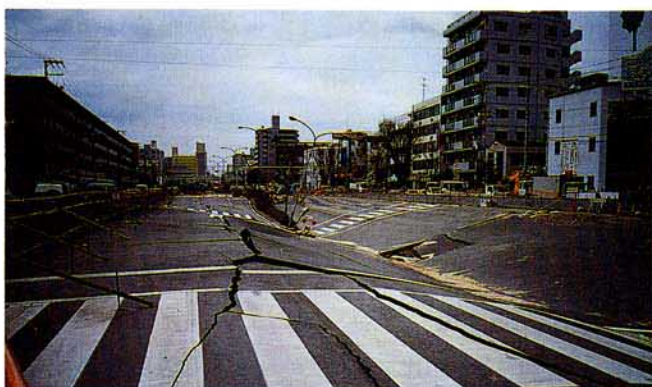
写真8 陥没による損壊
