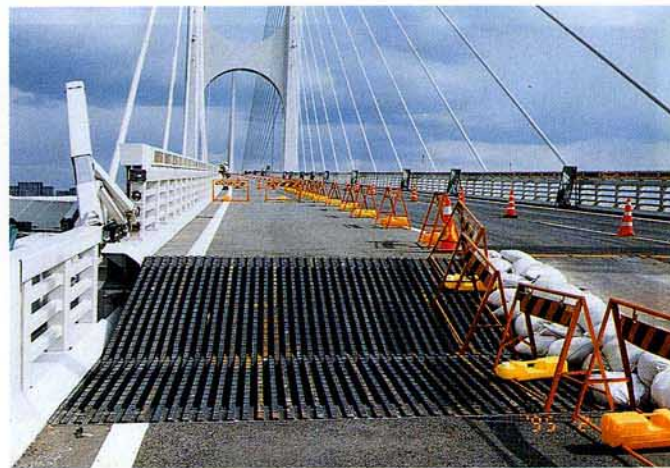
写真 14 東神戸大橋の路面の段差
