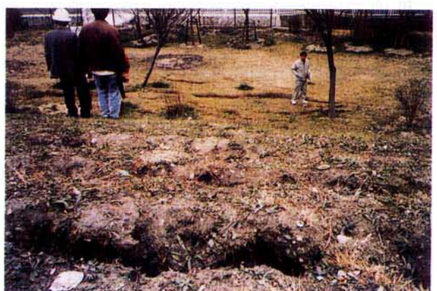
(b) 堤防裏のり面の亀裂
