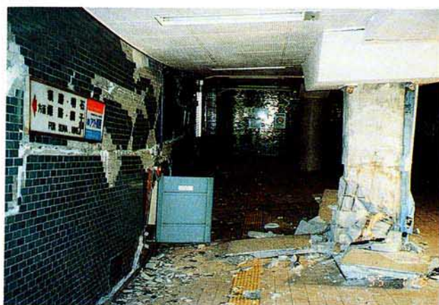
写真-1 大開駅地下1階の被害状況
