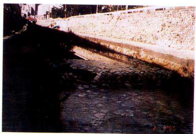
(b) 低水護岸、床止め工の破損
