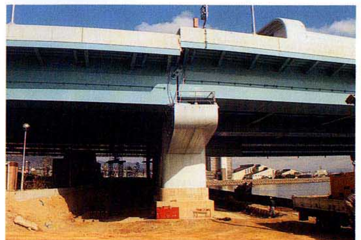
写真-6 阪神高速湾岸線橋梁基礎の 水平移動（南芦屋浜埋立地東護岸）
