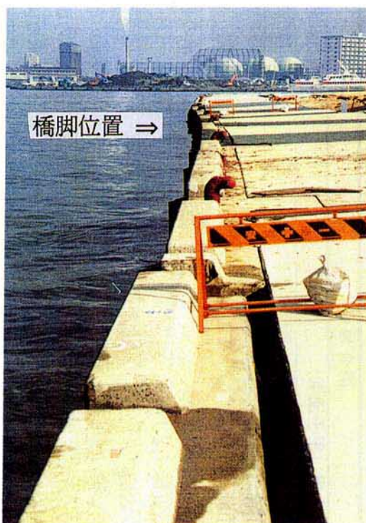
写真-3 周辺護岸の変状
