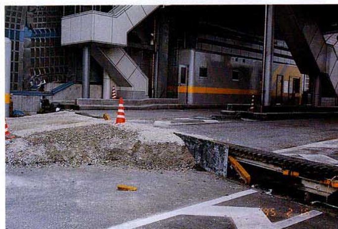
写真 10 南芦屋浜料金所付近の路面の段差
