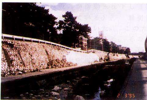
(a) 石積み護岸の崩落
