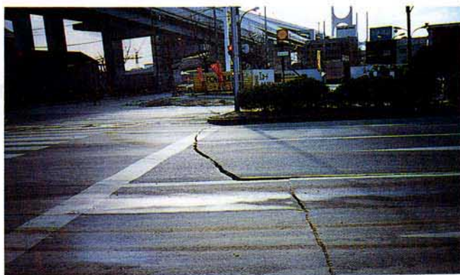
写真4 交差点周辺のひびわれ（その1）
