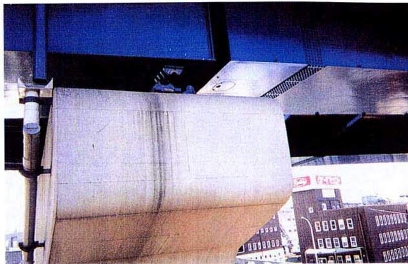
H 1 3 支承上における鋼桁の横ずれ
