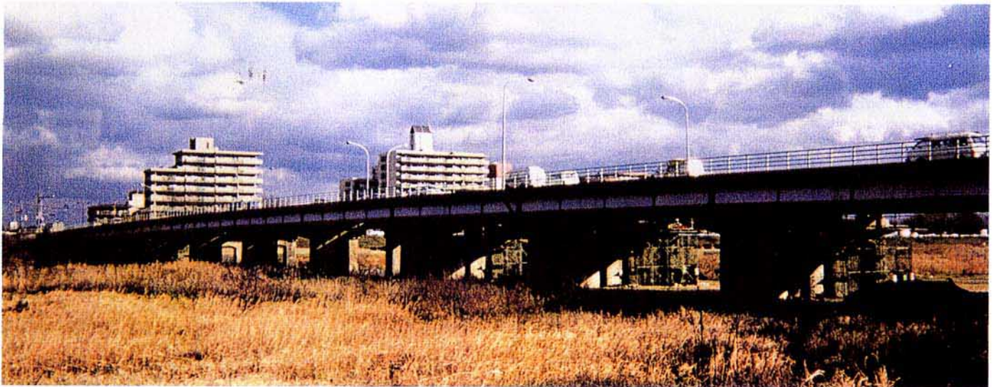
S 1 2 軽微な被害の国道 171 号線の橋脚
