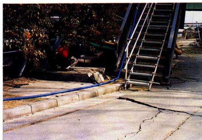
写真－6 東灘下水処理場の被災現場
