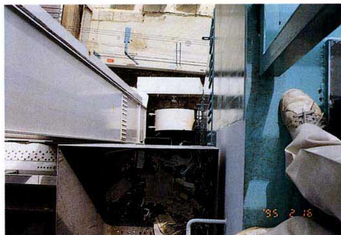
写真 13 東神戸大橋の支承の損傷
