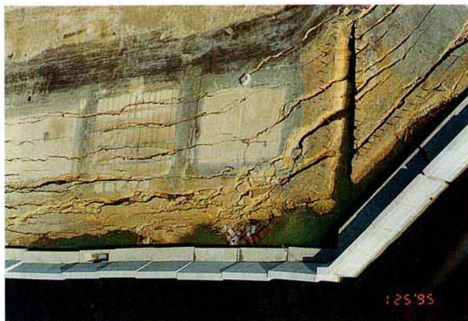
写真-8 ポートアイランド2期埋立地の護岸変状
