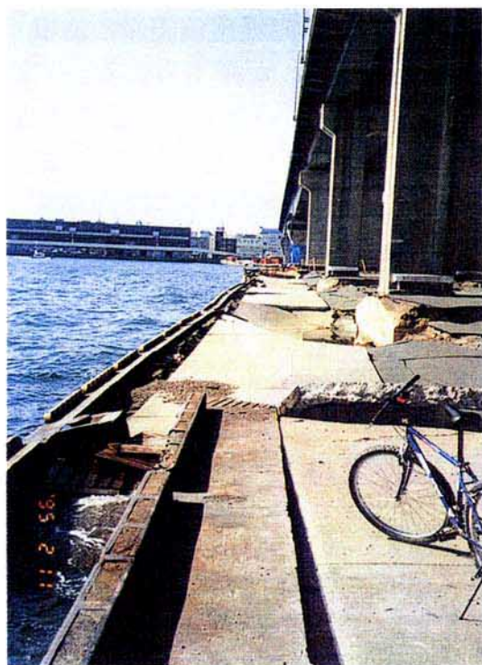
写真-12 突堤の南側護岸の崩壊
