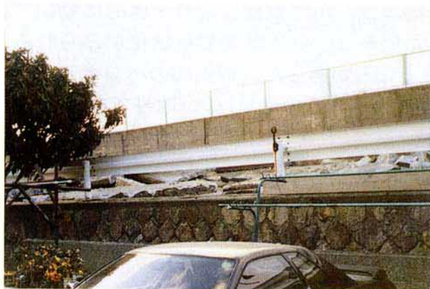
写真3 正蓮寺川(天端の破損)
