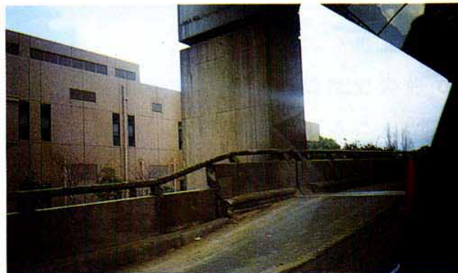
写真2 路面の波状変形（その1）
