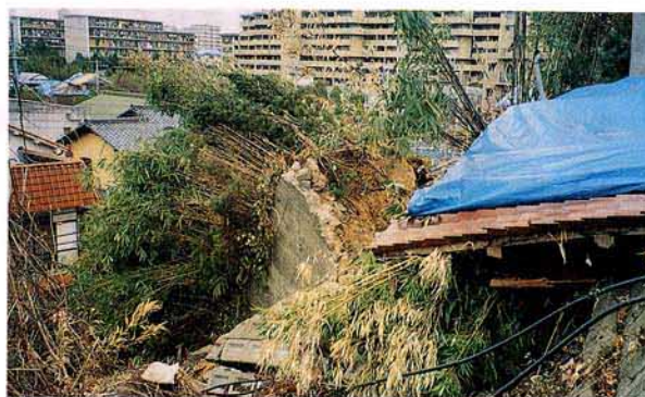
写真－６ コンクリート擁壁の転倒
