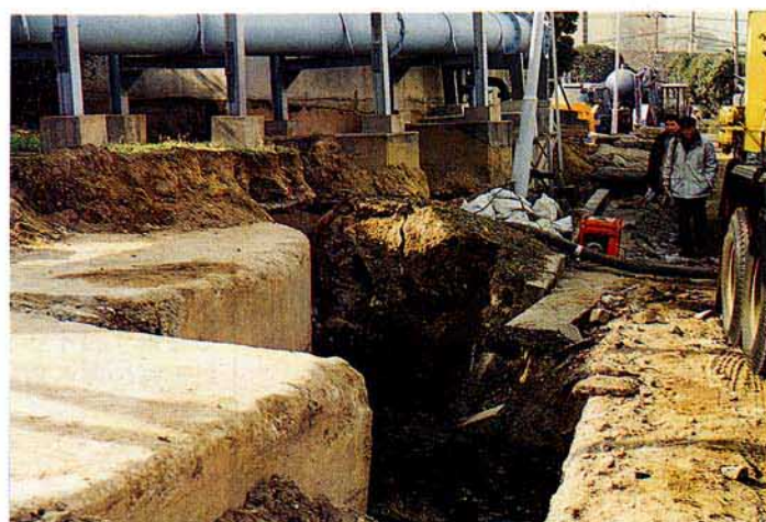
写真－4 東灘下水処理場の被災現場
