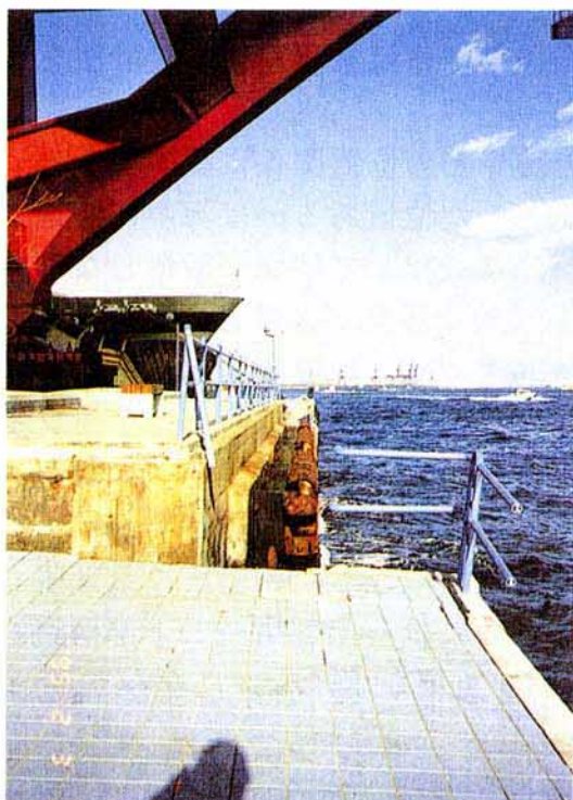
写真-9 突堤突端の護岸の変状
