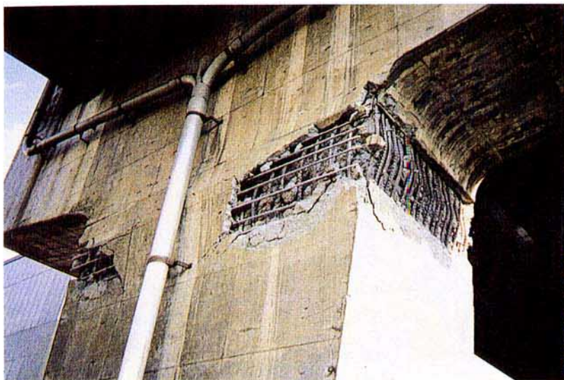
H 3 曲げ降伏後の鉄筋の局部座屈
