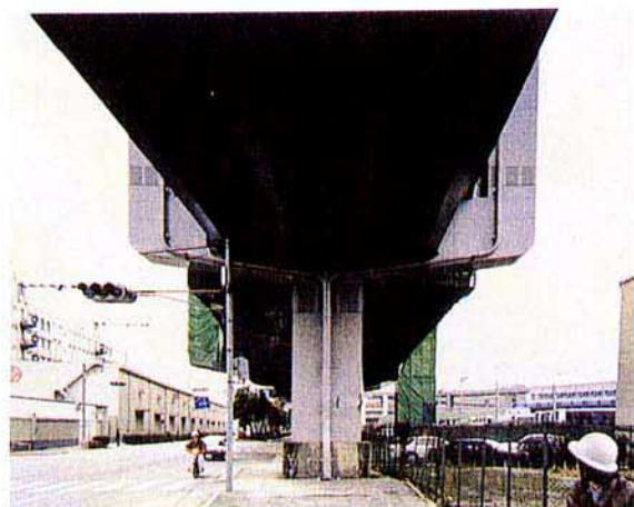
H 5 局部座屈の認められた鋼橋脚
