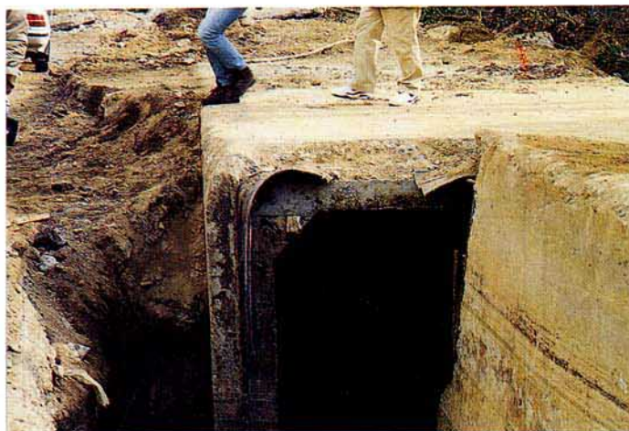
写真－2 東灘下水処理場の被災現場
