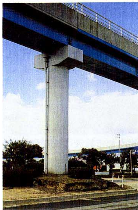
写真-2 基礎の浮き上がり
