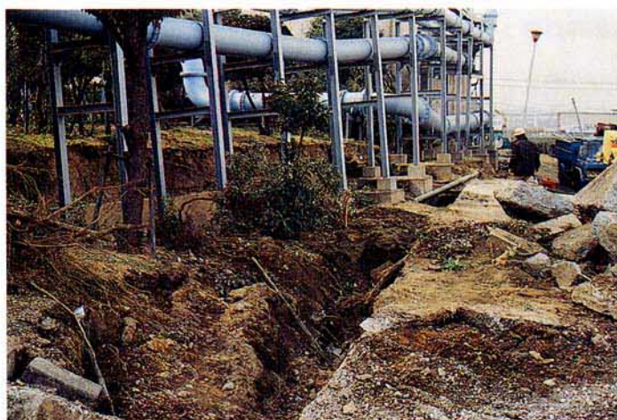
写真－5 東灘下水処理場の被災現場
