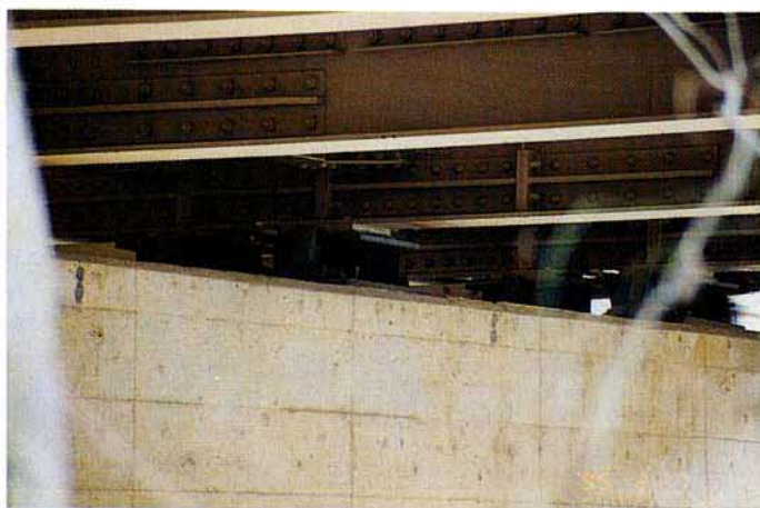
写真 17 生瀬高架橋の免震支承
