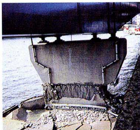
H 1 4 水平打継目と鉄筋破断
