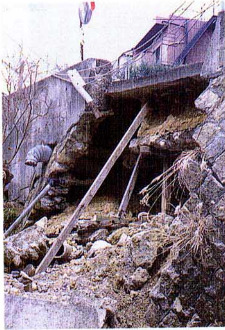
写真-4 岡本六丁目盛土崩壊
