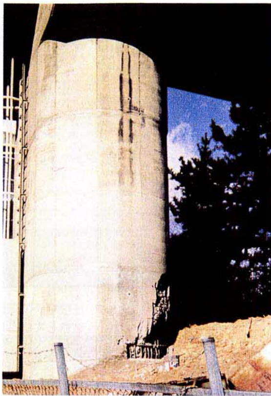
S 1 1 橋脚下端の曲げ降伏
