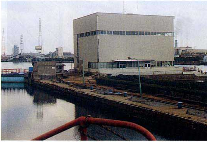
写真-1 尼崎閘門構造物付近の液状化
