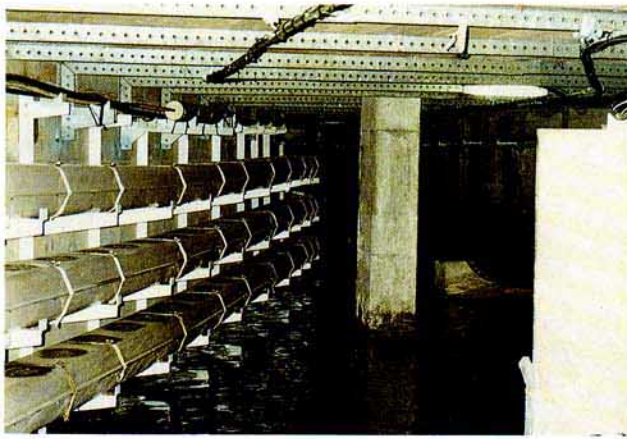
写真-5 共同溝湧水による浸水状況
