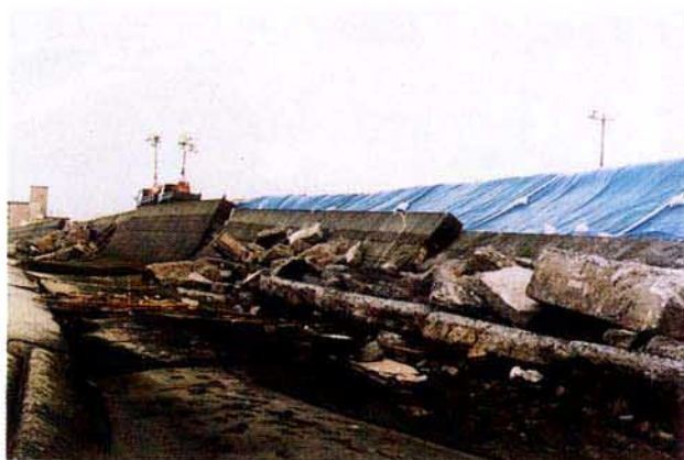
(a) 特殊堤の崩壊
