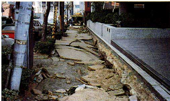
写真6 歩道舗装の破損（その1）
