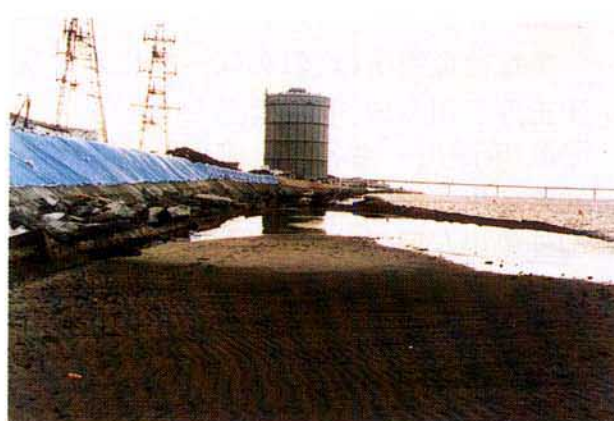
(d) 堤体内からの土砂の流出
