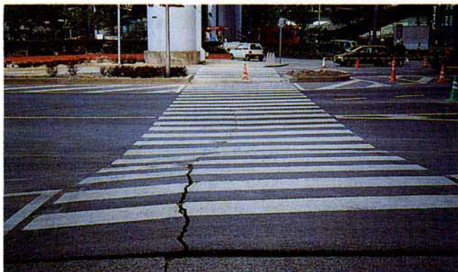
写真5 交差点周辺のひびわれ（その2）
