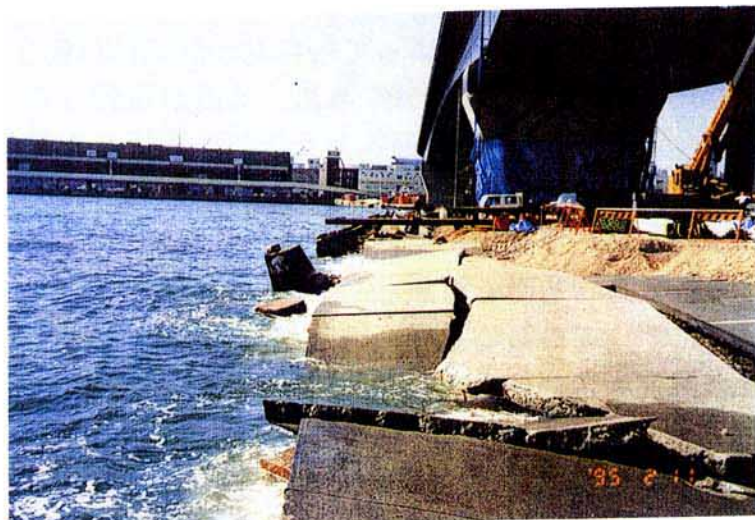
写真-13 突堤の護岸の崩壊
