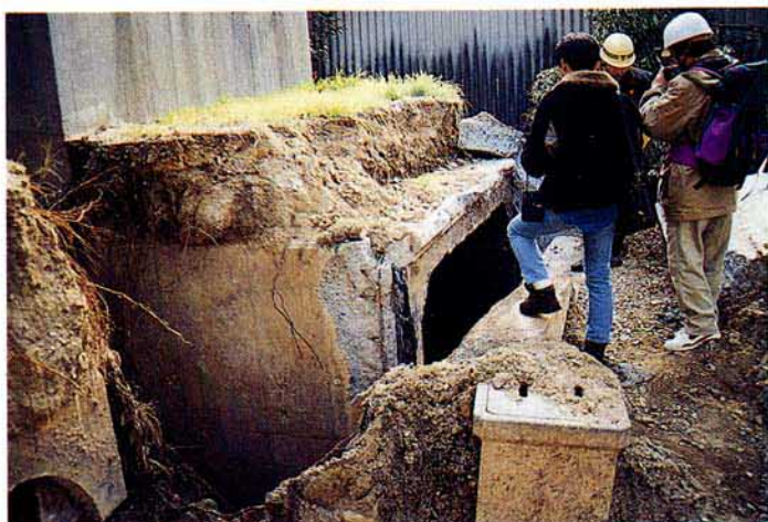
写真－3 東灘下水処理場の被災現場
