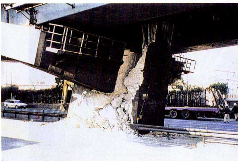
K 7 単柱式矩形橋脚の崩壊
