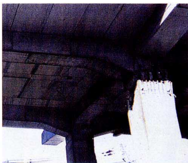
S 5 曲げ降伏後のせん断ひびわれ
