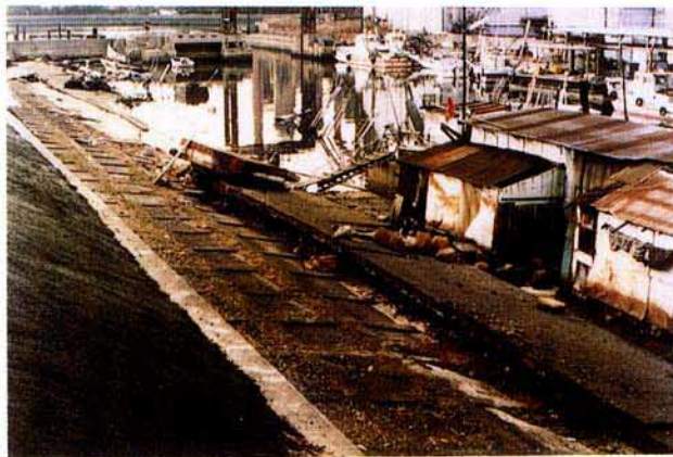
(a) 裏のりの崩壊(滑り)
