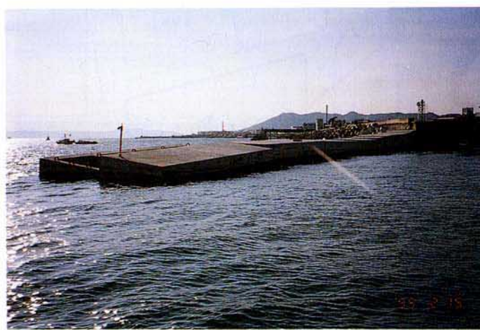
写真-10 長田港防波堤の傾斜・沈下
