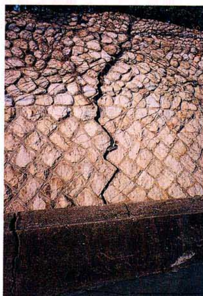
写真－４ 石積み擁壁の縦方向亀裂
