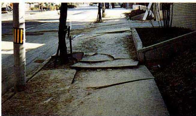
写真7 歩道舗装の破損（その2）
