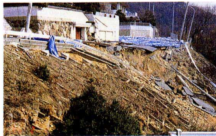
写真-6 西岡本七丁目の斜面崩壊状況
