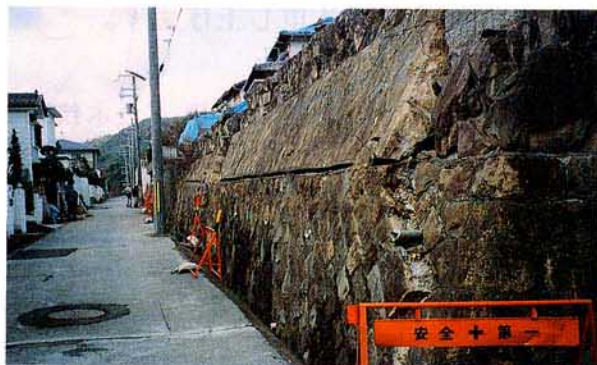
写真－５ 二段積み擁壁のはらみ
