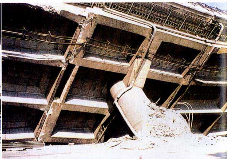
K 8 ピルツ橋脚の倒壊
