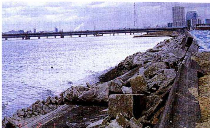
写真-11 淀川堤防の被災状況
