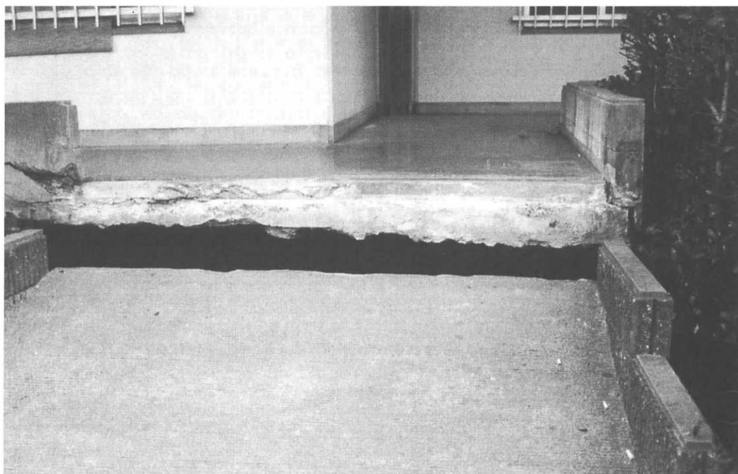
地盤沈下で通路に段差ができた
