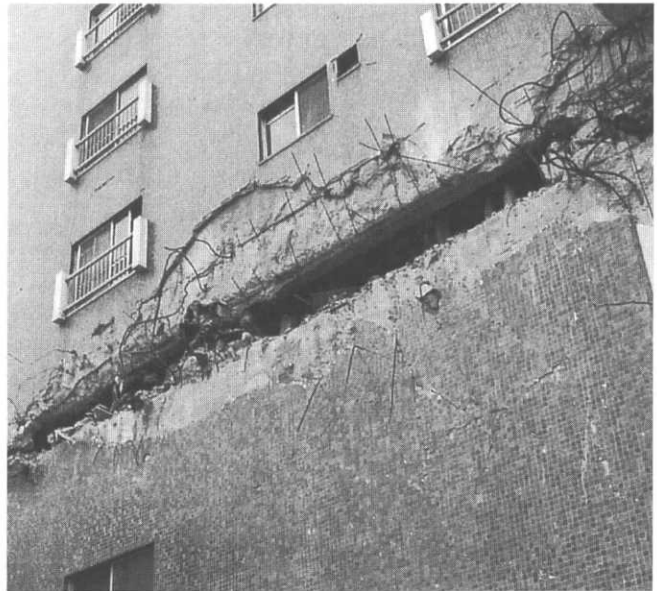
中間階が圧壊した
