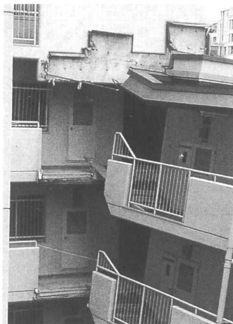
エキスパンション・ジョイントの部分で離脱している
