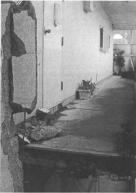
廊下が崩落してなくなっている
