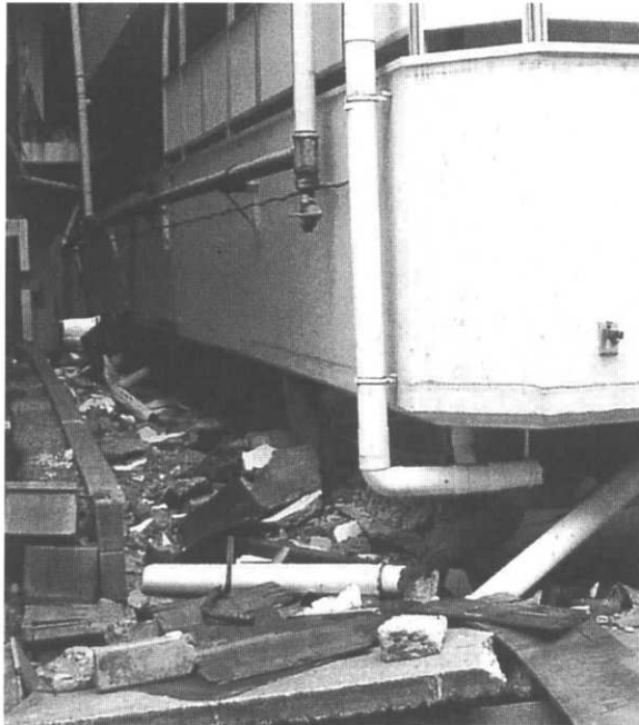
1階のピロティ部分が圧壊してなくなってしまった
