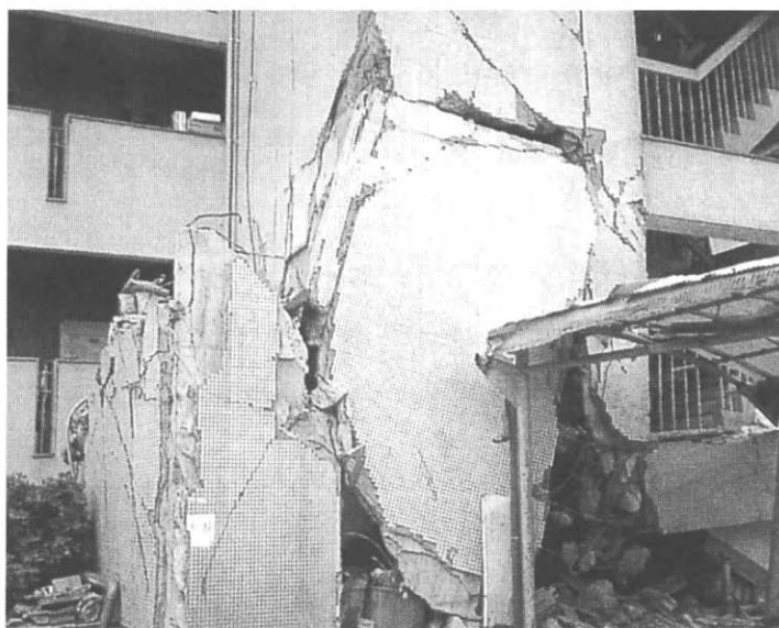
外部階段が崩壊した
