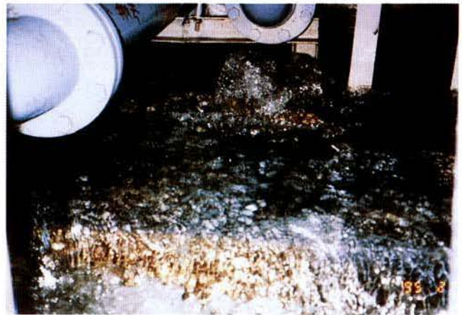
写真28 東灘処理場配管廊の漏水
