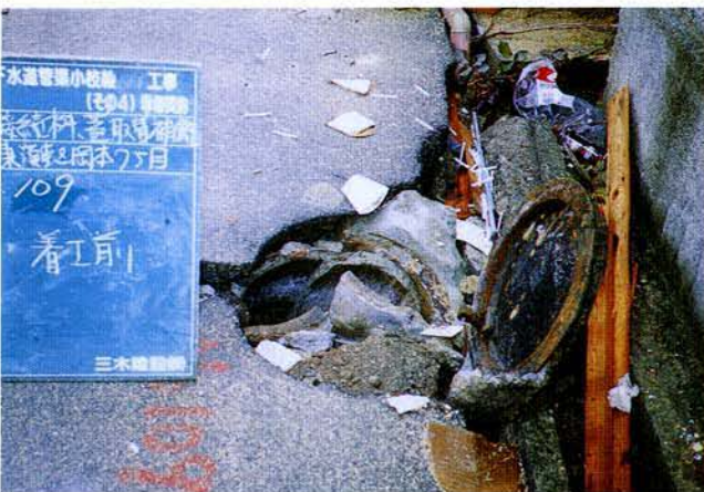
写真76 接続ますの損壊（東灘区）
