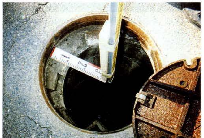
写真60 マンホール蓋のずれ
