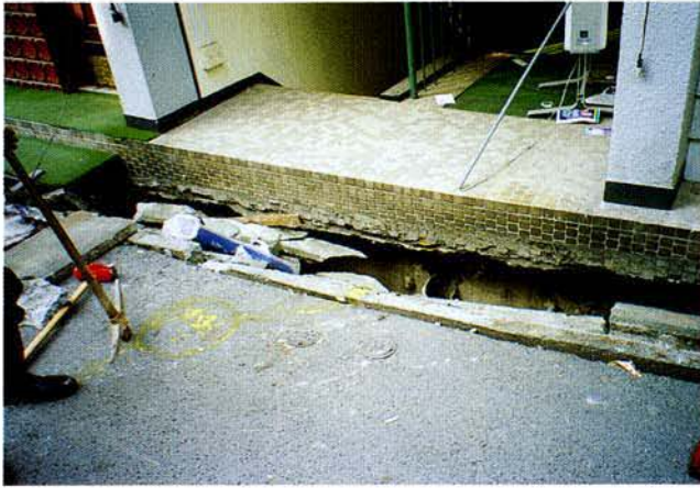
写真74 取付管の被災状況（東灘区）
