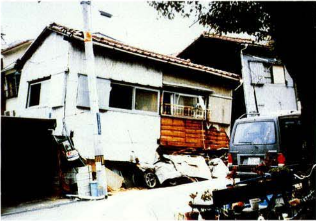
写真2 木造家屋の倒壊状況
