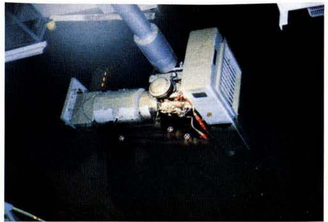
写真42 ポートアイランド第3ポンプ場自家発電機の水没
