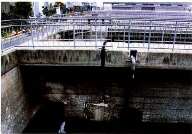
写真25 東灘処理場エアレーションタンクジョイントの目開き
