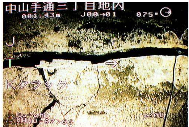
写真52 汚水枝線の円周亀裂の拡大写真
