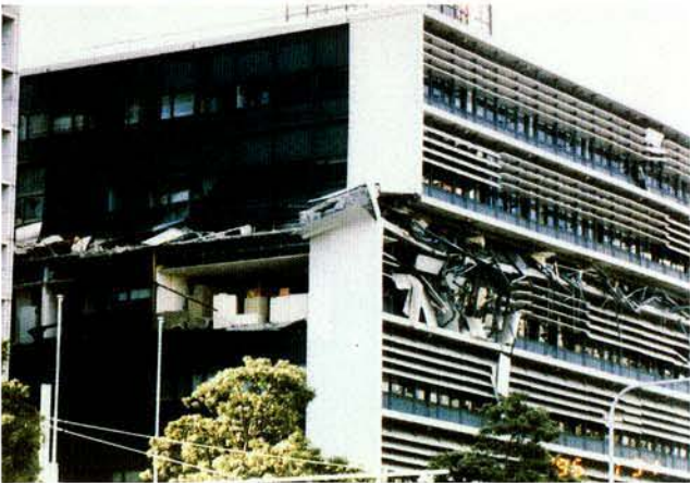
写真3 神戸市役所2号館6階の倒壊状況 下水道局は5階
