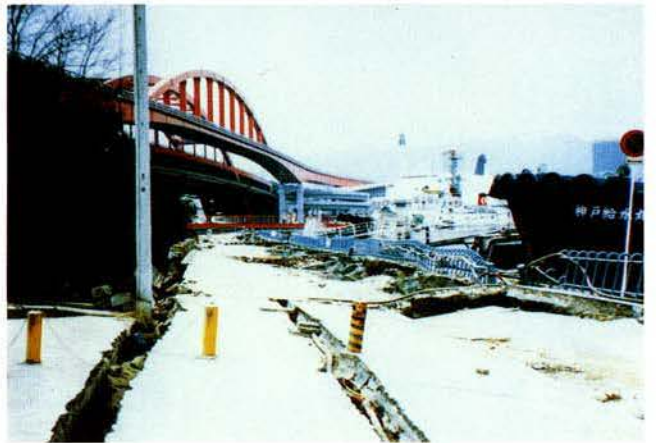
写真8 神戸港の護岸の破壊状況
