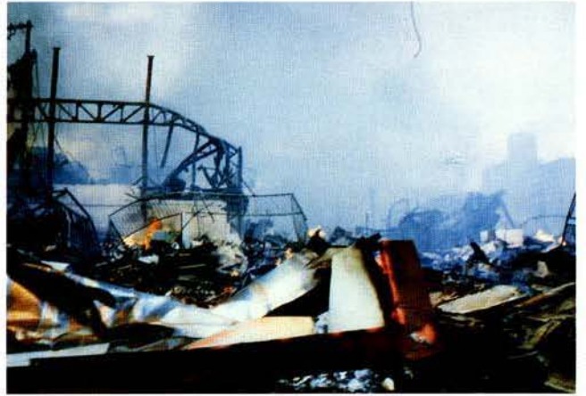
写真6 火災現場の状況
