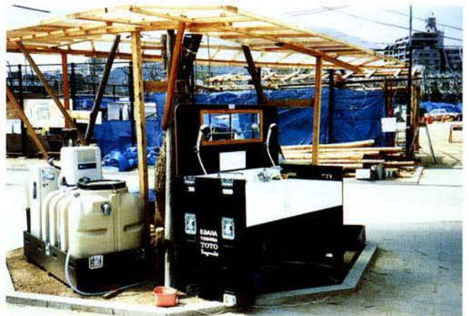
写真15 避難所の洗面施設
