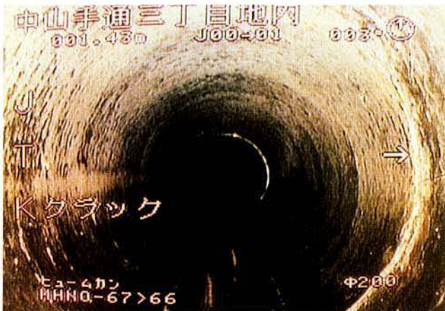
写真51 汚水枝線の円周亀裂
