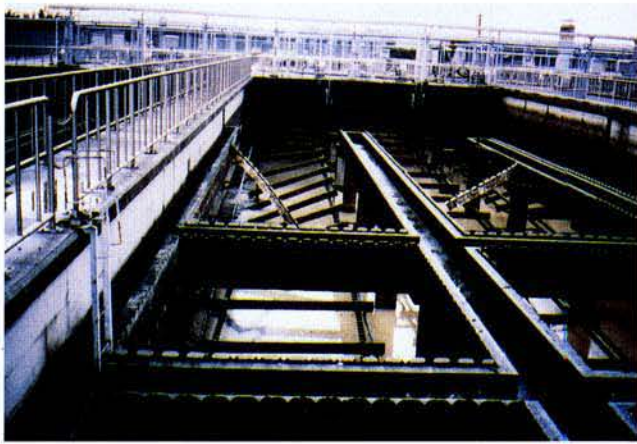
写真38 西部処理場最終沈殿池の破壊
