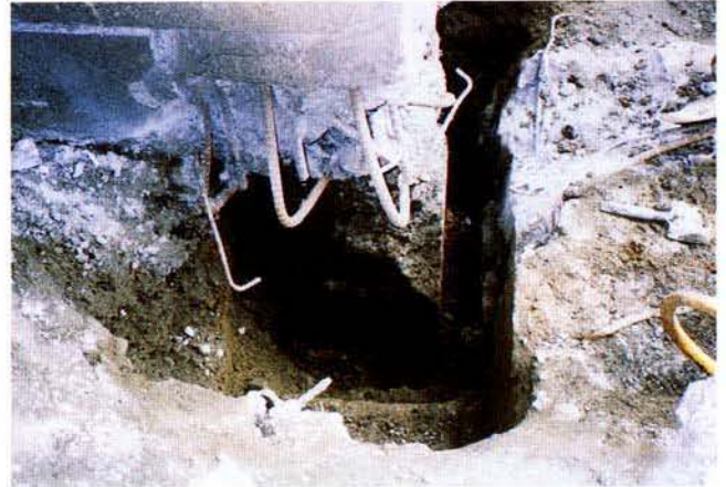
写真36 西部処理場給泥ポンプ室基礎の破壊
