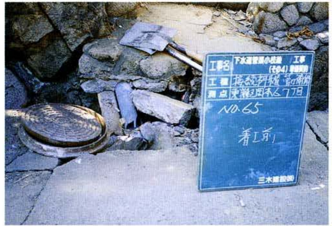
写真78 排水管と接続ますの損傷（東灘区）
