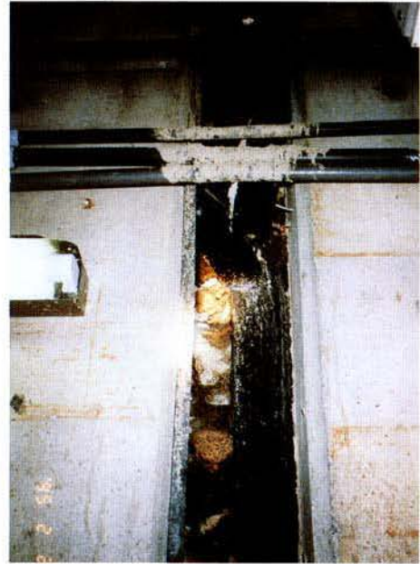
写真27 東灘処理場配管廊ジョイントの目開き
