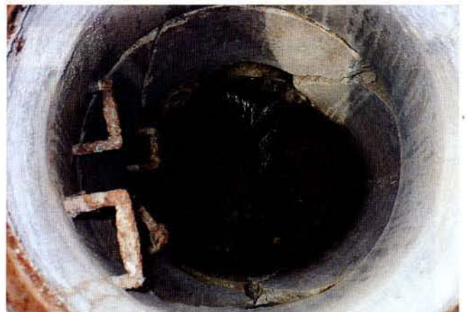
写真59 汚水マンホールの損壊
