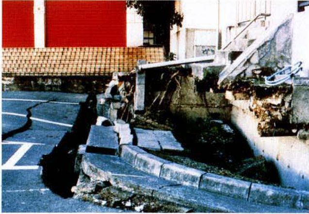
写真24 東灘処理場管理本館入口の段差
