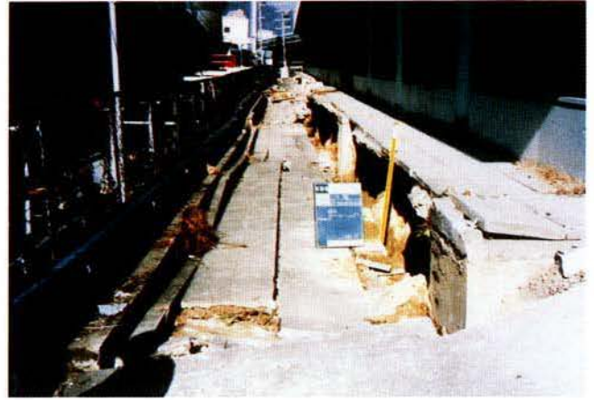
写真34 西部処理場の地盤沈下
