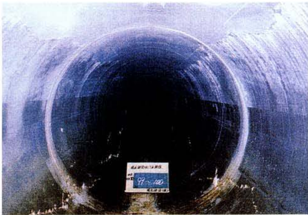
写真61 鳴尾御影污水幹線シールド二次覆工コンクリートの縦断亀裂
