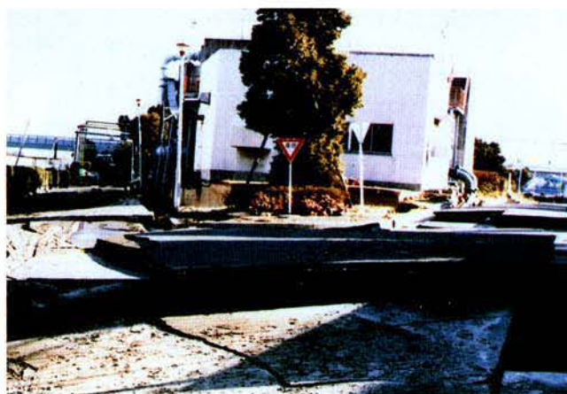
写真19 東灘処理場の地盤沈下と道路の破壊
