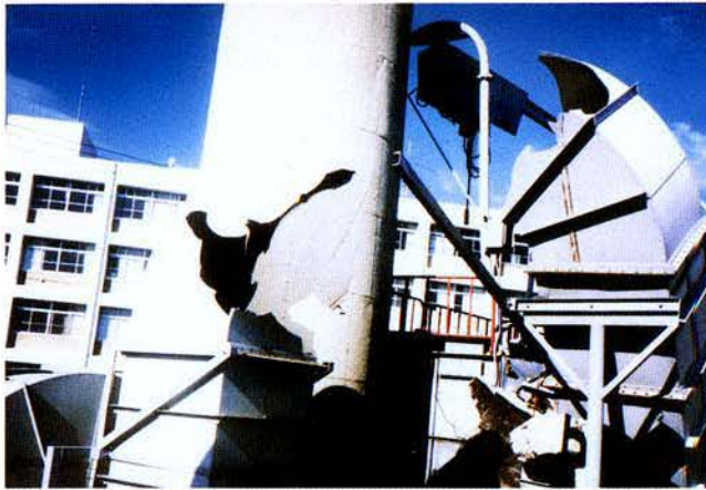
写真30 中部処理場脱臭ダクトの破壊
