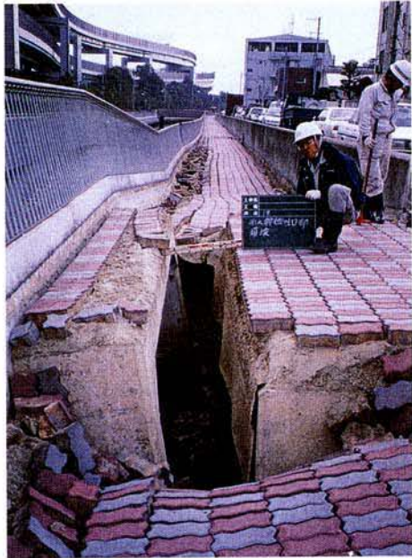
写真67 新在家雨水幹線、運河護岸の側方流動によるボックスカルバートの破損
