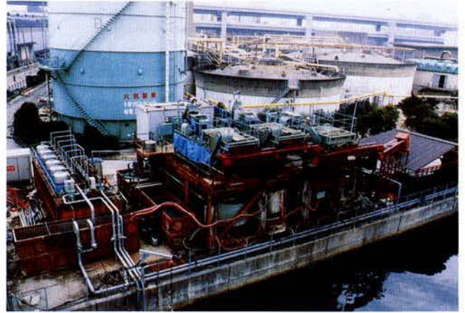
写真48 東灘処理場仮処理施設の汚泥脱水設備
