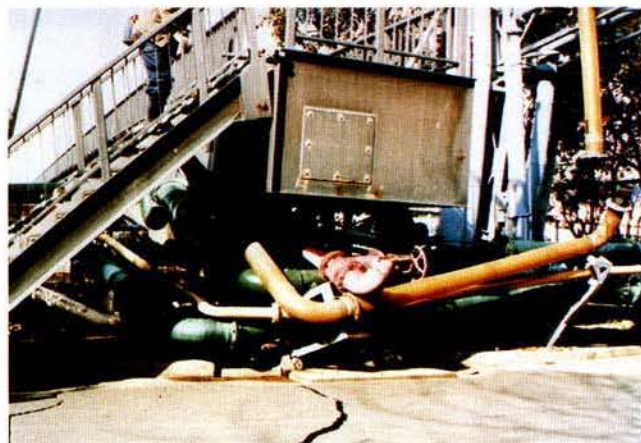
写真23 東灘処理場配管群の変形
