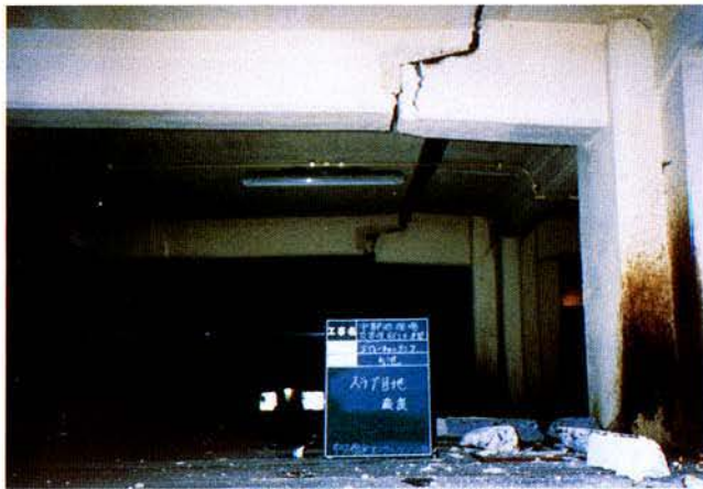
写真31 中部処理場エアレーションタンク上屋の破壊
