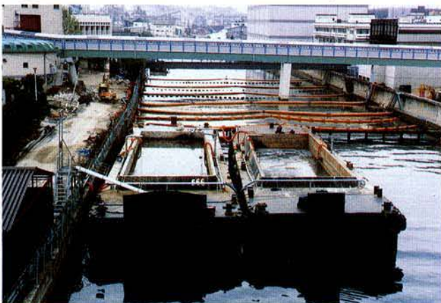
写真47 東灘処理場仮処理施設の台船を用いた汚泥濃縮槽
