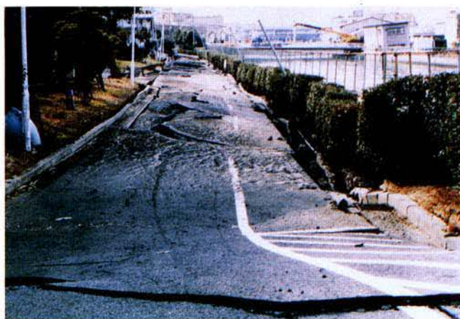
写真18 東灘処理場護岸の滑動による地盤沈下
