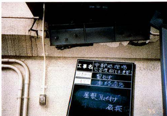
写真33 中部処理場連絡通路取付け部の破壊
