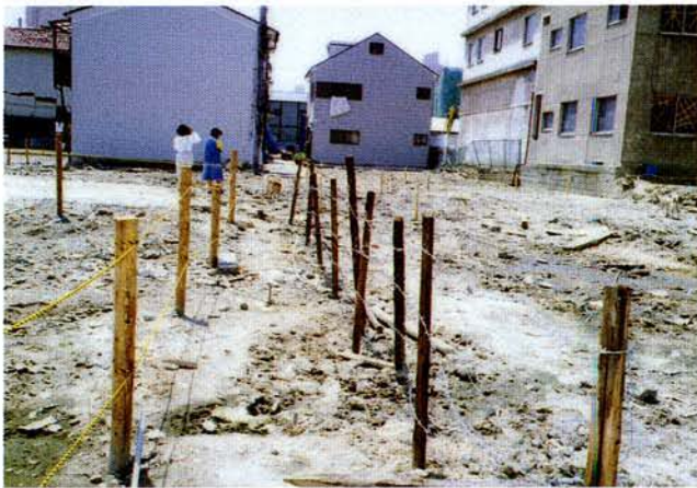
写真75 共同排水管の被災状況（兵庫区）
