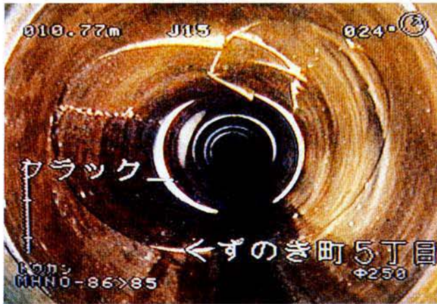
写真55 汚水枝線陶管の破壊
