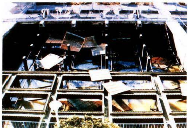
写真29 東灘処理場最終沈殿池の破壊
