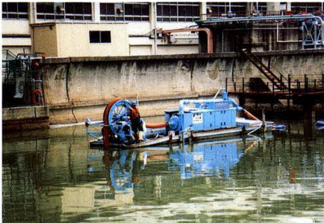
写真46 東灘処理場仮処理施設の汚泥浚渫船
