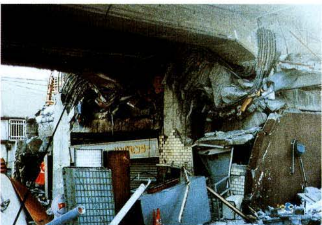
写真12 阪神電車高架橋の破壊状況
