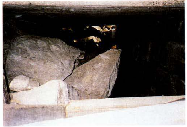
写真70 神前雨水幹線石積側壁の崩壊
