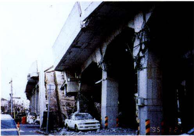
写真10 JR線の高架橋の倒壊状況
