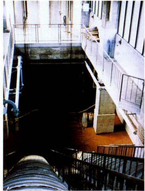
写真41 ポートアイランド第1ポンプ場の泥水流入
