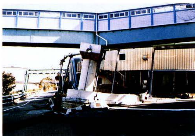
写真21 東灘処理場連絡橋基礎の傾斜
