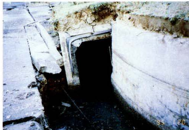
写真20 東灘処理場流入水路の破壊
