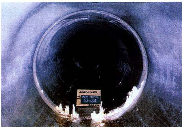
写真62 鳴尾御影污水幹線シールド二次覆工コンクリートの円周亀裂
