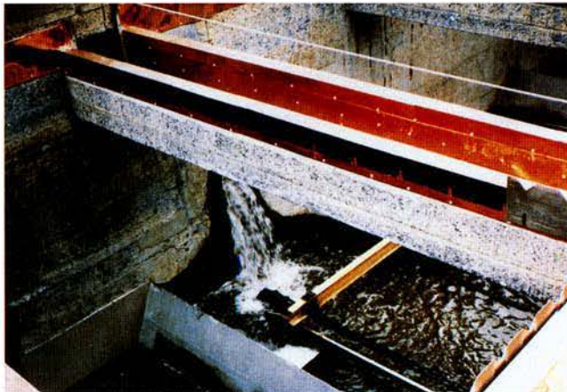
写真32 中部処理場最終沈殿池の漏水
