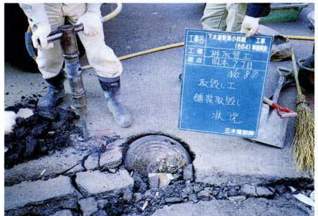
写真79 接続ます取付管の損壊（東灘区）
