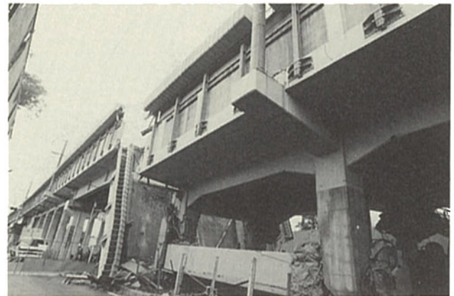
新幹線けた落下箇所
