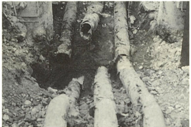
護岸の移動で切断された配管
