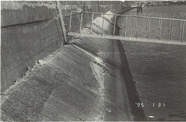
中島川右岸防潮堤の被害
