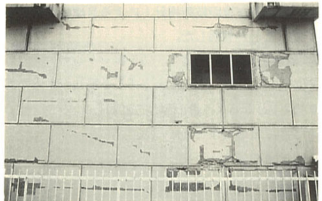
中館外壁のタイルはく離
