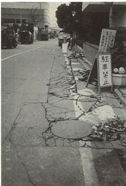
構内道路の被害
