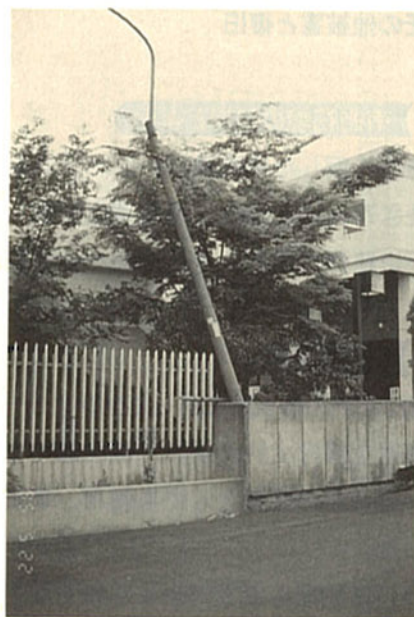
構内柱の破損状況
