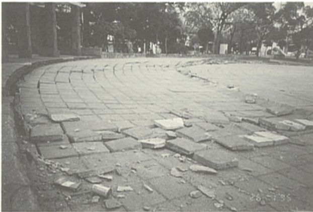
公園内の舗装も破損
