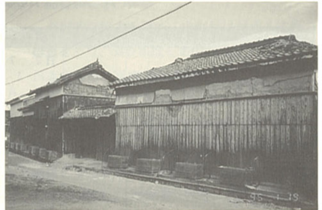
形成建築物の被害
