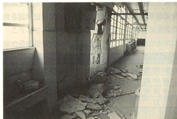
城内小学校の被害
