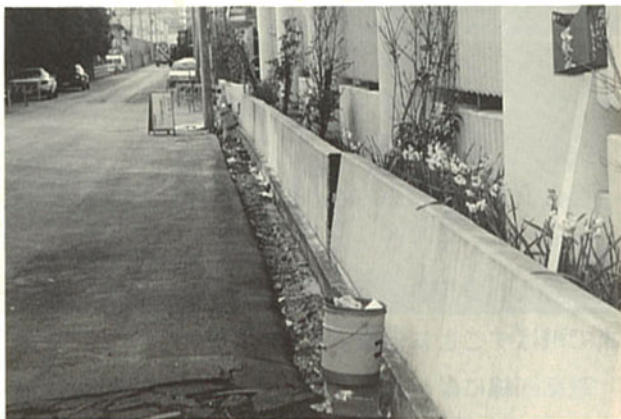
南側花壇の破損状況
