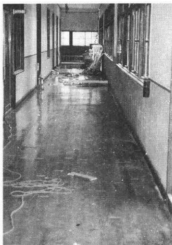
図版Ⅰ 廊下の隙間▶
