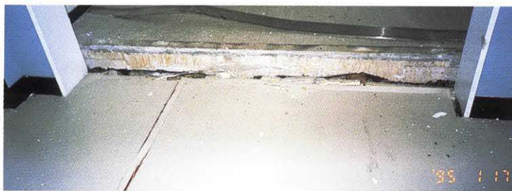
体育館と西校舎の接合部 (20 cm 段差)
