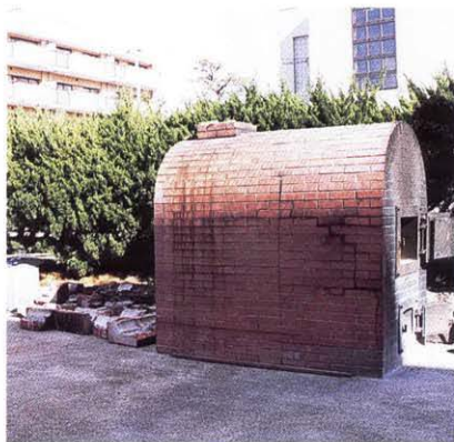
全壊した焼却炉
