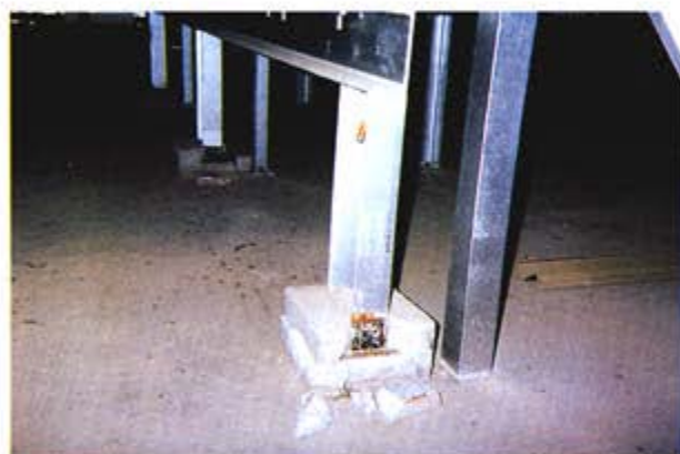
配管基礎亀裂
