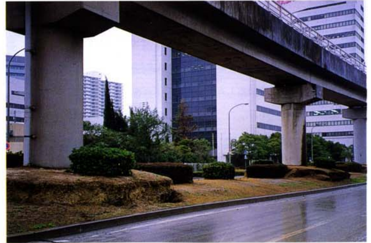
地盤沈下の状況（中央区港島）
