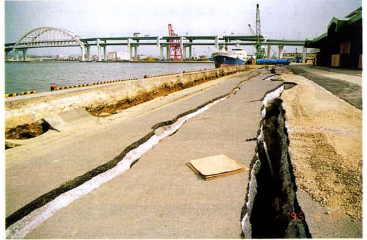
地割れを起こした岸壁（東灘区：六甲アイランド）
