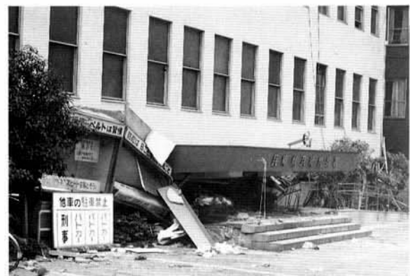
一階部分が崩壊した兵庫警察署
