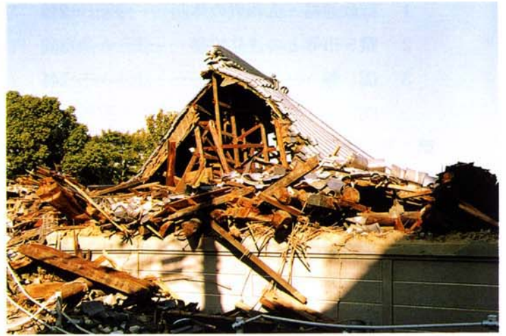
倒壊した寺（東灘区）
