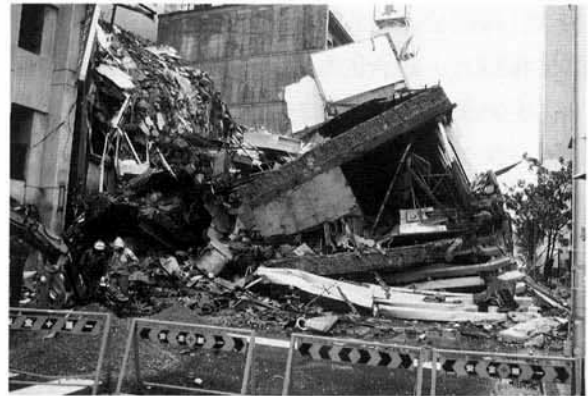
余震により倒壊したビル
