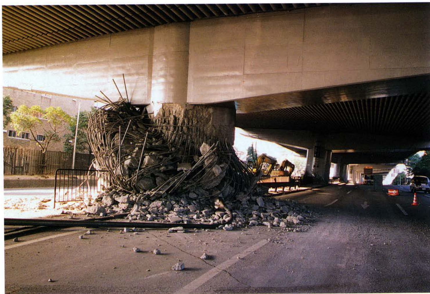
▲押しつぶされた阪神高速道路橋脚（東灘区）
