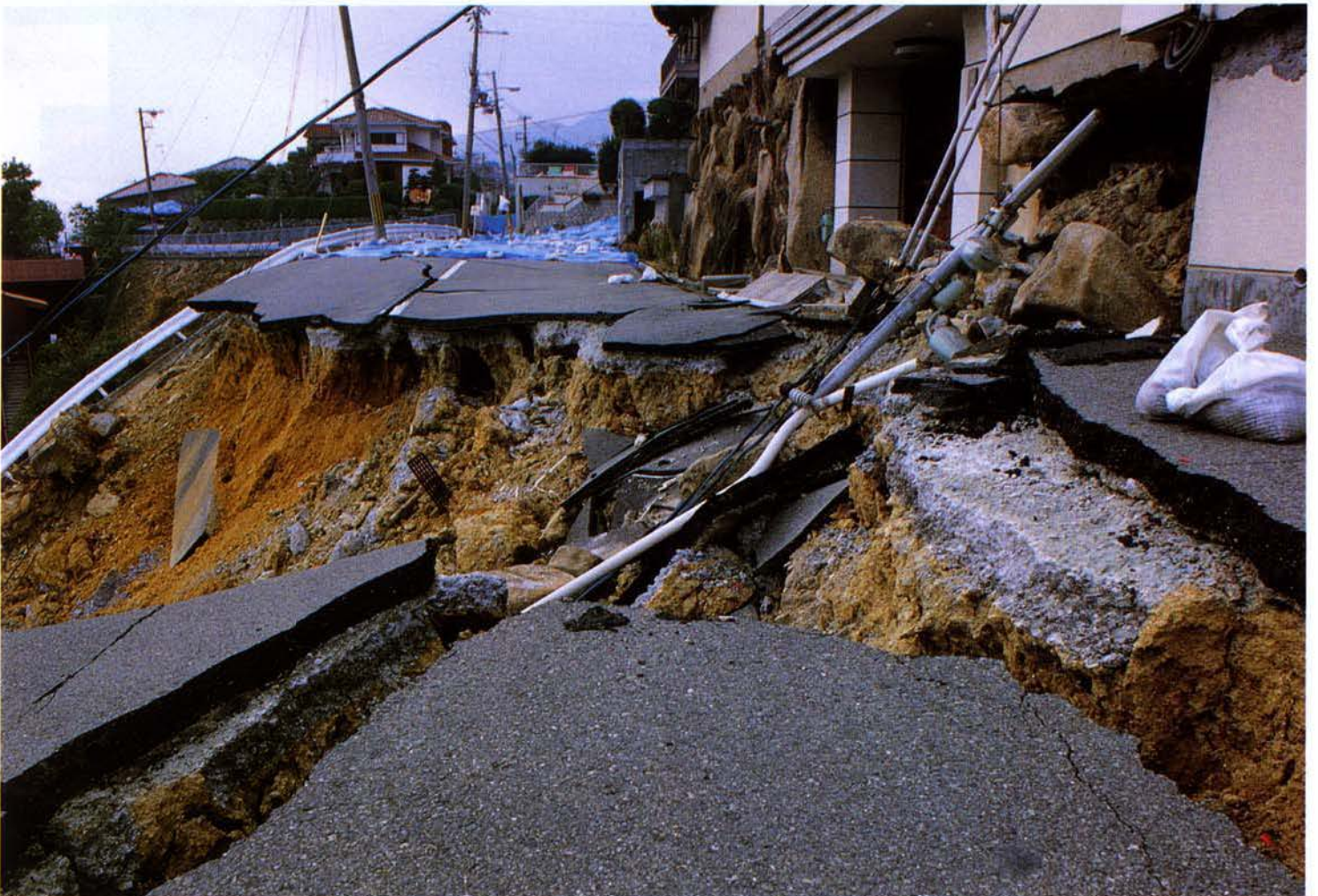
▲東灘区内の道路を寸断した崖崩れ
