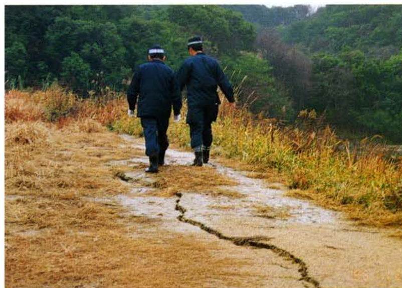
▲亀裂の入ったえん堤を点検する（一宮町）
