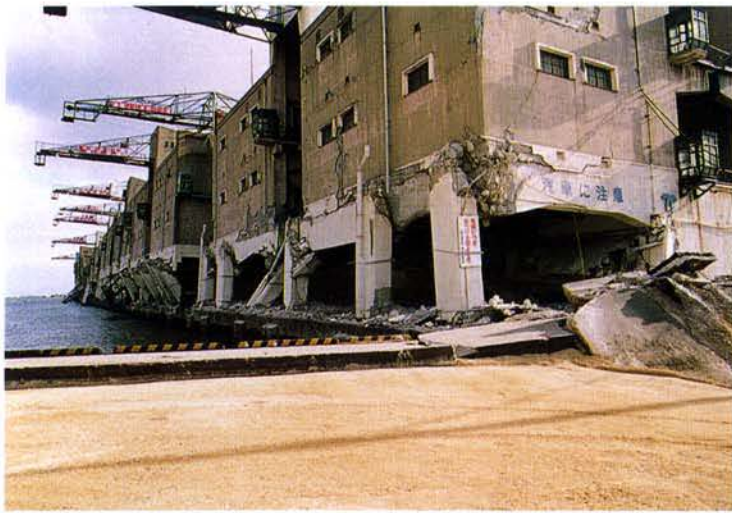
▲神戸港第七突堤の倉庫の被害
