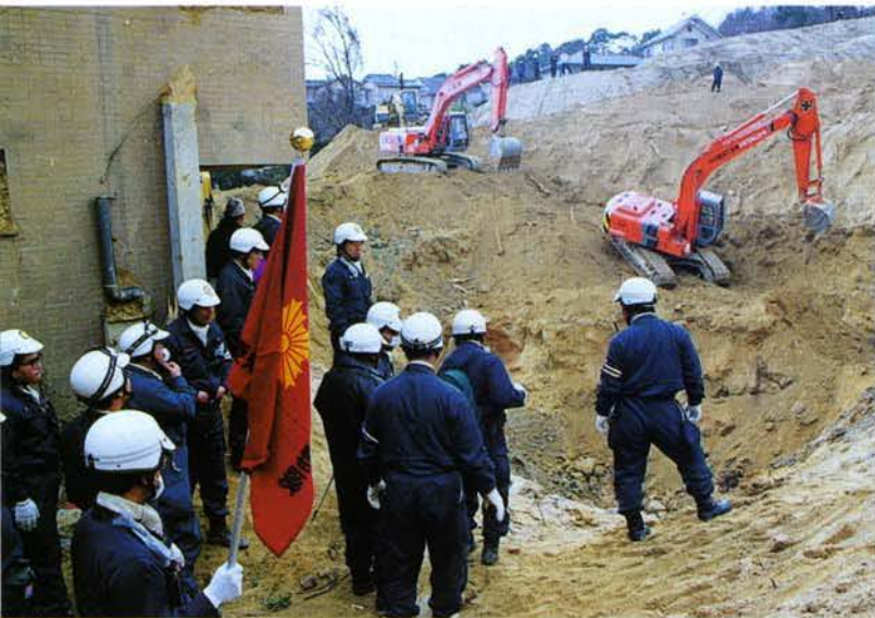
▲西宮市の崖崩れ現場で捜索にあたる愛知県警察機動隊員
