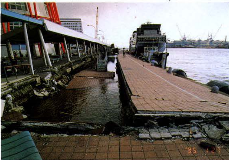
▲中突堤基部の割れた岸壁
