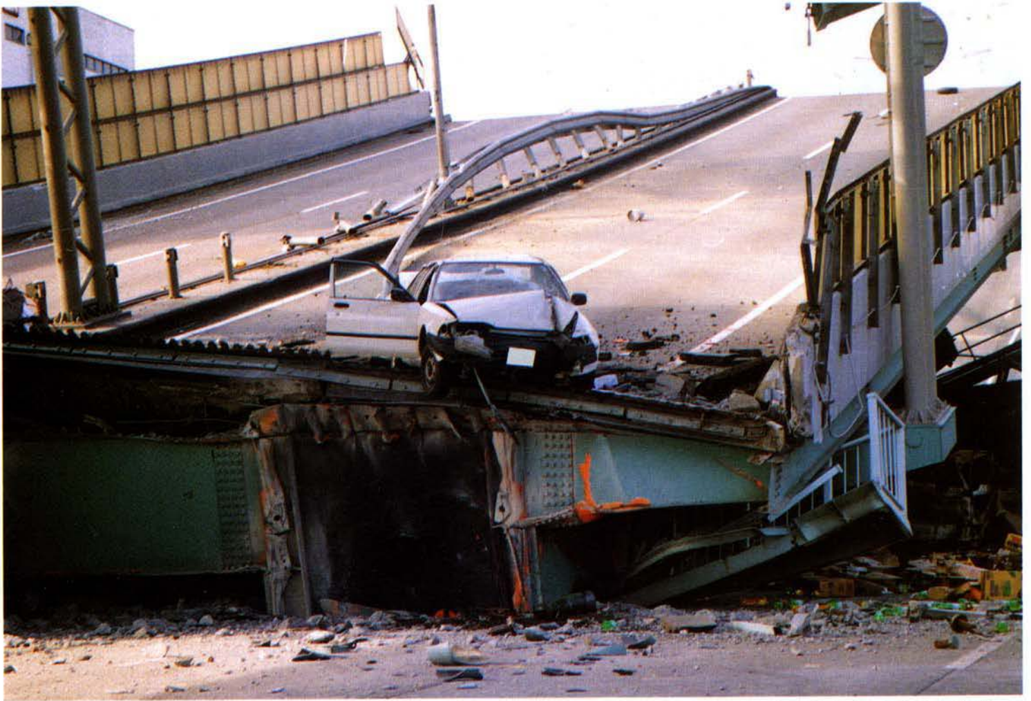
▲阪神高速道路を走行中地震にあった車両（西宮市）
