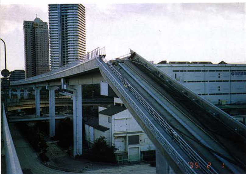
▲ 六甲ライナー高架の落下
