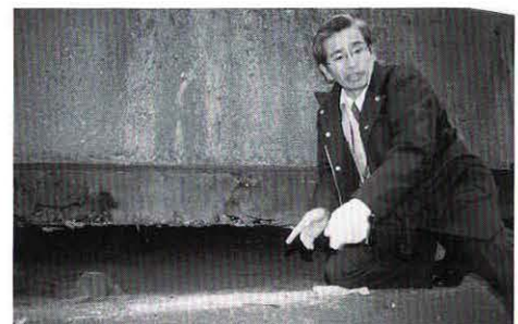
防潮堤(初島地区)にできた段差を調査する 神戸大学高田至郎教授
