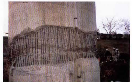
山陽新幹線の橋脚破損 / 常松1丁目
