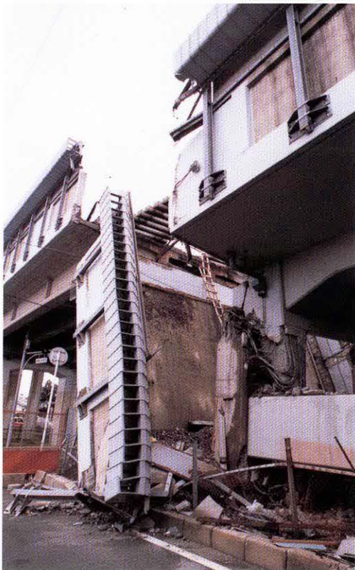
山陽新幹線高架落下 / 尼崎市下食満
