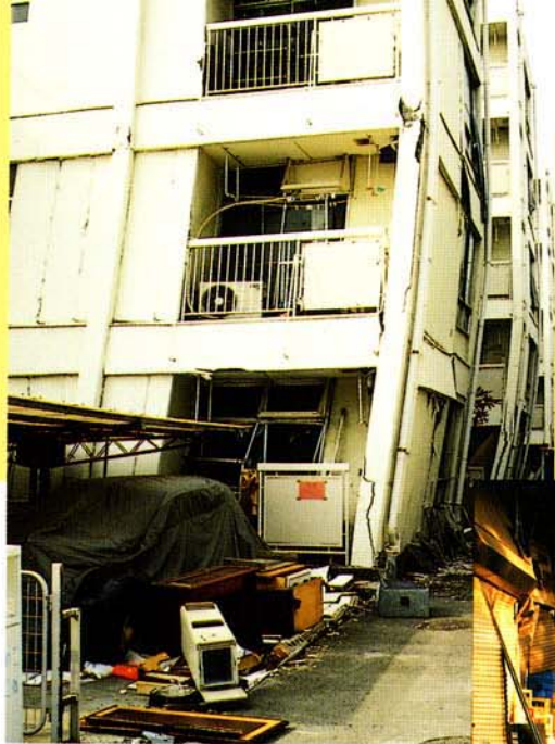
清水町付近の崩壊したマンション
