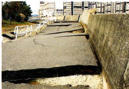
芦屋浜の海岸沿いの道路にも大きな亀裂が 入った
