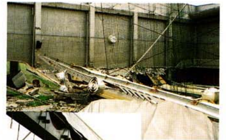
市立体育館 の競技場の 屋根が落下 した
