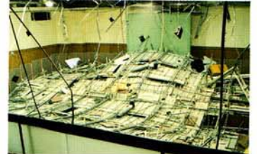
市役所南館は比較的軽微な損 壊であったが、3階の市議会 議場の天井が崩れ落ちた
