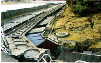
芦屋浜の防潮堤沿いの道路は 陥没した
