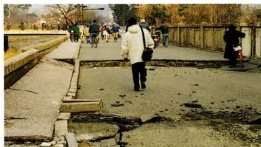
き裂が入ったり段差ができたりした道路 J R 芦屋川トンネル東側
