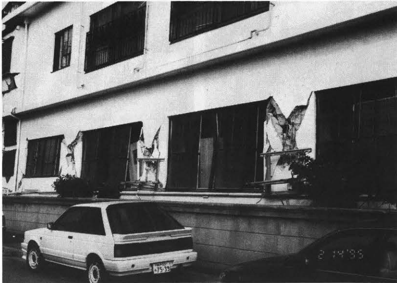
座屈した園舎
