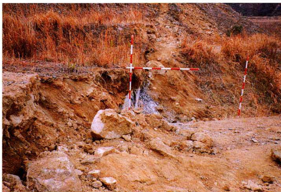
航空写真—1のA地点：道路に生じた段差（高さ130cm）
