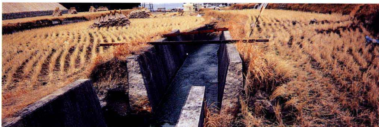
断層の運動によってずれた水路（北淡町梨本地区）
