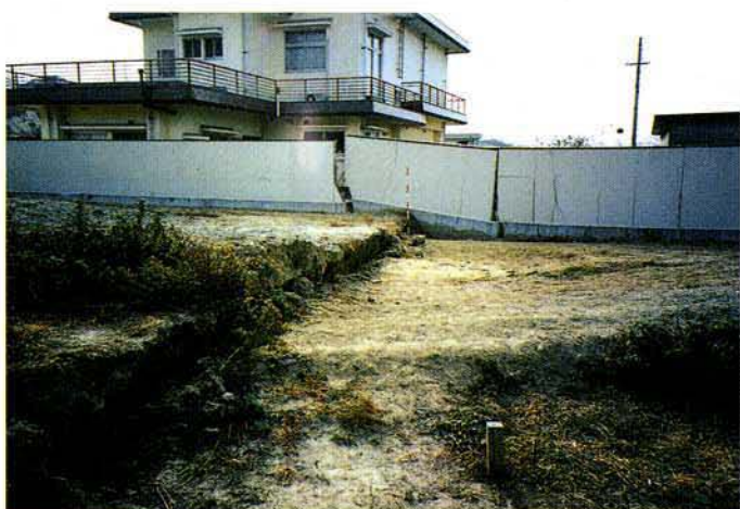
航空写真—2のC地点：敷地直下に断層面が出現した民家の塀のずれ
