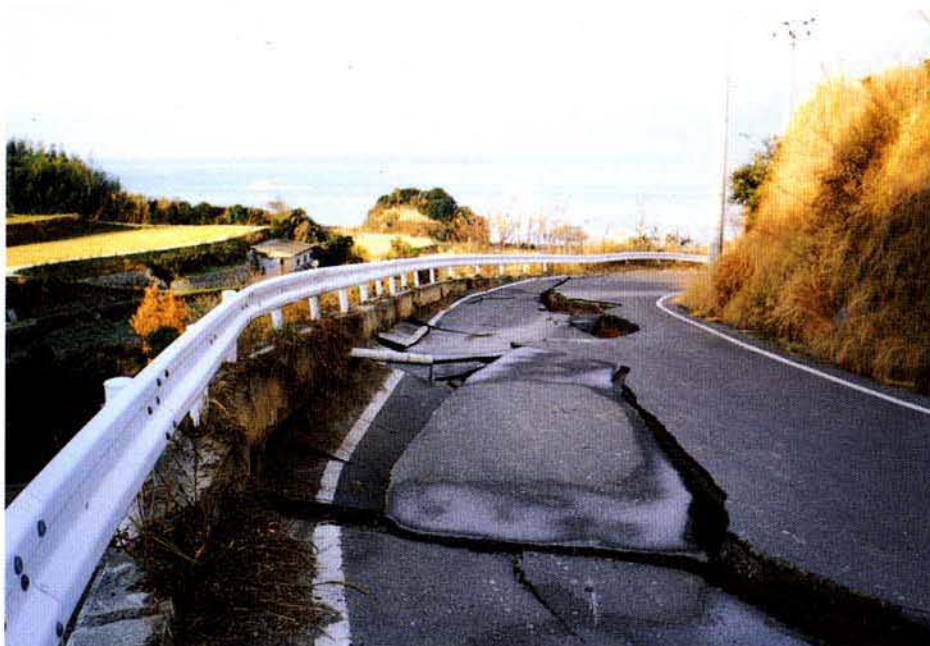
路面に発生した亀裂
