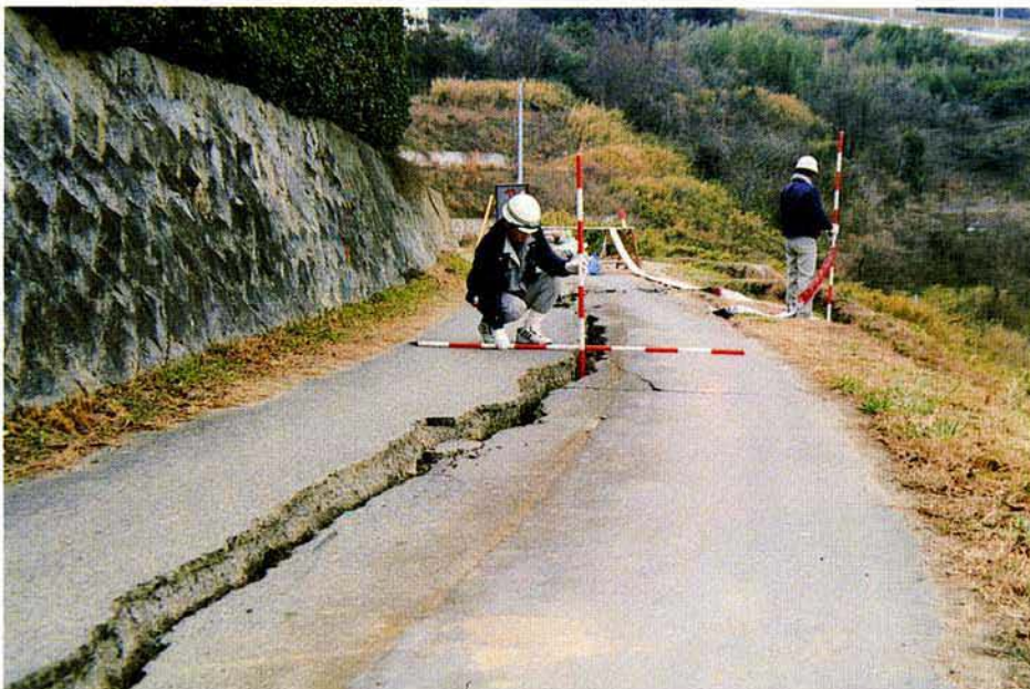
路面中央において縦断方向に大 きく亀裂が入った。
