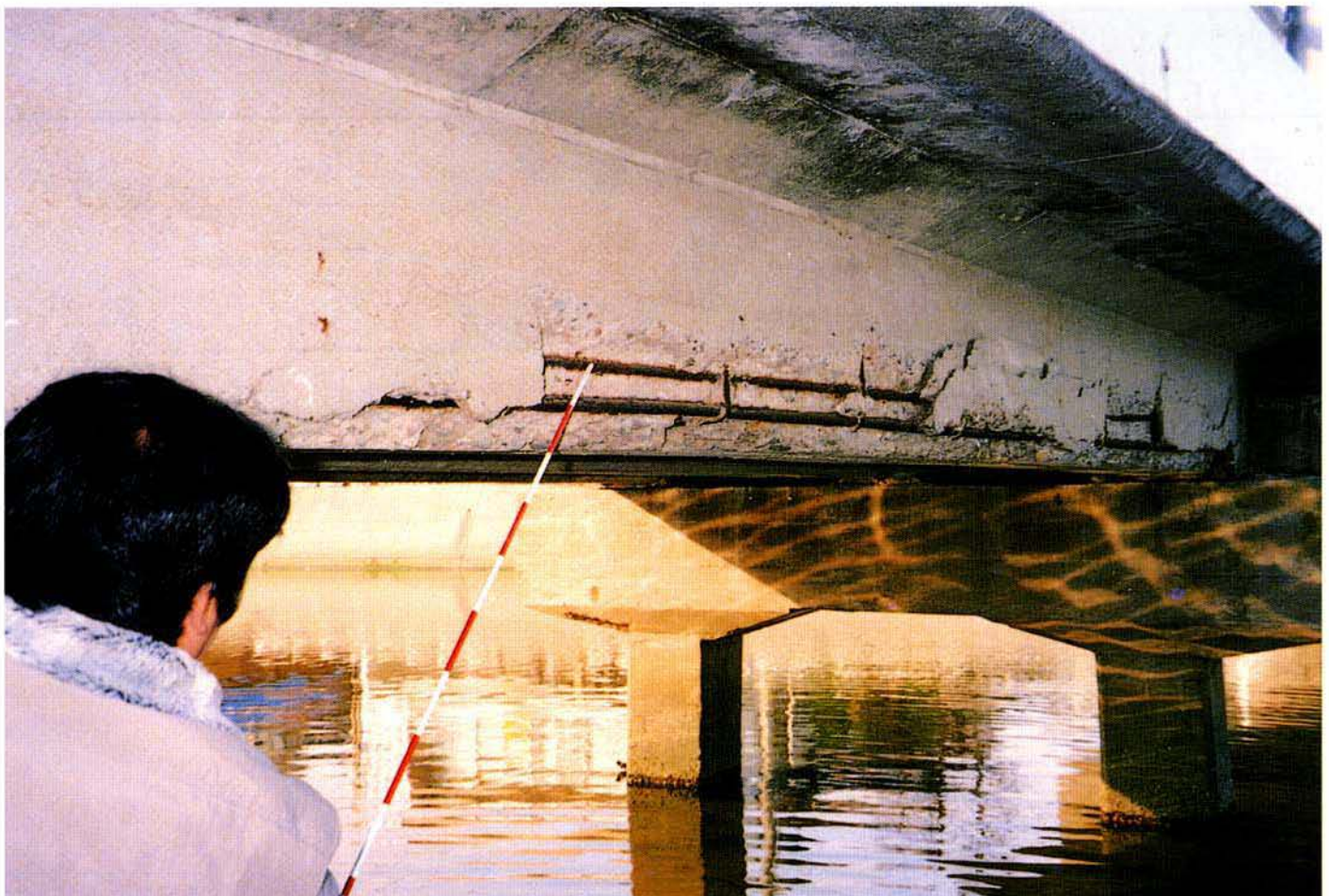
コンクリートの剥離により露出した鉄筋
