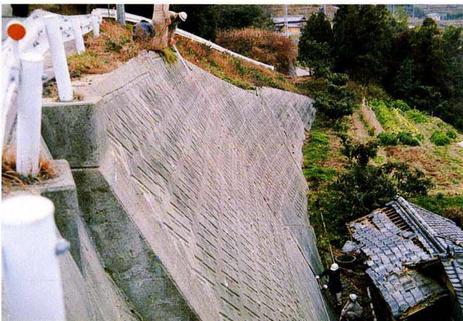
被害の調査状況 2
