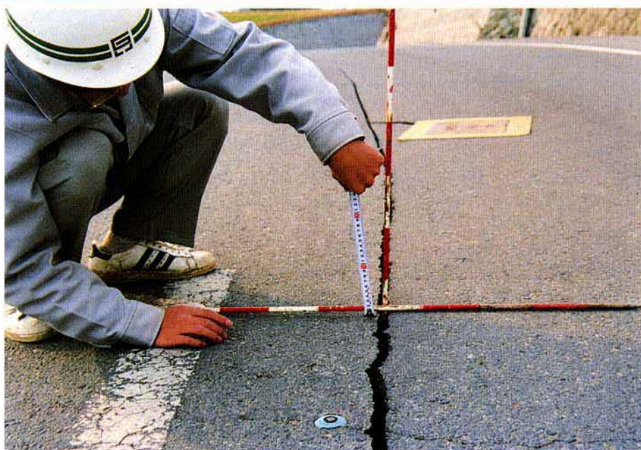
路面の亀裂の状況
