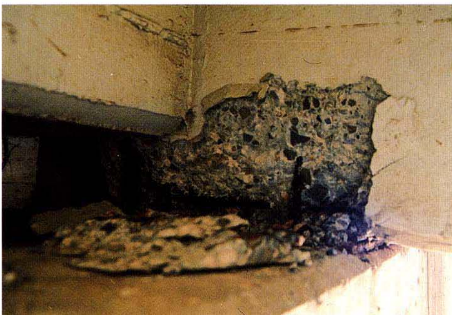
橋脚上の主桁端部のコンクリート剥離
