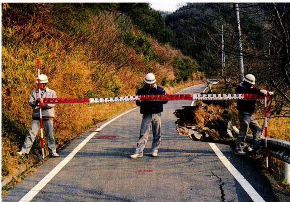
被害の調査状況
