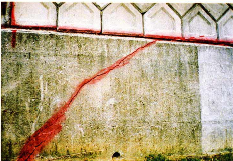
ブロック積基礎コンクリートの 亀裂
