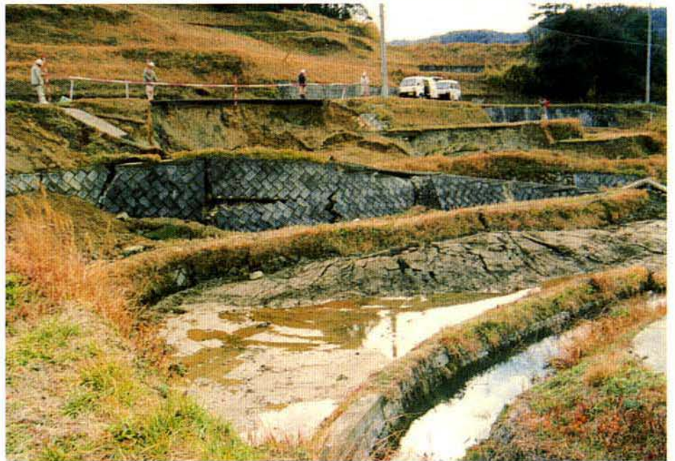
道路下部法 ブロック積の被害
