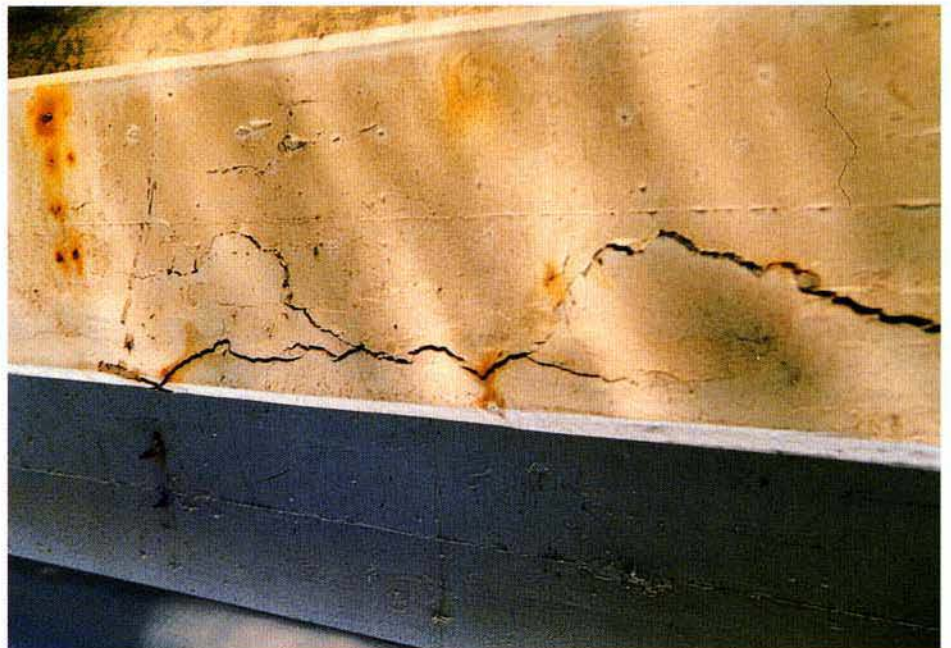
コンクリート製の主桁に無数のクラックが発生
