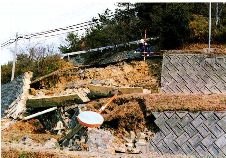
道路法面の崩壊
