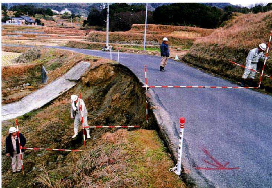
路肩のすべり
