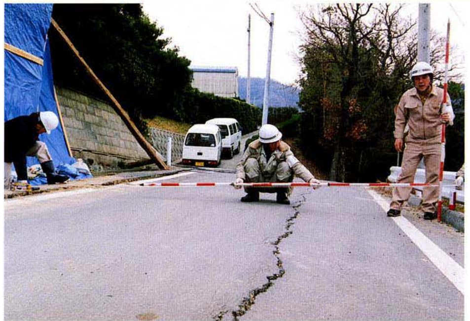
被害の調査状況 1
