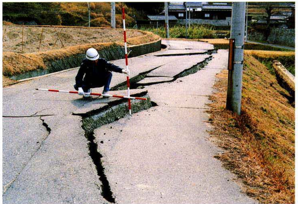
路面に発生した段差
