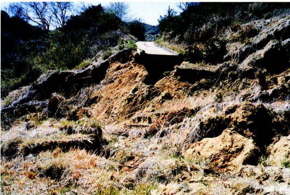
寸断された町道
