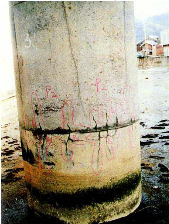
橋脚の中央部が座屈
