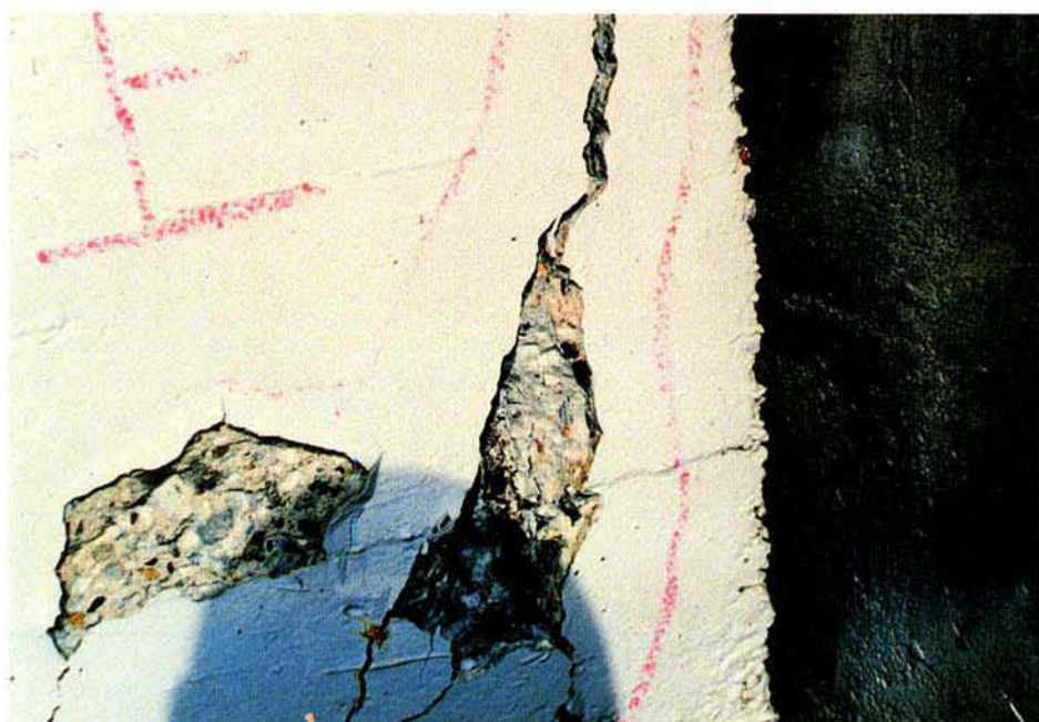
主桁端部の亀裂及び剥離状況
