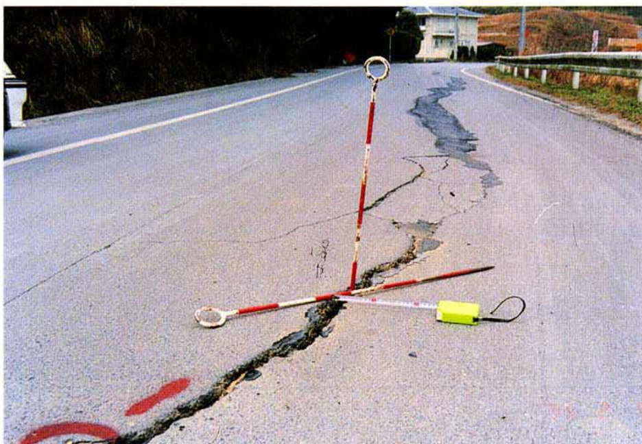
路面の亀裂の状況
