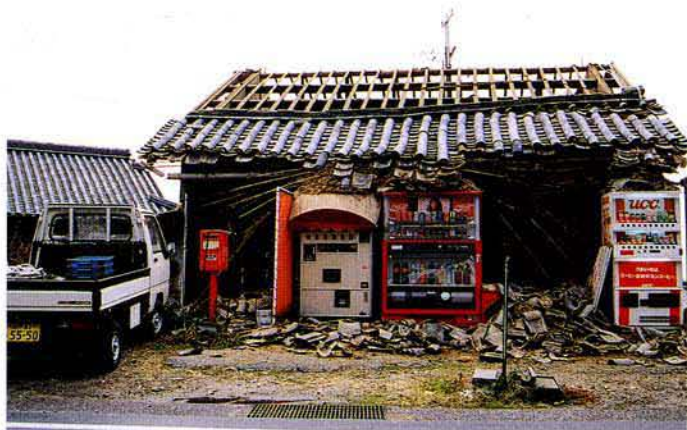
地震によって屋根瓦がずり落ちた民家
