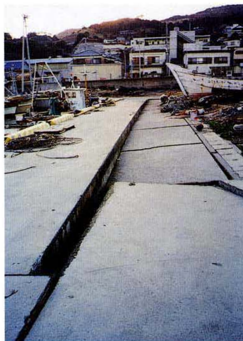
港湾建設の至る所でこのような被害がみられた。 (岩屋港長浜地区)
