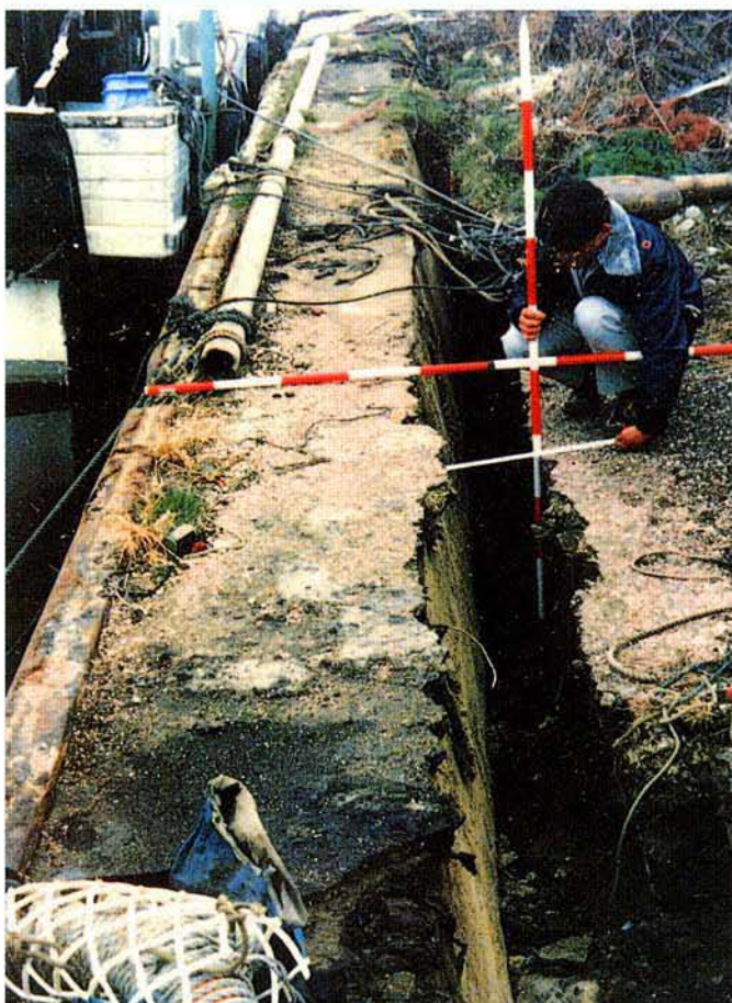
上部工、エプロン目地開き状況 (約 3 0 cm)
