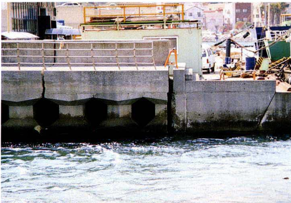
岩屋港 護岸（防波） 本体ケーソンの移動により隙間が 見られる。 手すりに引っ張られた形跡が見ら れる。
