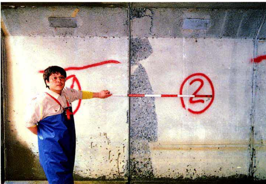
ボックスカルバートのコンクリ ートの剥離状況
