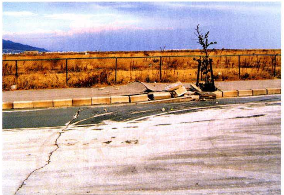
歩道表層部の隆起状況
