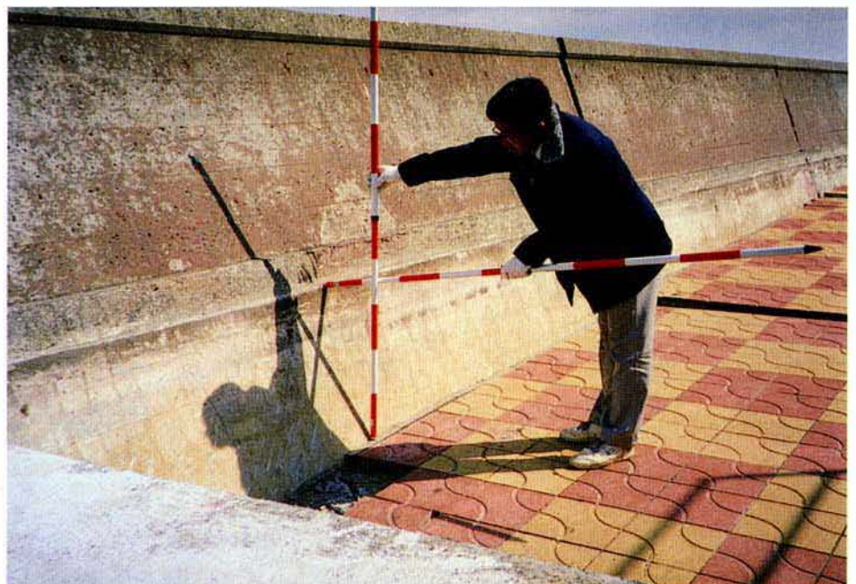
エプロン部の沈下60cm
