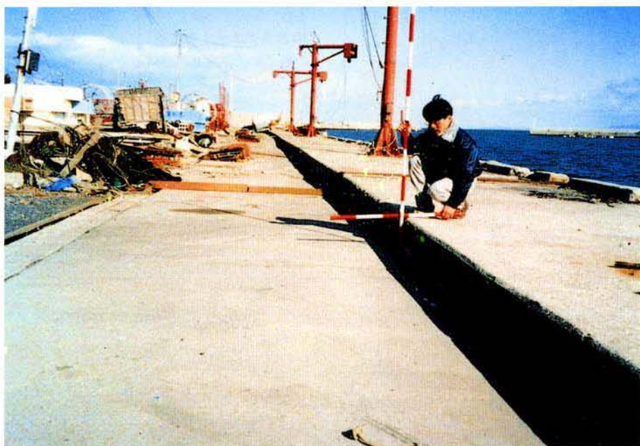
エプロン舗装の沈下状況 （約30 cm）
