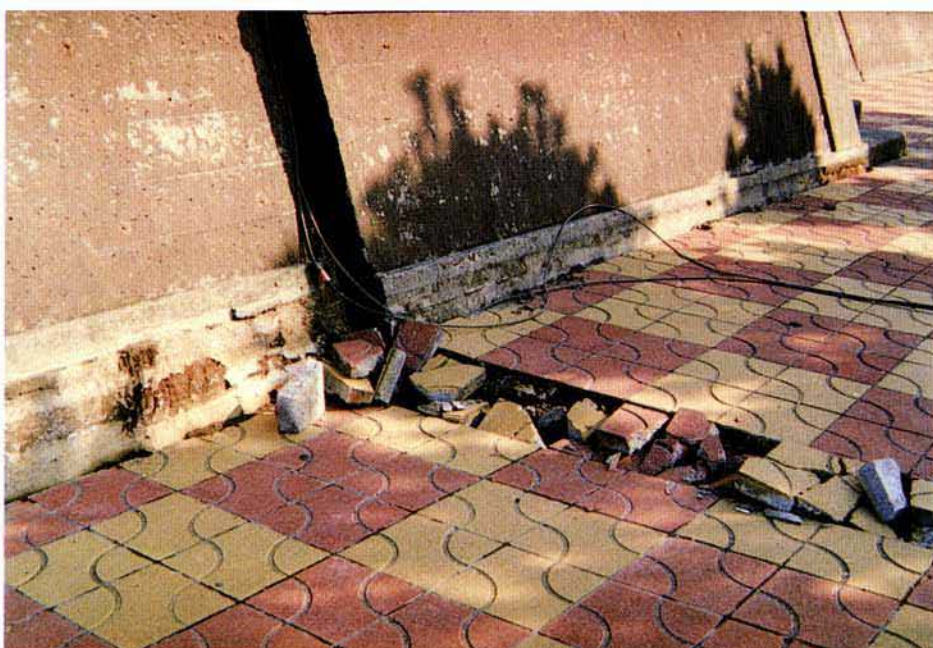
本体の移動による上部工のずれ カラー平板の損傷
