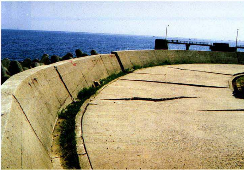
楠本海岸 護岸 本体工と水叩工に生じたクラック および目地開き
