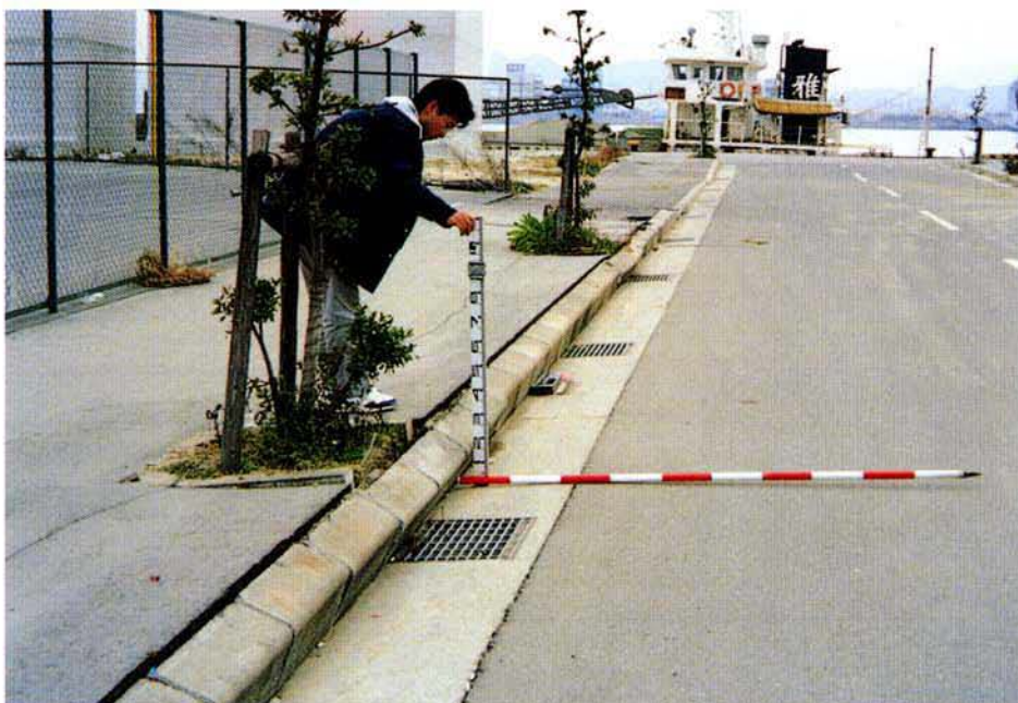
歩車道境界ブロック被災状況
