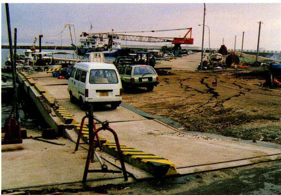
護岸法線のずれ、および地割れ
