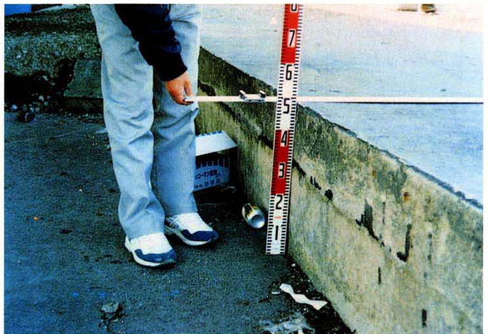
エプロン舗装沈下状況 （約50 cm） 右側が海側
