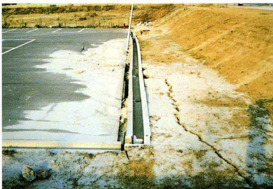
液状化現象およびU型側溝の沈 下、芝の地割れ状況
