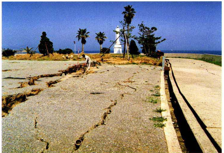
背後地の沈下および地割れ
