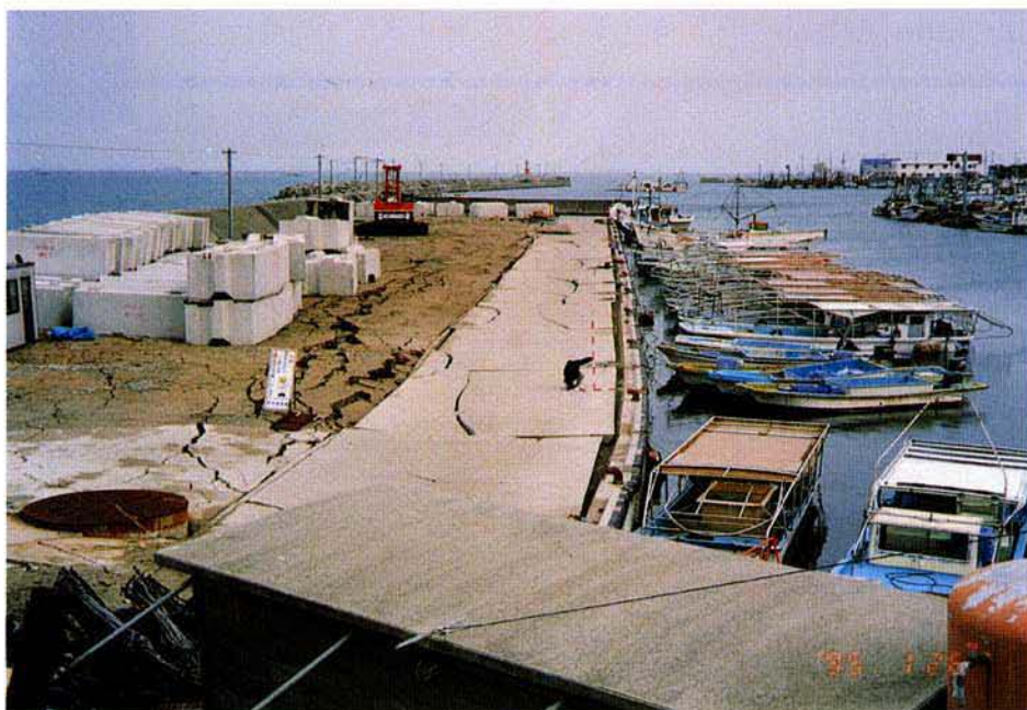
室津港 物揚場（－2 m） 全景 写真中央のポールが被災前の物揚 場前面の法線 地震により1 m以上海側に動いた。
