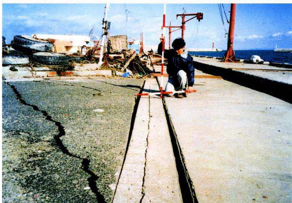
エプロン舗装止の目地開き状況 物揚場本体が約20 cm海側に 移動している。
