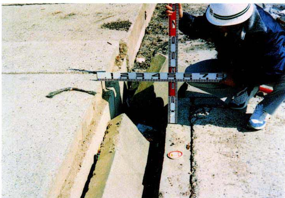
排水溝沈下状況 右側が荷捌所
