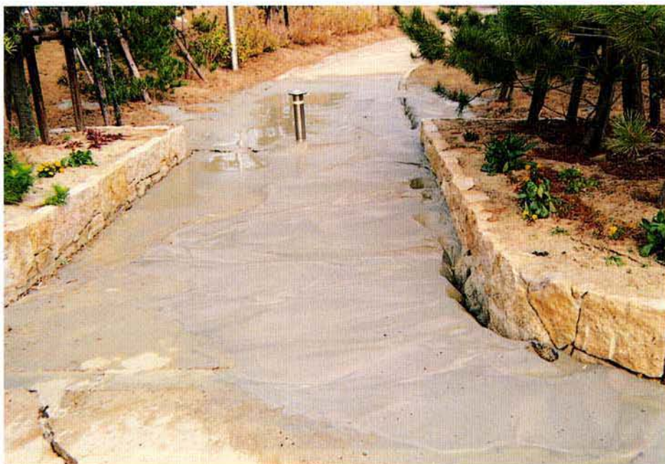
液状化現象による噴砂
