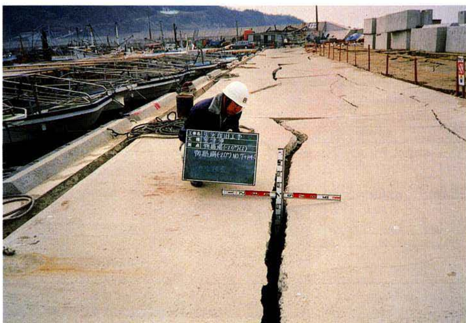
エプロン被災状況 コンクリート舗装が破損し、さ らに裏埋土が沈下し、エプロン との間に空隙が生じた。
