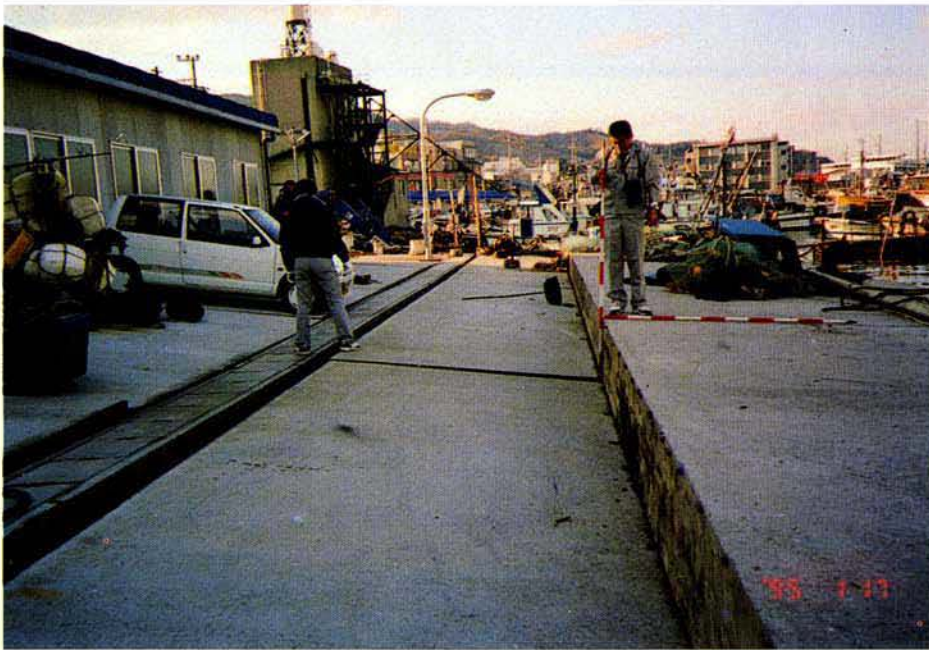
岩屋港 物揚場（－2 m） 水叩きの沈下により50 cmの段差が生じた。 本体も前傾した。
