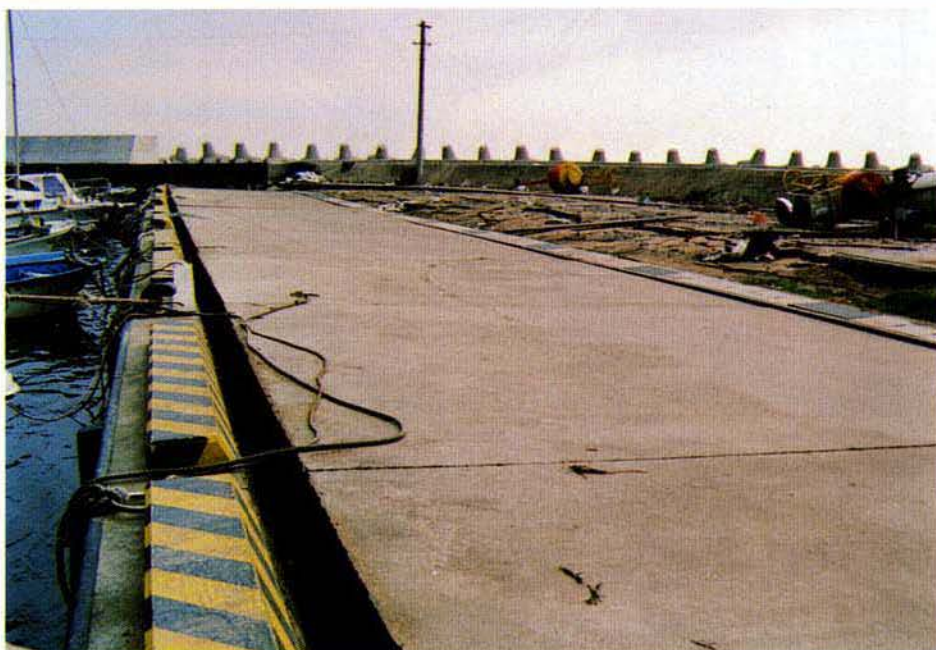
本体工とエプロンとの目地 開き
