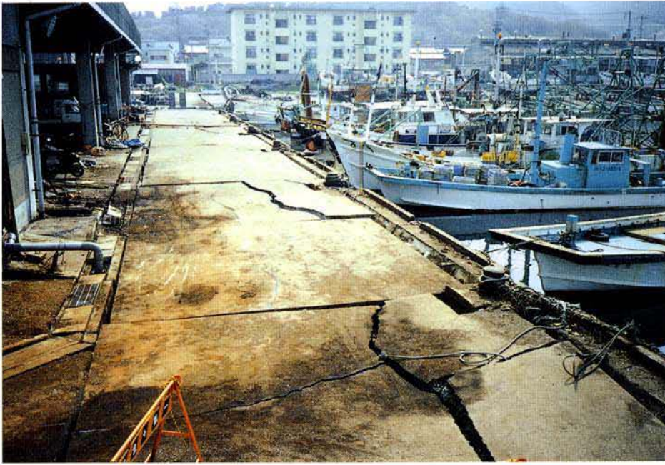
室津港 物揚場（－2 m） 全景 施設全体が海側へせり出し（約70 cm）、エプロンが破損した。
