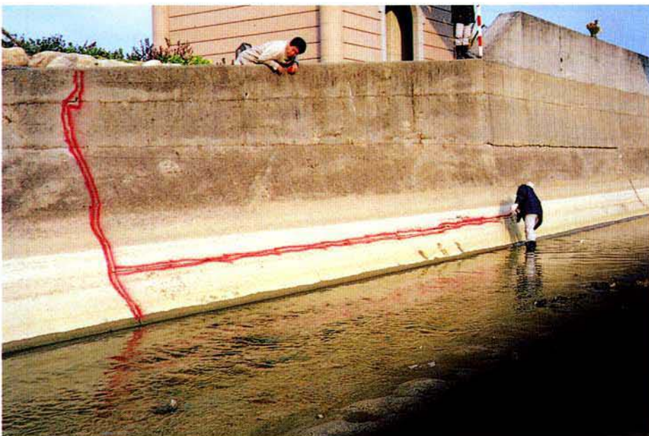
二級河川浦川の積ブロック（上 図）およびコンクリート護岸の 破壊（下図）
