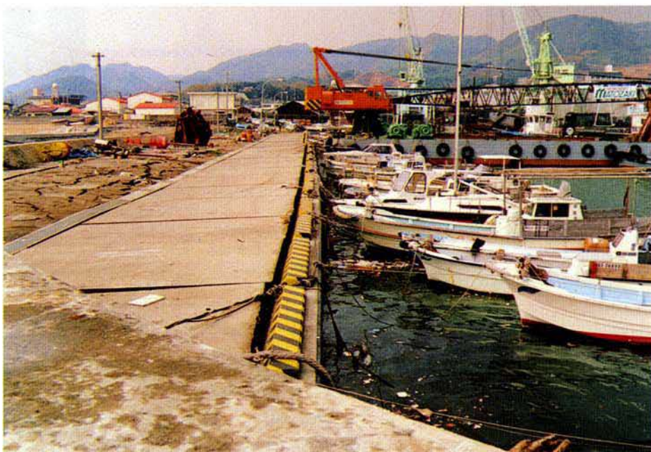
浦港 物揚場（－2 m） 本体工の押し出し、および背後の 地割れ
