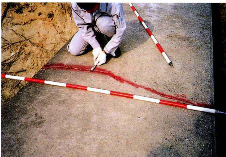
袖部天端に発生したクラック
