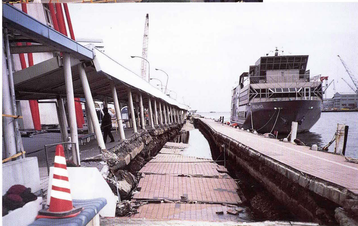
陥没した船着場 (神戸市中央区)
