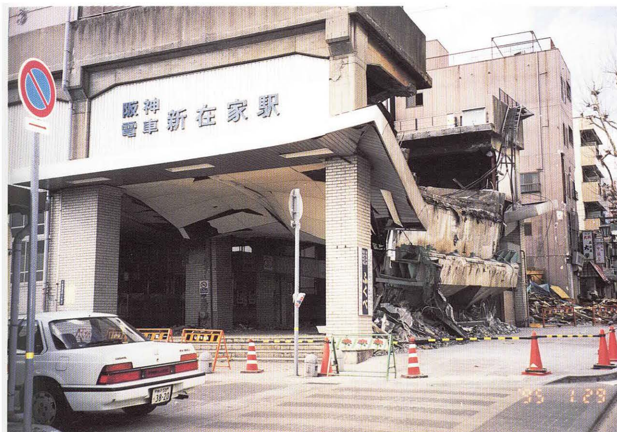
落下した高架鉄道敷（神戸市灘区）
