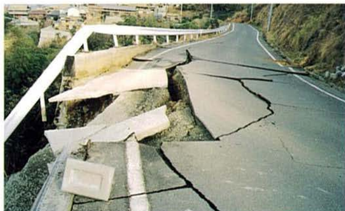
路面に亀裂が走りアスファルトがめくれ上がった道路 （野島 平林地区）
