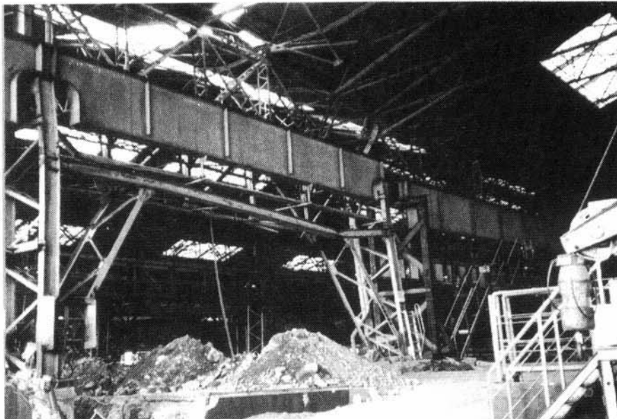
写真4.4-12 工場内橋形クレーンのランウェイガードの破損
