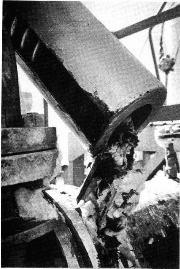
写真4.5-14 配管用スプリングハンガの圧壊
