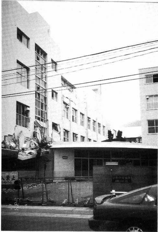
写真4.4-1 神戸製鋼本社ビルの破損
