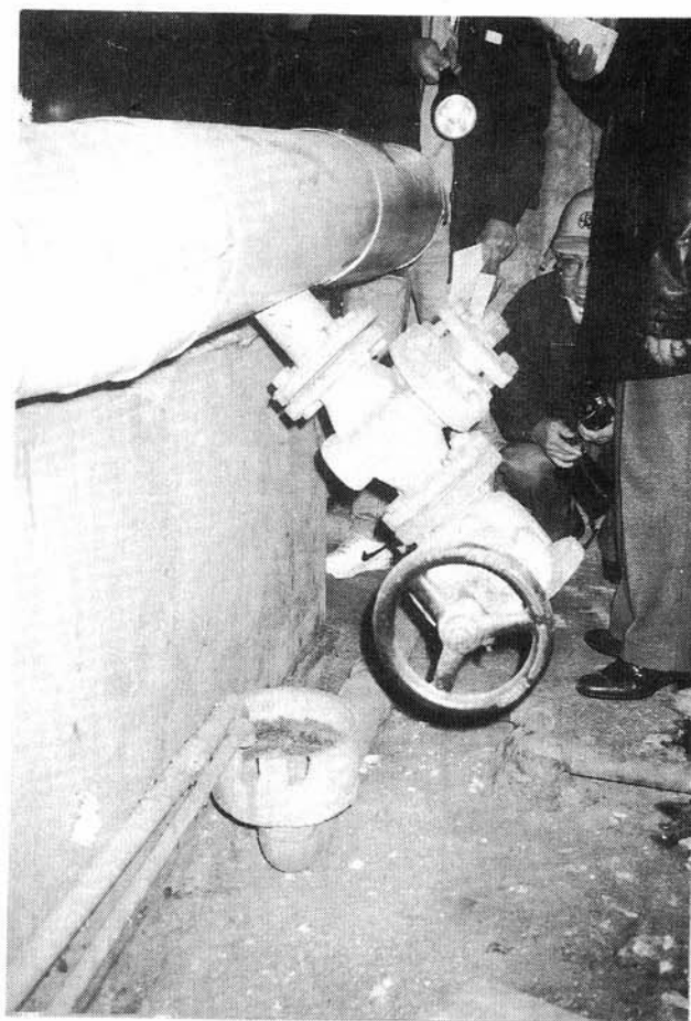
写真4.5-13 暖房用ボイラの 後部ブロー弁の衝突変形
