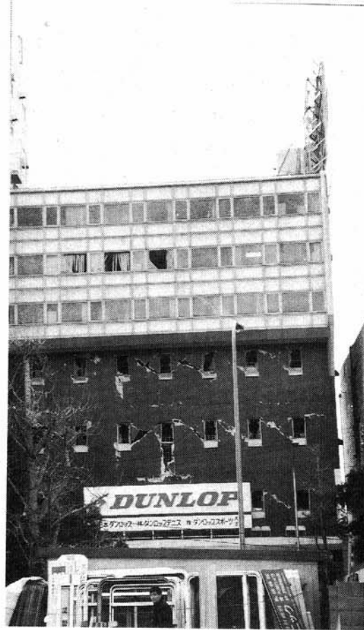
写真4.4-2 住友ゴム工場建屋の破壊
