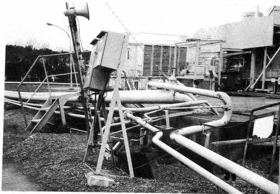
写真4.5-9 発電所内地上配管系の変形
