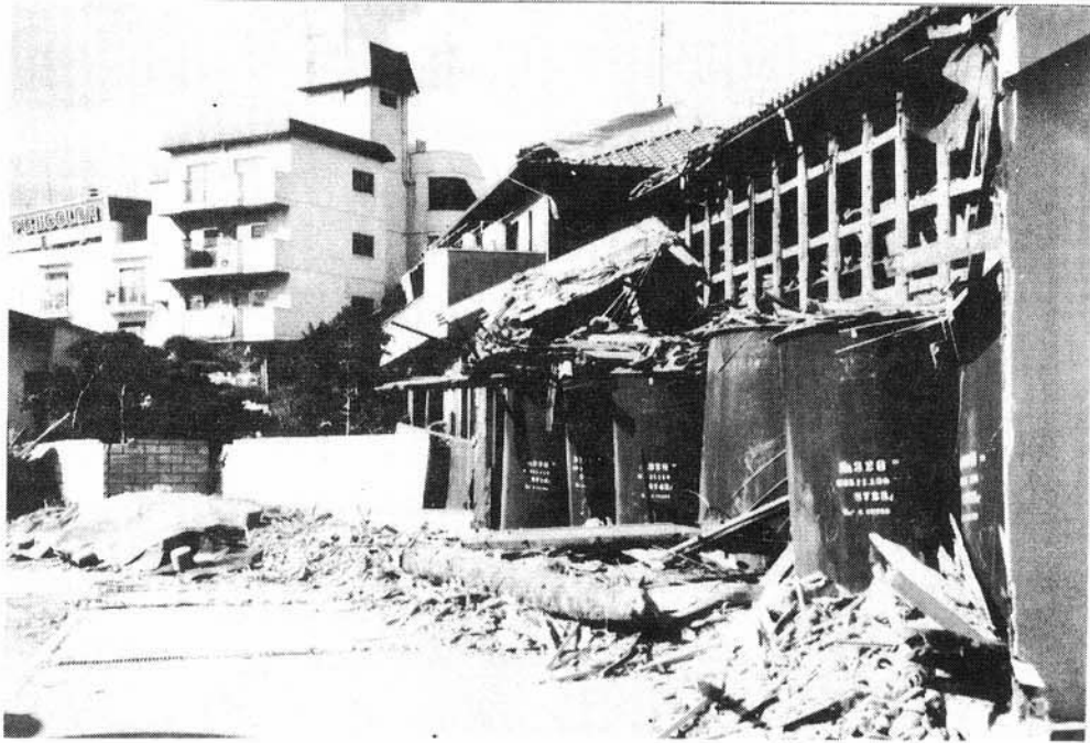
写真5.5-1 木造建物が半壊し、屋内のタンクが露出
