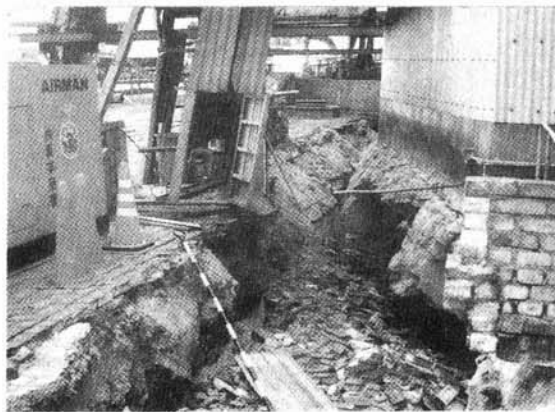
写真5.6-3 大きく陥没した神戸工場場内
