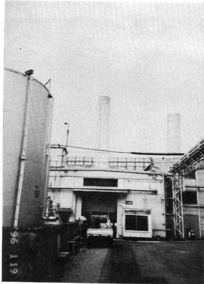
写真5.5-9 上から1/3が倒壊して残った煙突（現状）
