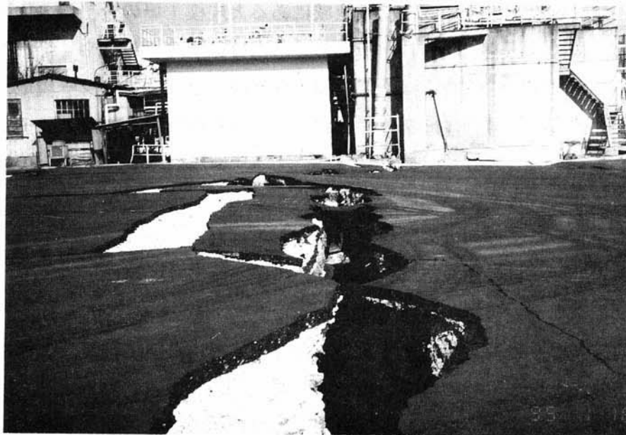
写真5.6-1 岸壁に走った大きな亀裂 西宮
