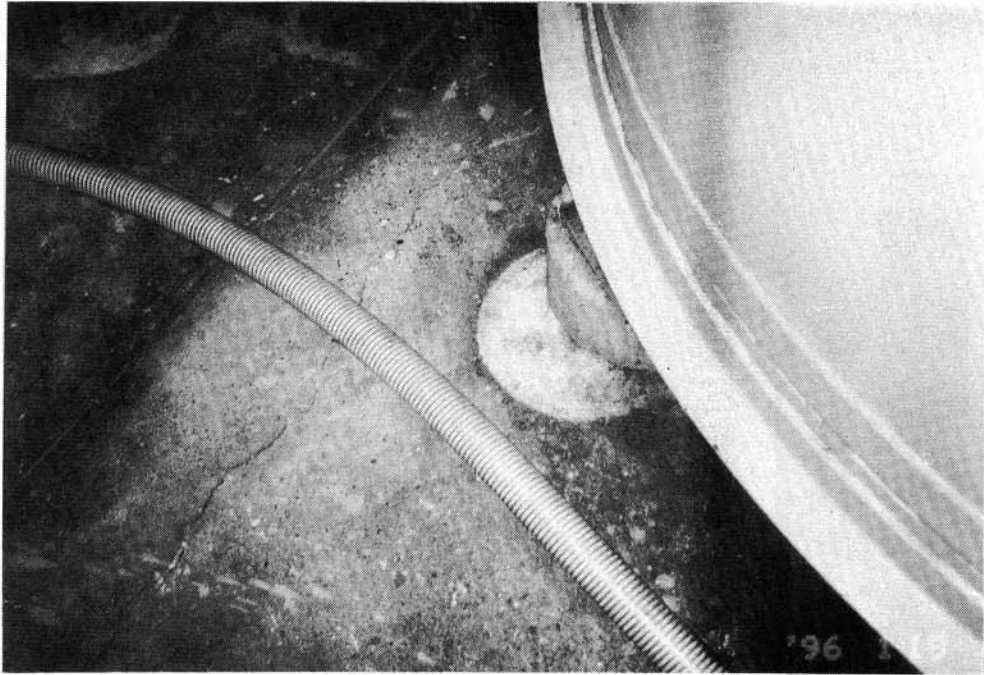
写真5.5-5 円筒形縦置きタンクの沓石のずれ（現状）
