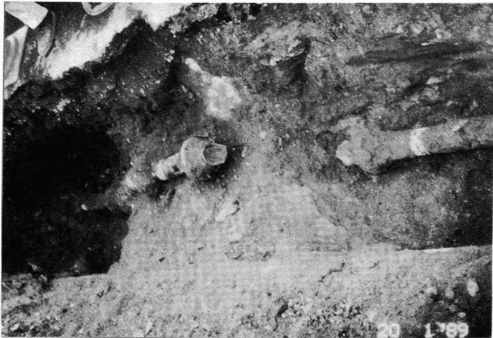
写真5.5-11 埋設管の被害
