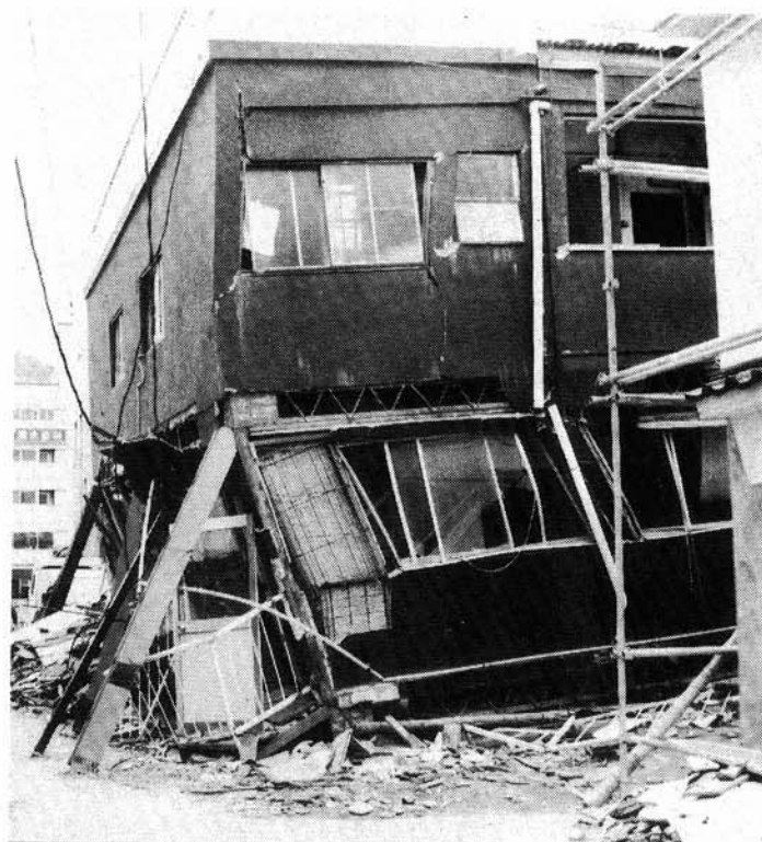
図6.2-2 壊滅的な被害を受けた工場 (神戸市須磨区)
