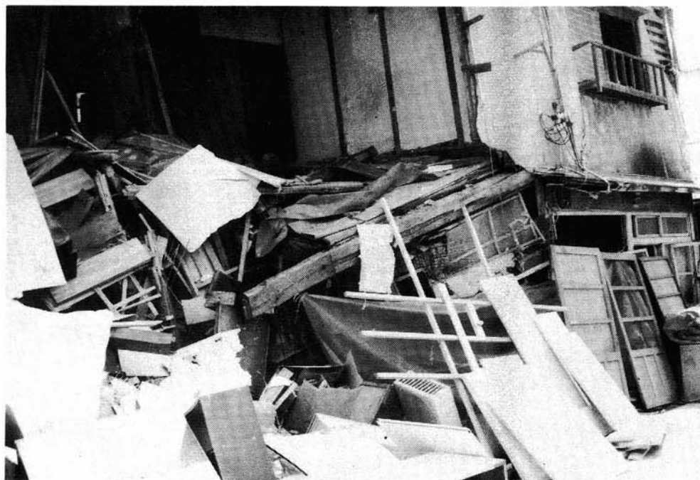
図6.2-1 壊滅的な被害を受けた工場家屋 (工作機械は残置、神戸市長田区)
