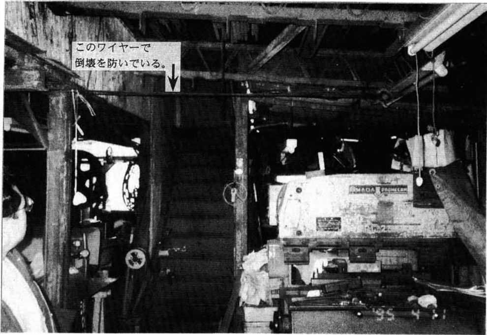
図6.2-7 被災した工場内部 (ワイヤーで工場の倒壊を防いでいる、神戸市西区)
