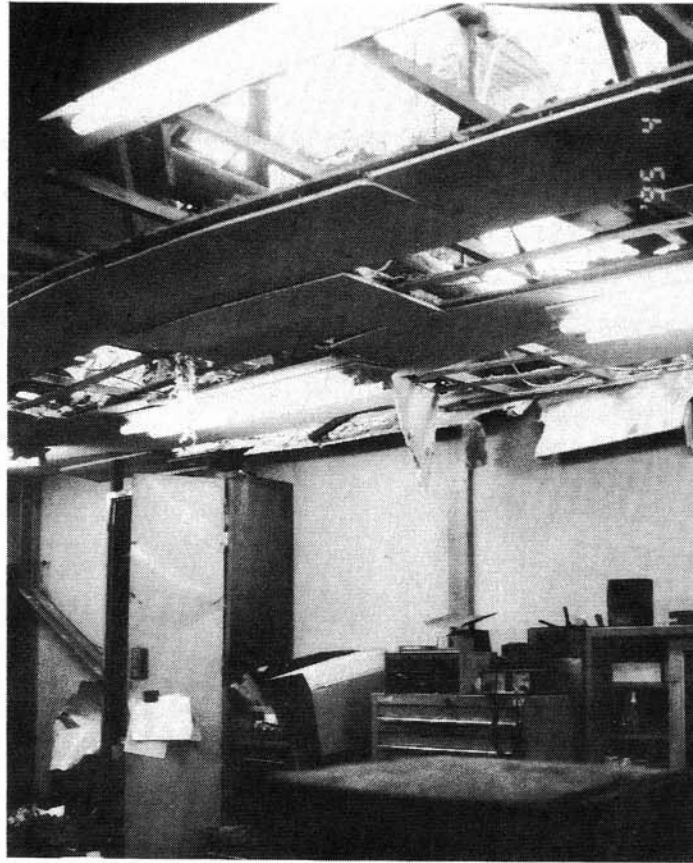
図6.2-5 被災した工場内部 (仮操業中、神戸市長田区)
