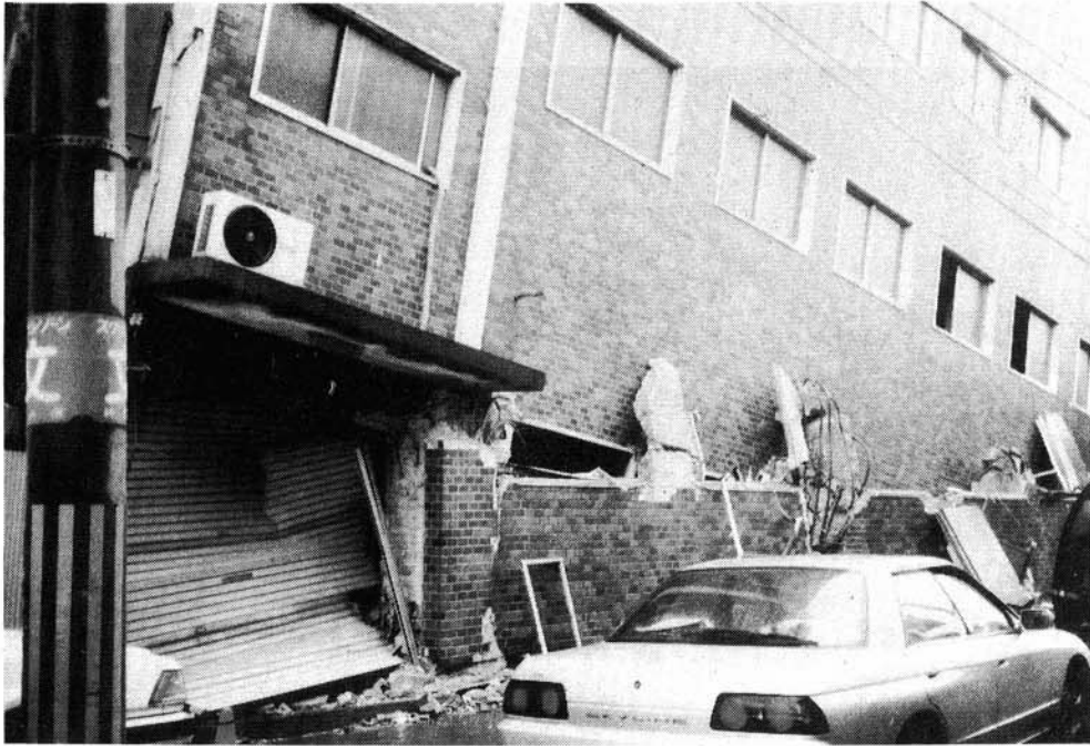
図6.2-3 壊滅的な被害を受けた工場
