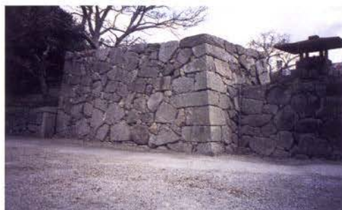
県立明石公園の被災状況（石垣の崩壊）と復旧
