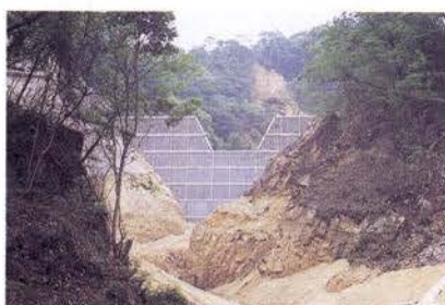
観音谷川の被災(不安定土砂の堆積)と復旧
