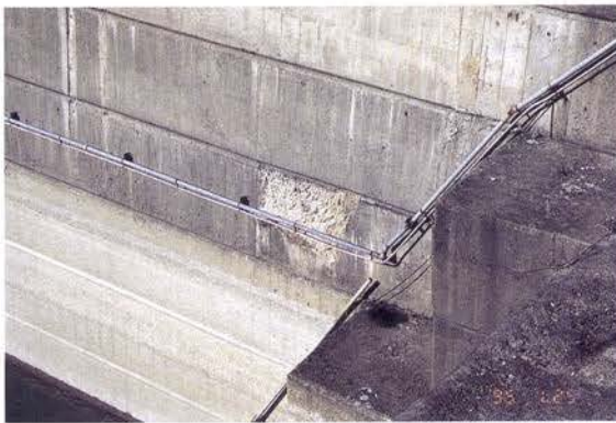
上流面補修モルタルの剥離（諭鶴羽ダム）
