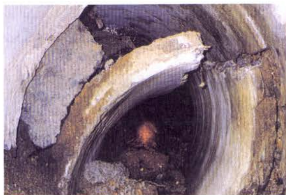
雨水管渠（暗渠）の被災状況
