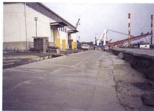
ケーソンの沈下、背後エプロンの陥没 (尼崎西宮芦屋港 -5.5m岸壁)
