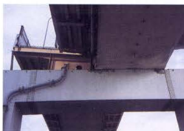
浜手バイパスの被災と復旧
