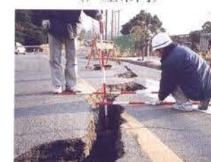
亀裂・段差が生じた道路 (芦屋市内)
