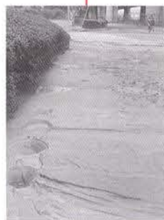
液状化した埋立地 (神戸市中央区)
