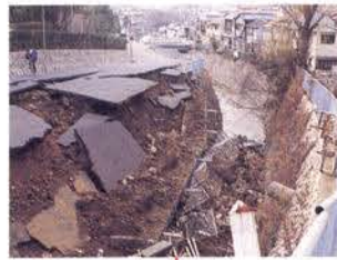
崩壊した河川護岸 (神戸市中央区)
