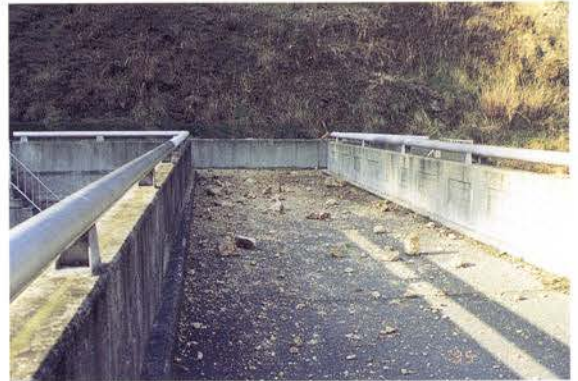
右岸天端への落石（天王ダム）
