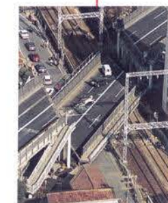
落下した道路橋 (西宮市内)
