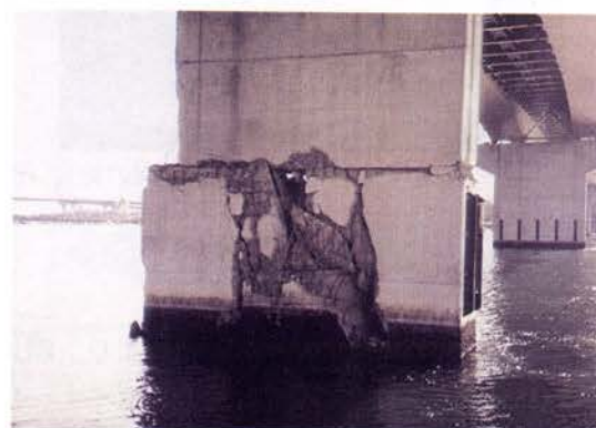
破壊した橋脚（西宮大橋）
