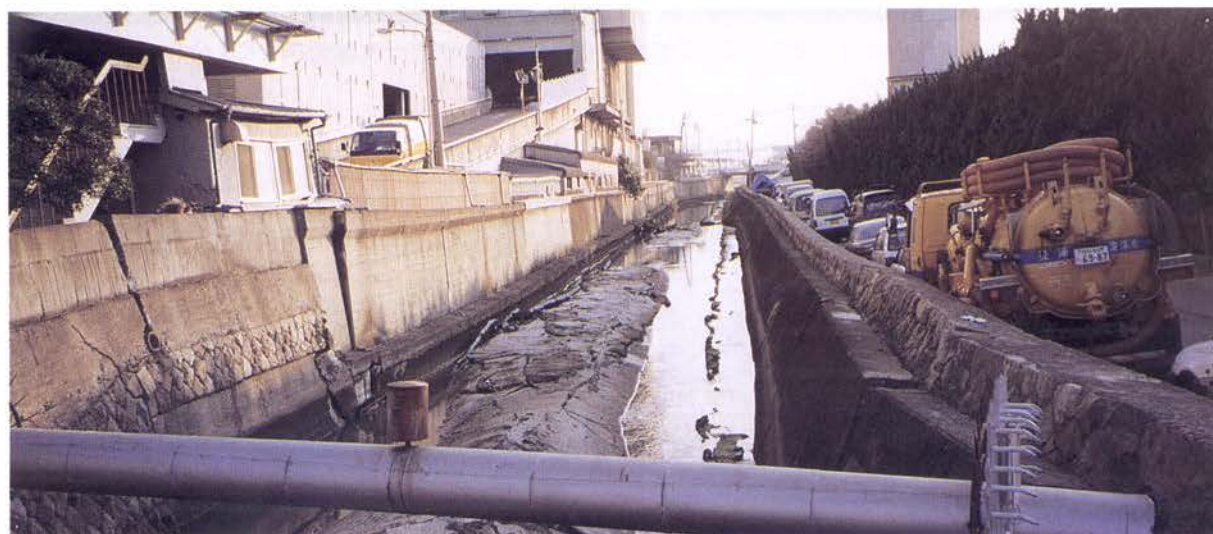
雨水幹線の被災状況
