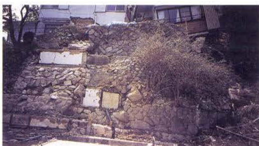
山芦屋町地区の被災（石積み擁壁）と復旧
