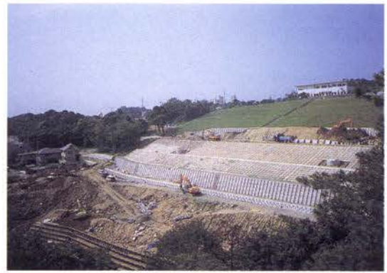
仁川百合野町地区の被災と復旧
