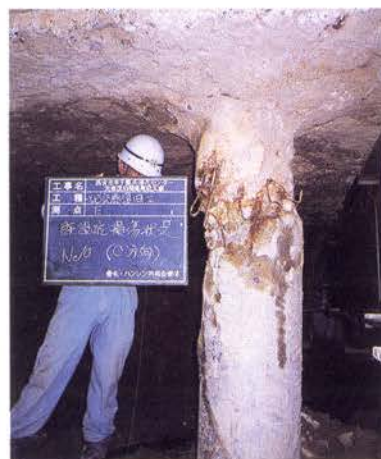
処理場配管廊基礎杭の被災状況
