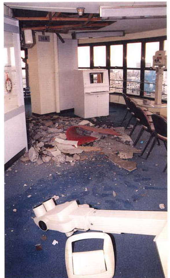
▲天井が落ち、望遠鏡が転倒した天文科学館展望室
