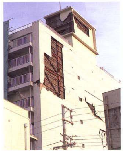
▲外壁が大きく崩れ落ちたマンション(樽屋町)
