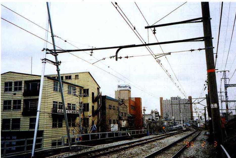
和田岬連絡線 仮電車線設備
