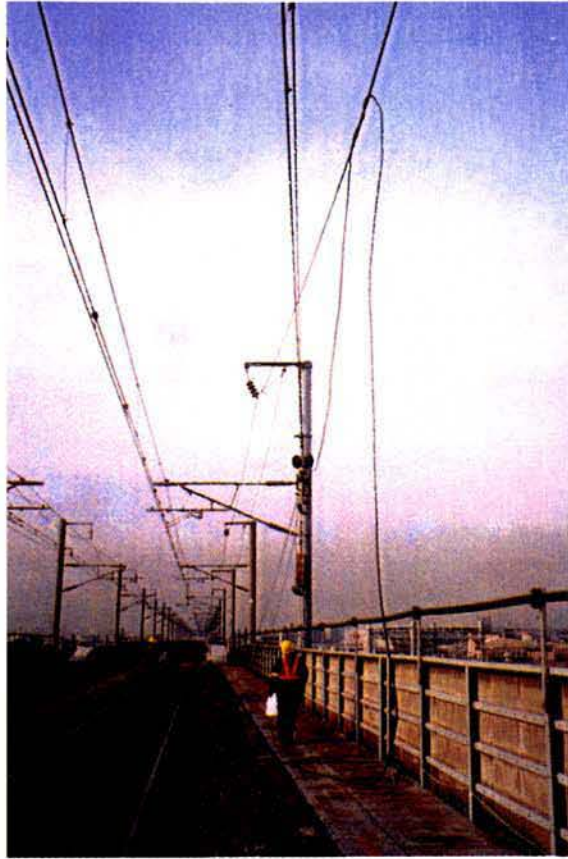
新幹線 517k434m 付近上り線 保護線 (HAL300mm 2 ) 断線箇所
