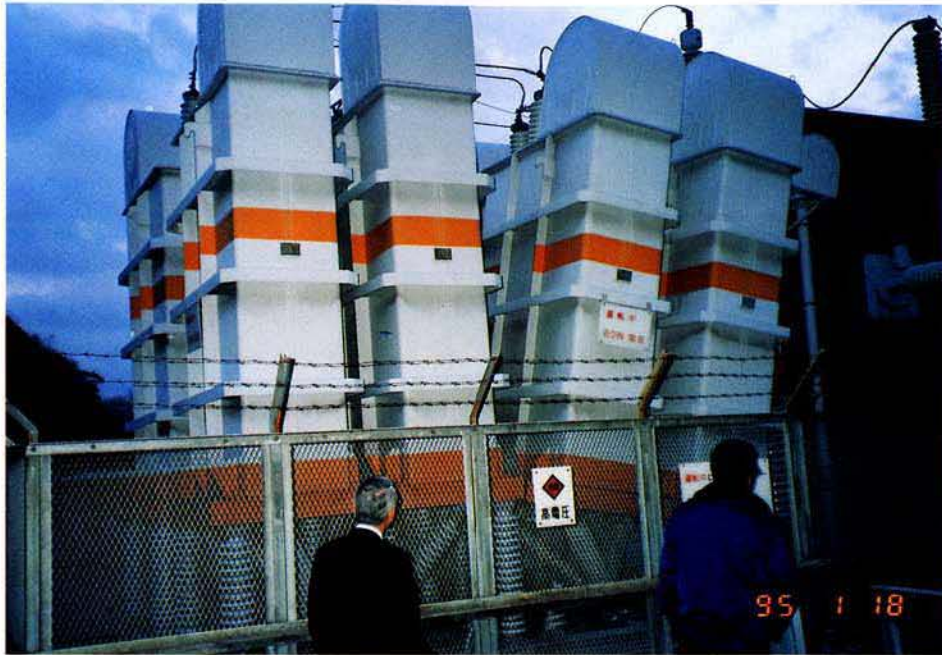
山陽新幹線 新六甲変電所 並列コンデンサー傾斜
