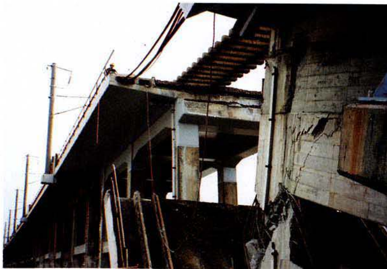
新幹線高架橋箇所で宙吊りになった通信ケーブル
