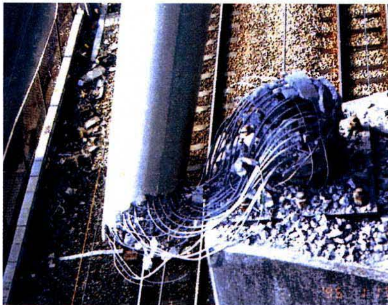
新幹線 518 k 076 m 付近下り線 コンクリート柱折損箇所基礎部 地震により高架橋、コンクリート柱が揺れ、共振現象により挫折損傷した。
