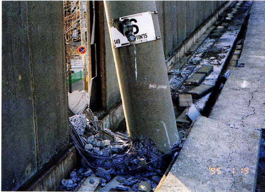
六甲道駅構内 構6号柱 電柱基礎部損傷
