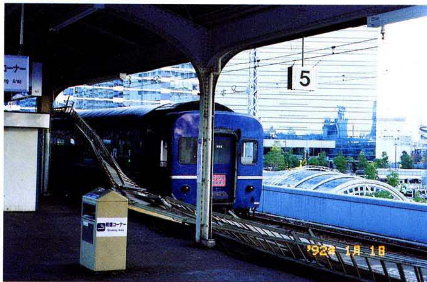
神戸駅ホーム・ケーブルラック落下
