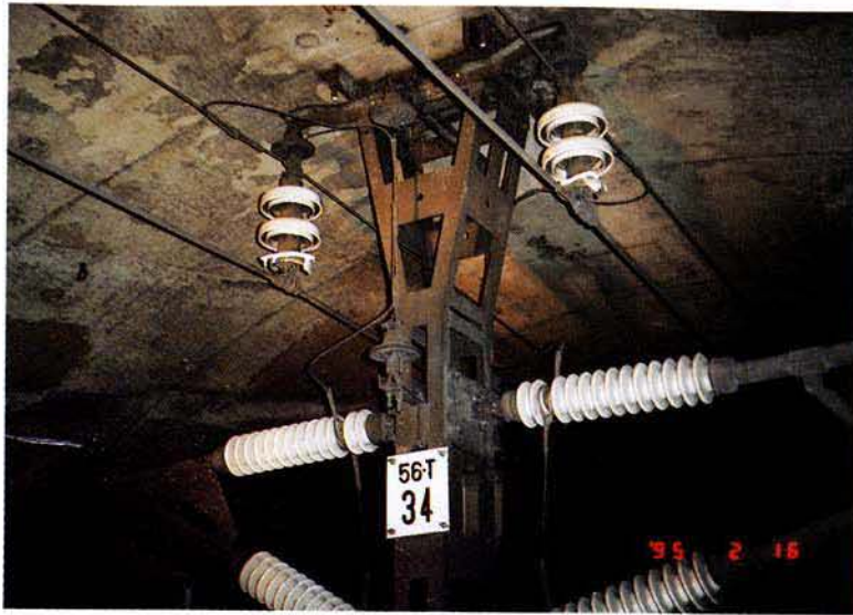
新幹線トンネル内におけるがいし破損
