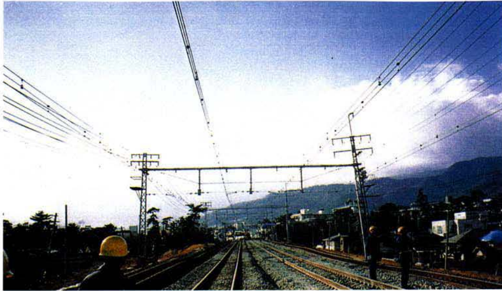
東海道本線 573k250m付近 西の宮～芦屋間上下線 鉄柱傾斜 [200×90×11.3] コンパウンド架線 基礎部付近の地盤が移動したため、基礎部移動し鉄柱がハ形に傾斜した。
