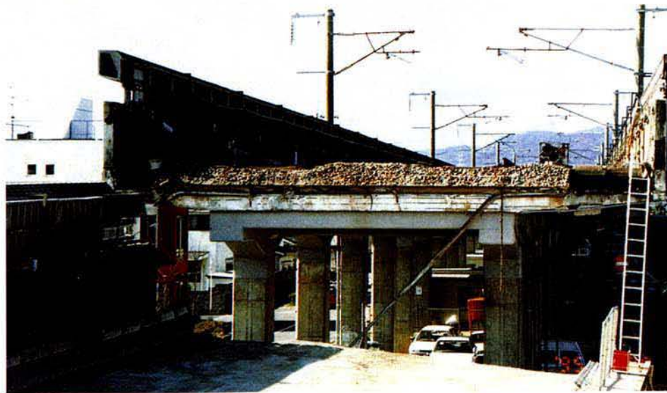
山陽新幹線 新大阪～新神戸間 高架橋崩壊
