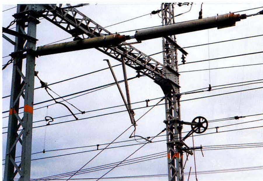
山陽本線 新長田～鷹取間 下り線 4k388m付近 振動により balanser が大きく変動し ロットが破断した
