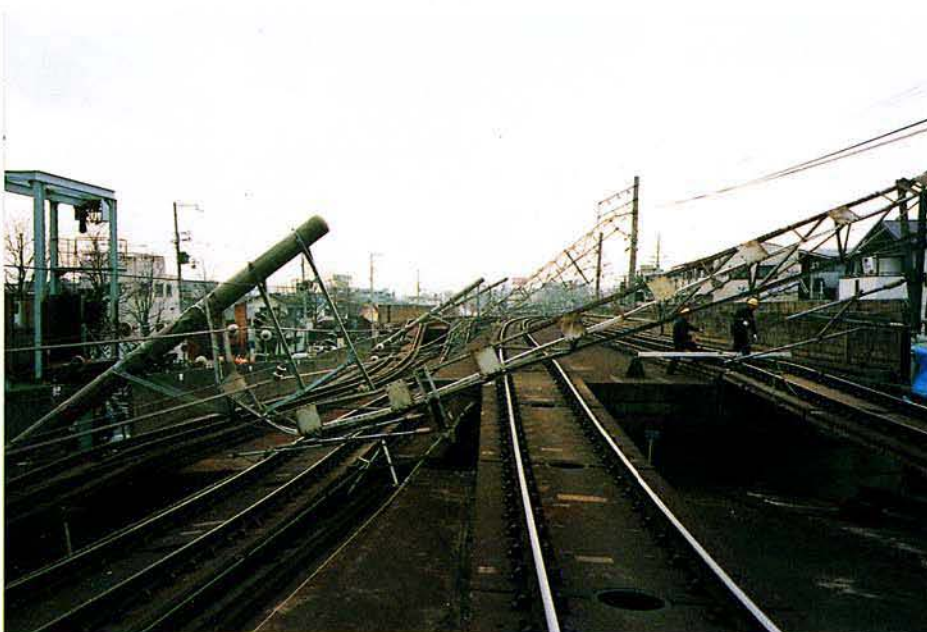
六甲道駅構内 構7号柱付近 電柱倒壊
