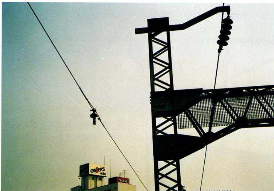
新幹線 569k 830m 付近西明石駅構内上り線 舌型金具破損 鉄柱下部が地震で揺れたため、腕金の溶接部が折損した。
