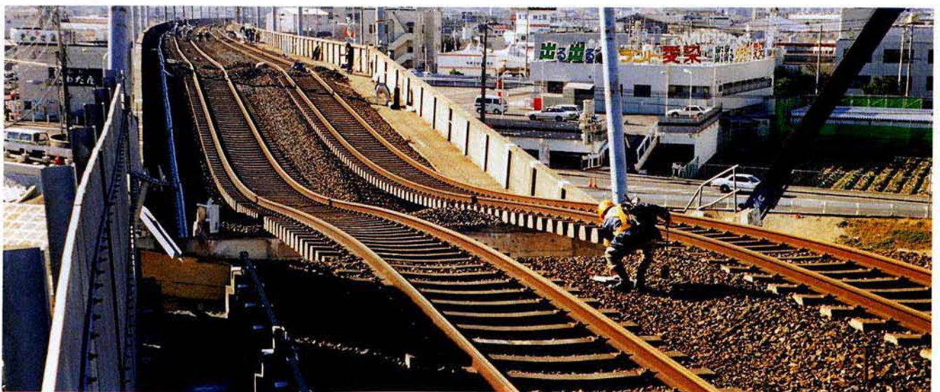
山陽新幹線 566.1k 付近 高架橋の崩壊
