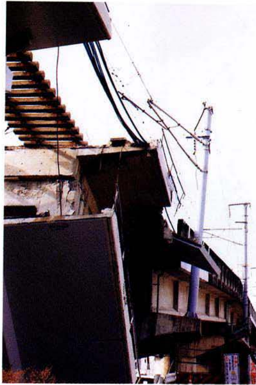
山陽新幹線 530.7k付近 高架橋崩壊による電車線路設備損壊
