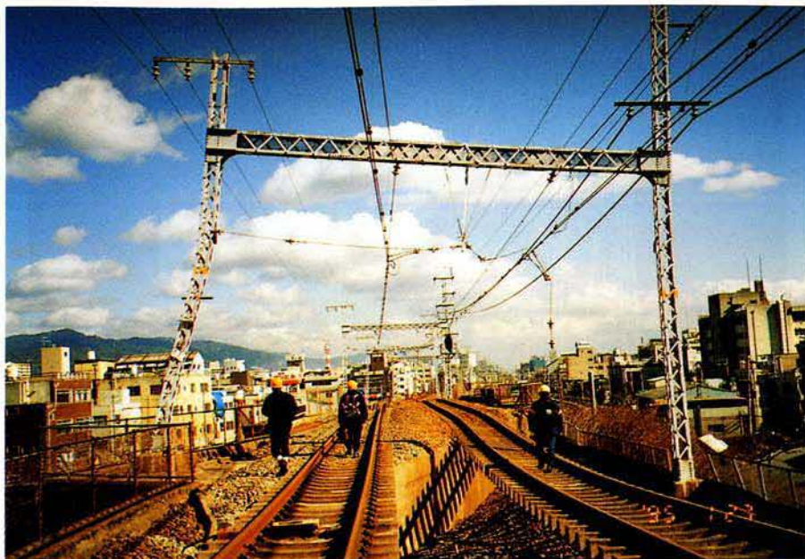
山陽本線 新長田駅構内 構1号柱付近 鉄柱傾斜 路盤の振動により鉄柱が湾曲した。
