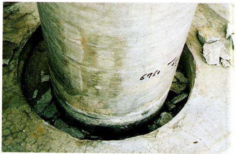
大阪環状線 芦原橋～新今宮間内回り 8k951m付近 電柱基礎部砂噴出 (コン柱10N35) 砂詰め基礎の砂が電柱の振動により、 基礎外へ噴出し電柱が傾斜した。
