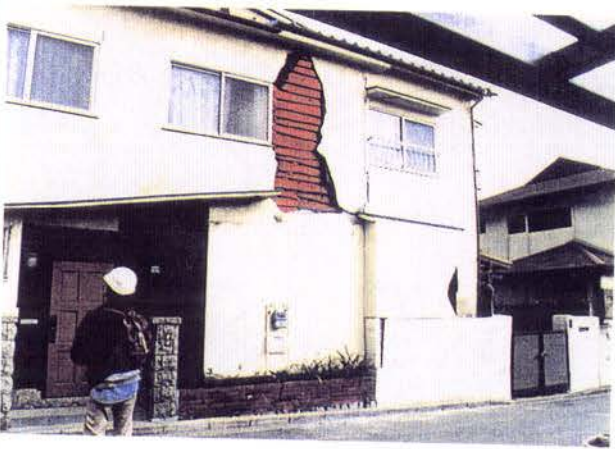
モルタル被害中：部分的な崩落、割れ、浮きがある状態。
