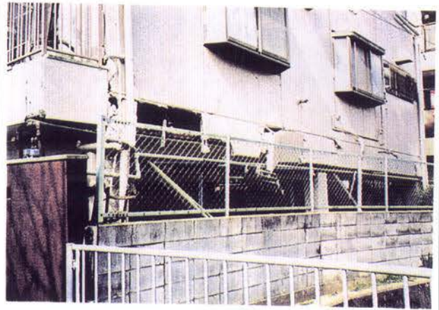
ALC被害大：破損、脱落が見られる状態。
