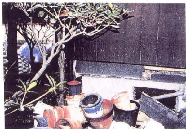
ずれ：基礎と土台がずれている状態を「ずれ」とした。
