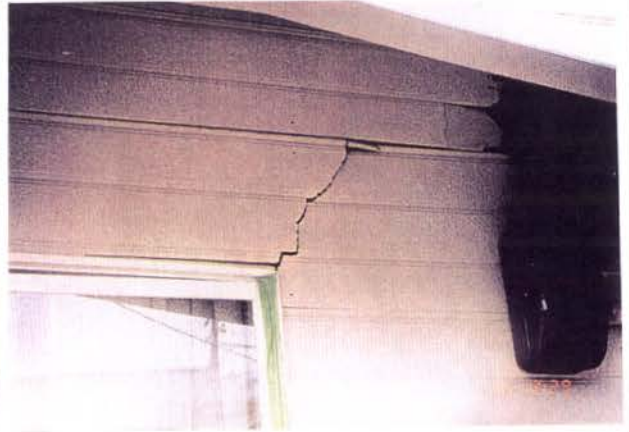
窯業系サイディング被害中：割れ、欠け、亀裂が見られる状態
