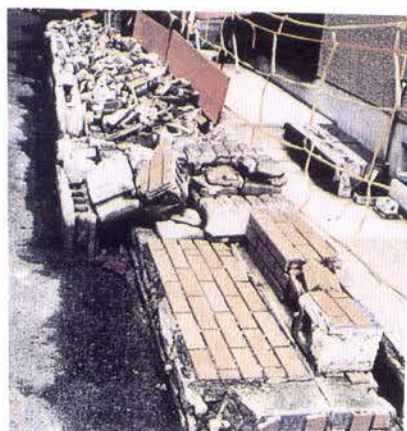
崩壊：構造部材がくずれている状態を「崩壊」とした。
