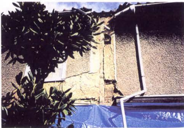
土壁被害中：部分的な崩落、割れ、浮きがある状態。
