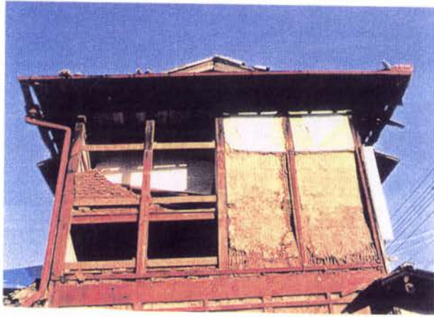
土壁被害大：大部分が崩落している状態。
