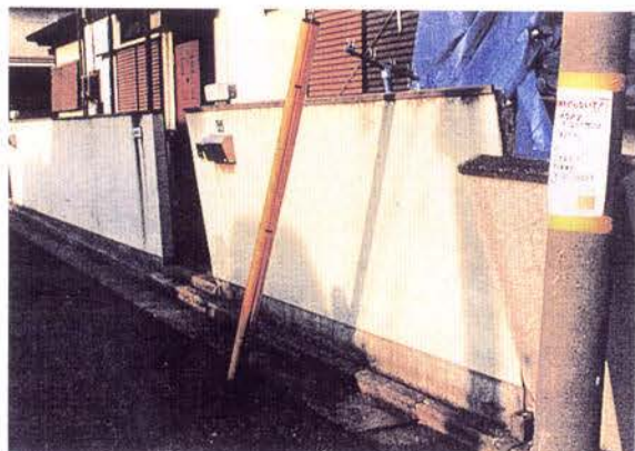
傾き：倒壊にいたっていないが、傾いている状態を「傾き」とした。 (修復が不可能な状態。)
