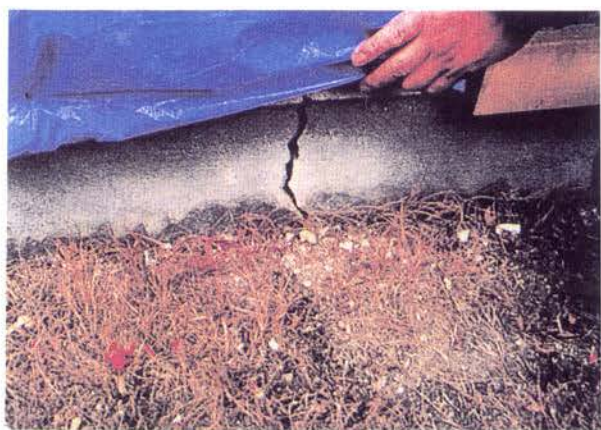
割れ：基礎が割れている状態を「割れ」とした。
