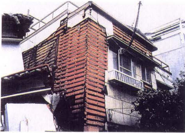
モルタル被害大：大部分が崩落している状態。
