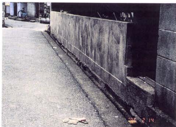
段差(浮き)：地盤との間に段差が生じて、浮いている状態を「浮き」とした。
