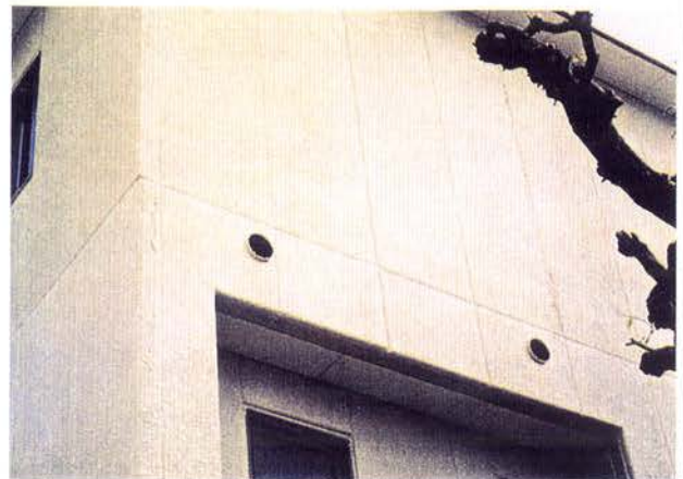
ALC被害小：わずかな亀裂、欠けがある状態
