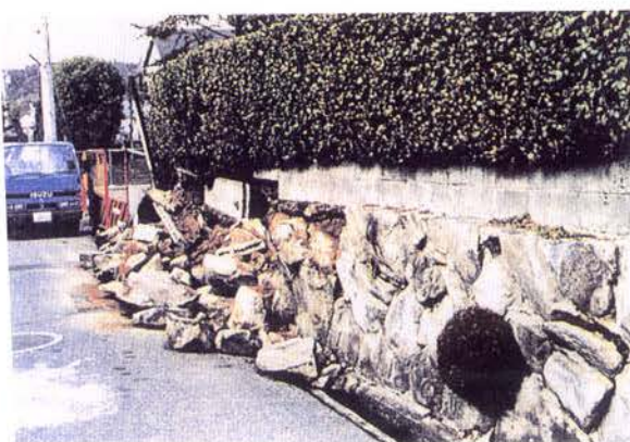
一部崩壊：構造部材の一部が崩れている状態を「一部崩壊」とした。
