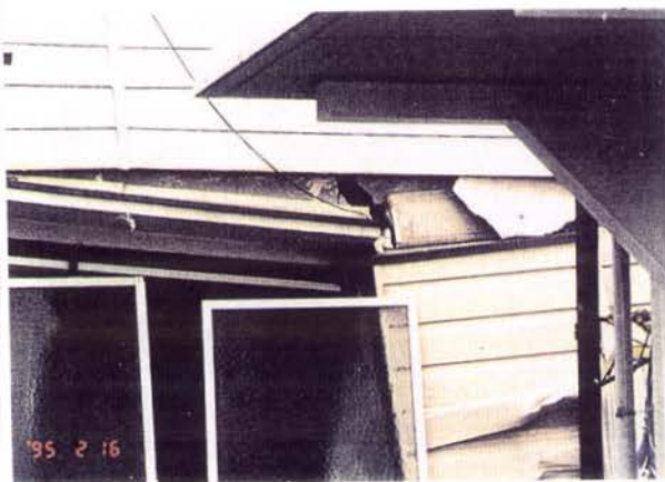
金属系被害中：ゆがみが見られる状態。
