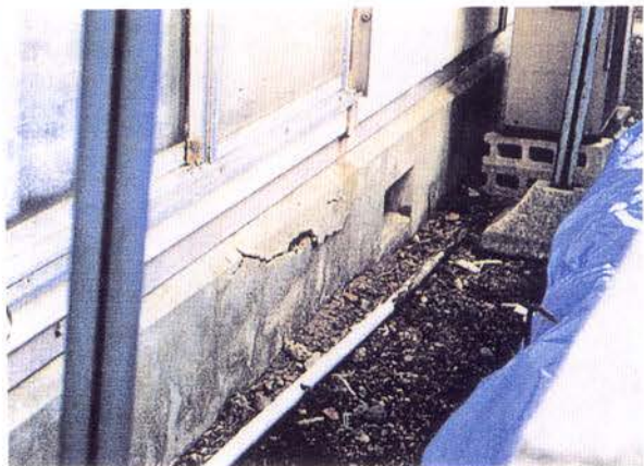
破損：基礎が破損している状態を「破損」とした。
