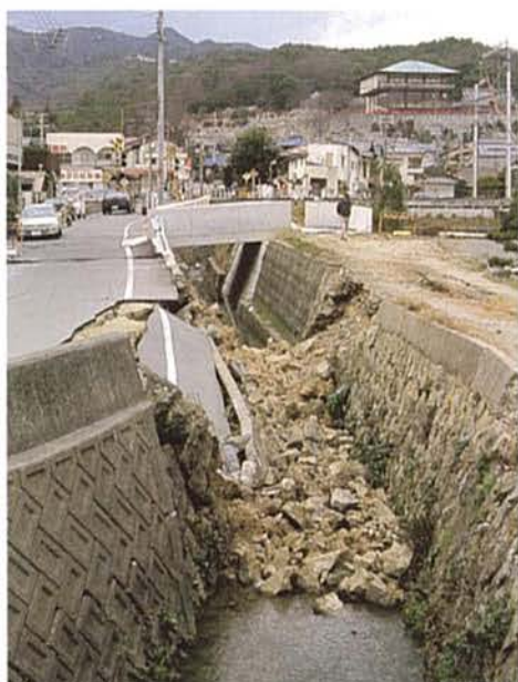
崩壊した足洗川の擁壁（中山寺3丁目）
