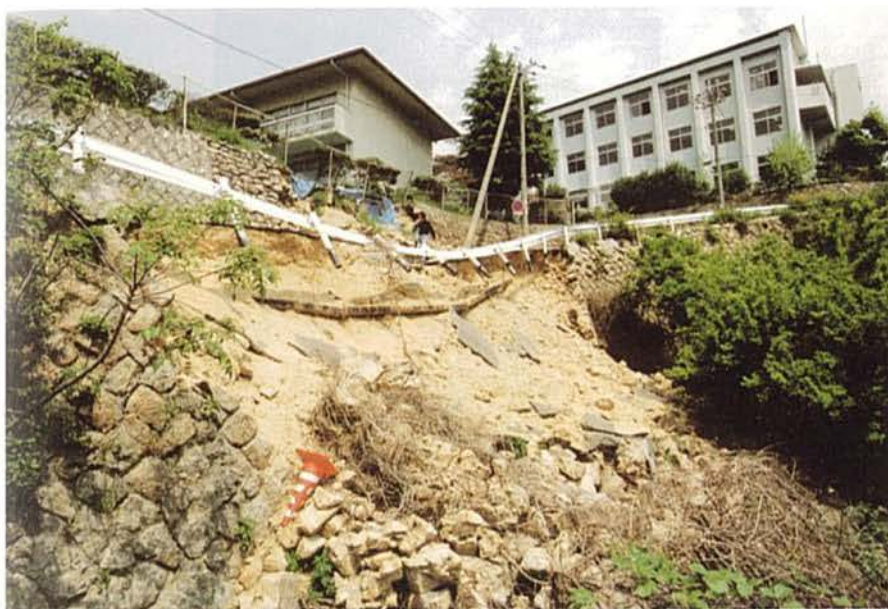
道路（路肩）の崩壊（紅葉ガ丘）
