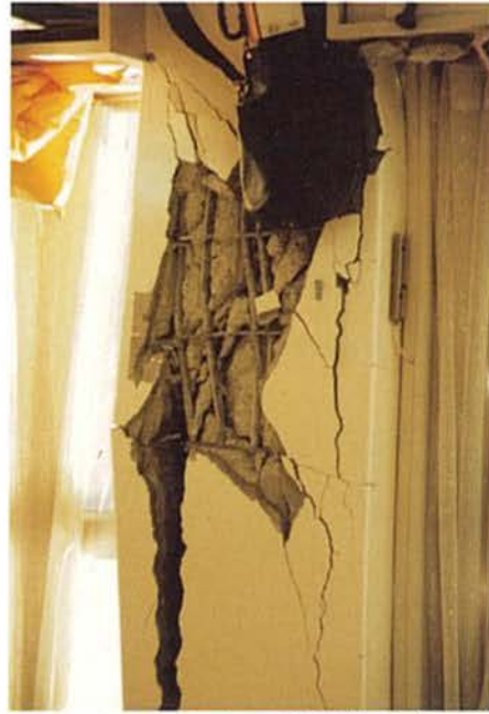
コンクリートがはがれ、鉄筋がむき出しになった柱（長尾中学校）
