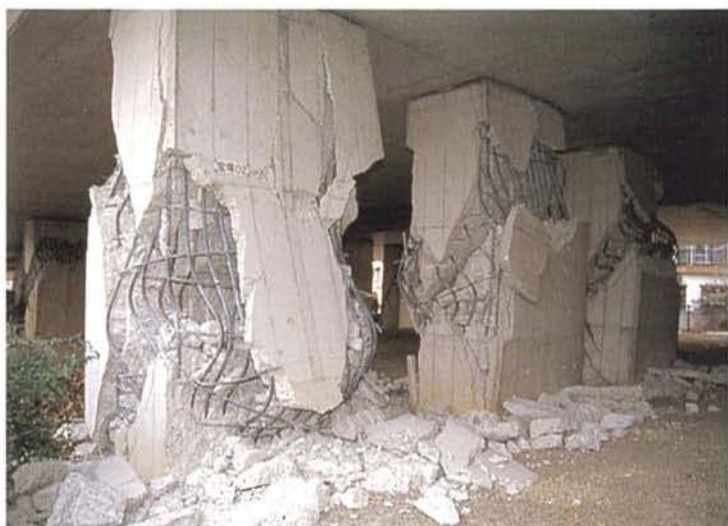
壊れた中国自動車道の橋脚（売布3丁目）
