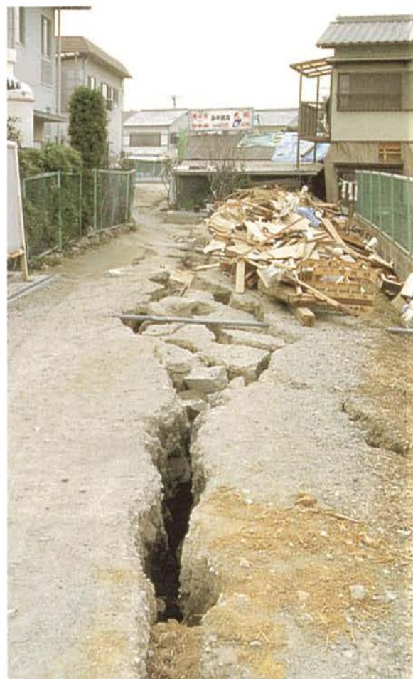
地震による地割れ（山本東2丁目）
