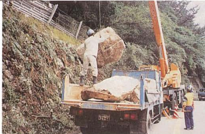
転石の撤去作業（宝塚唐櫃線）
