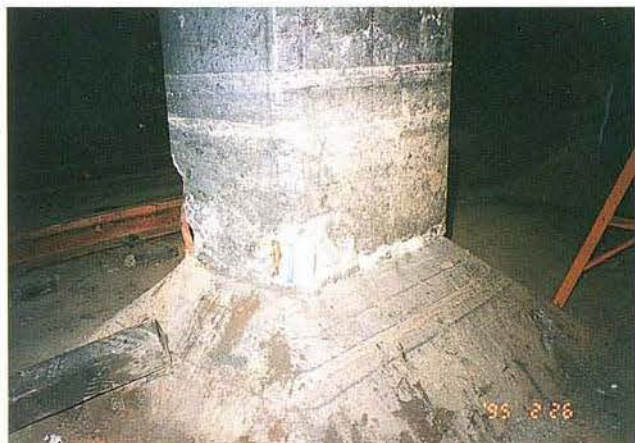
写真 3.1-70 中柱の下端に生じた剥離
