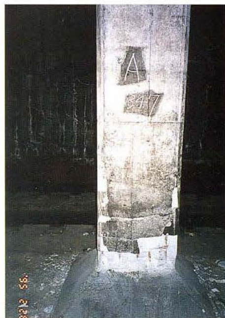
写真 3.1-69 中柱の下端に生じた剥離
