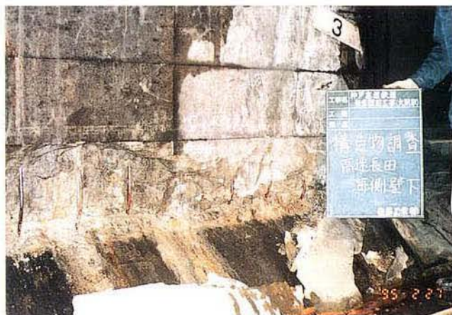
写真 3.1-62 一般路線部・高速長田側側壁 (海側)
