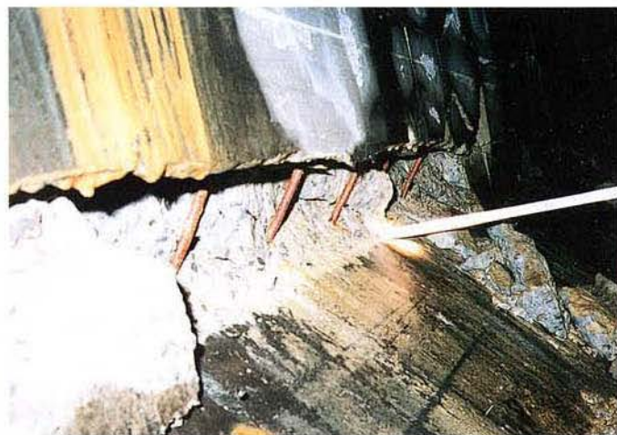
写真 3.1-63 一般路線部・高速長田側側壁 (海側)
