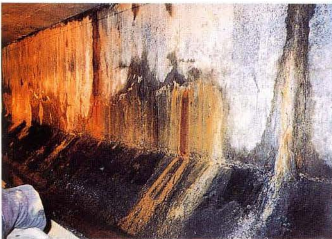
写真3.1-46 プラットホーム下の側壁 コンクリートの剥離
