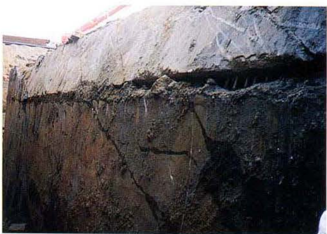
写真 3.1-73 高速長田側端部付近の側壁外部に 生じた亀裂（海側）
