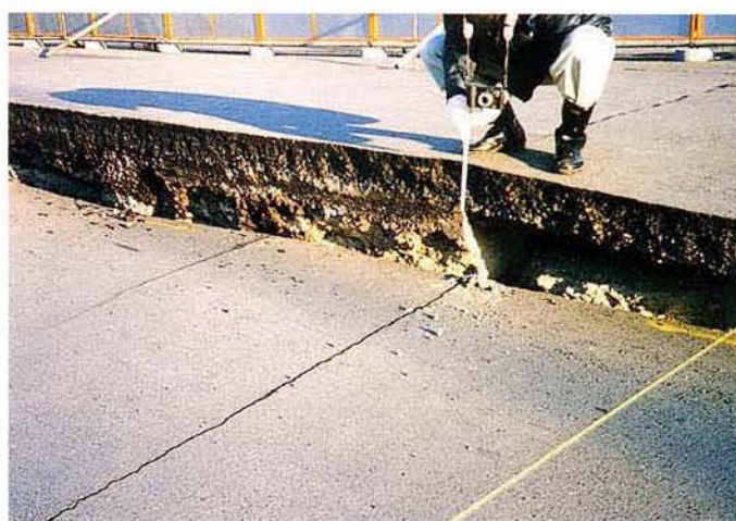
写真 3.1-5 陥没後の路面下の空洞
