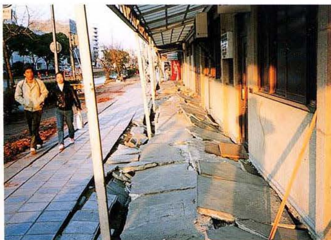
写真 3.1-8 県営大開住宅の海側
