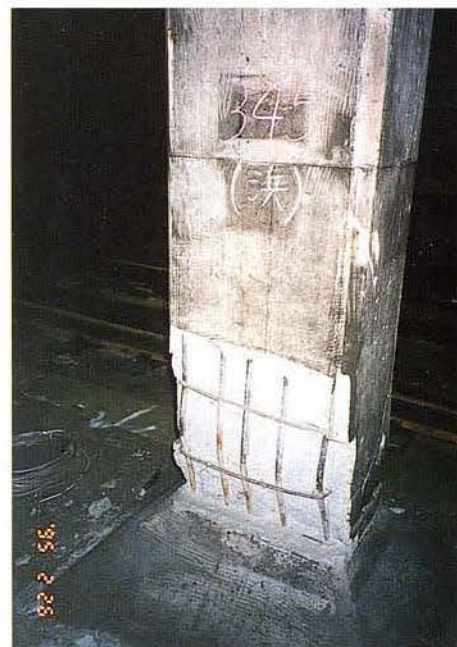
写真 3.1-71 中柱の下端に生じた剥離
