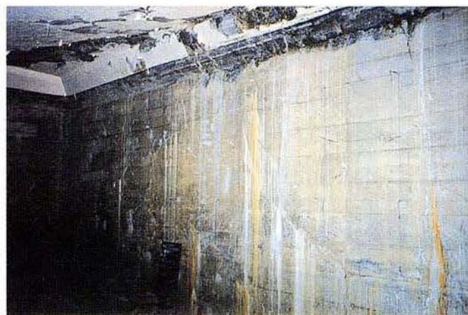
写真 3.1-41 高速長田側妻壁付近の側壁（山側）
