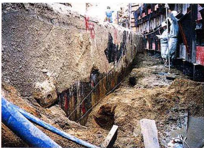
写真 3.1-79 新開地側端付近の側壁外面 に生じたひびわれ（海側）
