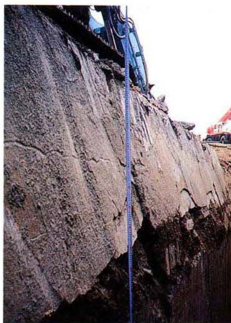
写真 3.1-74 高速長田側端部付近の側壁 外部に生じた亀裂（山側）
