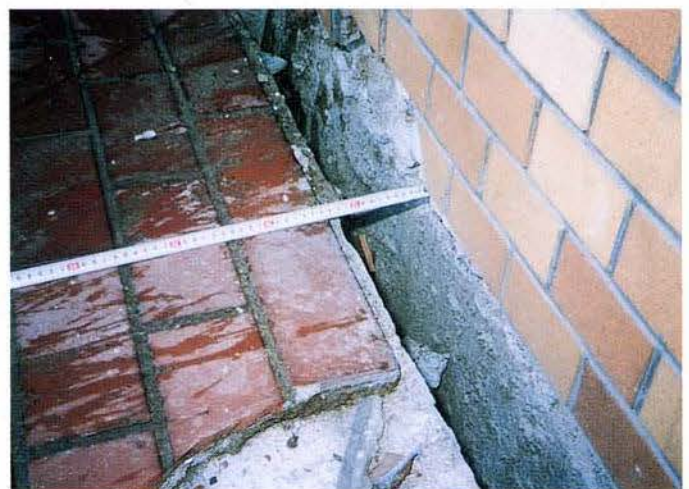
写真 3.1-8 県営大開住宅の海側
