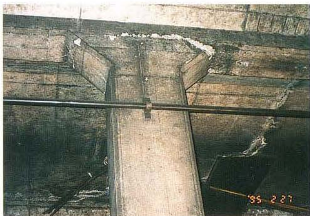
写真 3.1-68 中柱の上端に生じたひびわれ
