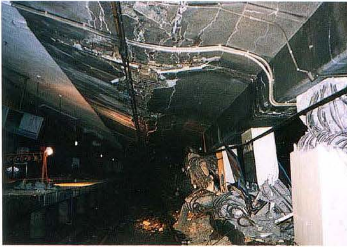
写真 3.1-17 高速長田側（海側）
