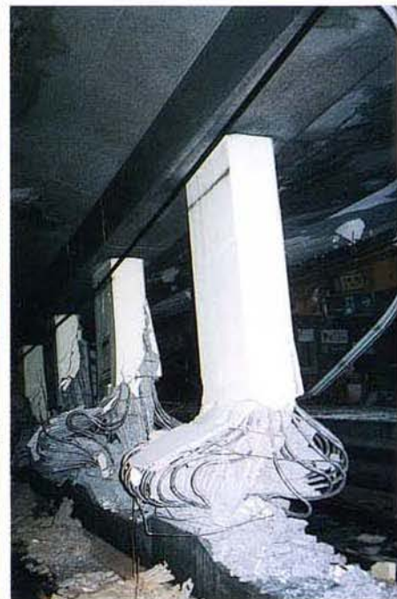
写真 3.1-23 脚部の圧壊（中柱23）
