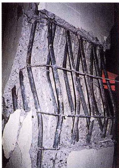
写真 3.1-24 帯鉄筋の効果（中柱34）
