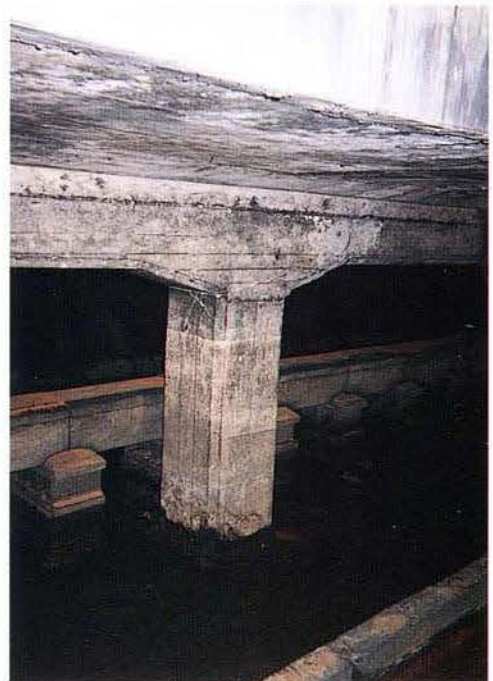
写真3.1-47 プラットホーム支柱頭部 のひびわれ
