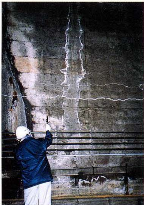
写真 3.1-64 一般路線部・高速長田側 側壁（山側）
