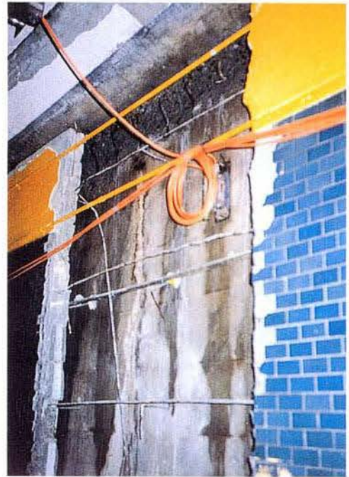
写真 3.1-45 中柱 9付近の側壁（山側）
