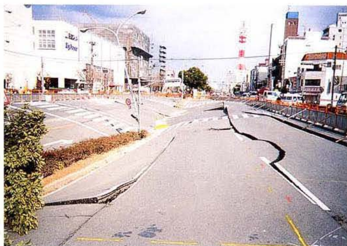
写真 3.1-3 国道28号線路面の陥没状況 (新開地側を望む)
