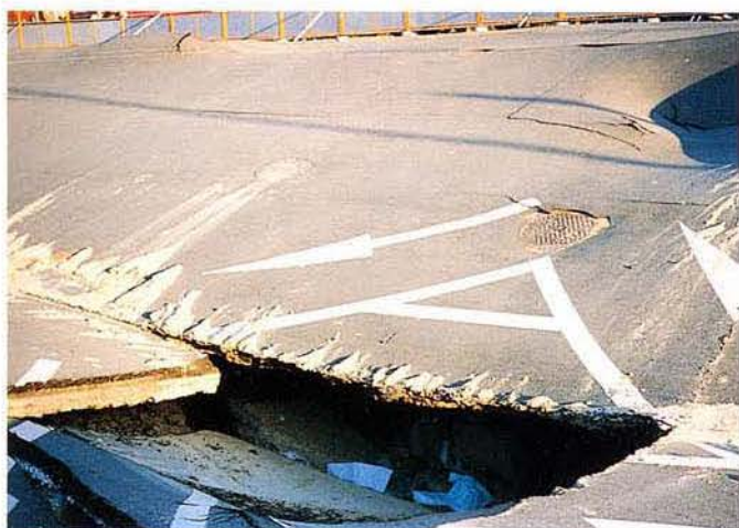
写真 3.1-4 陥没後の路面下の空洞
