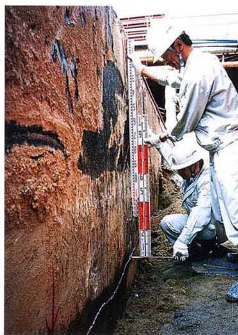
写真 3.1-78 新開地側端付近の側壁外面 に生じたひびわれ（山側）
