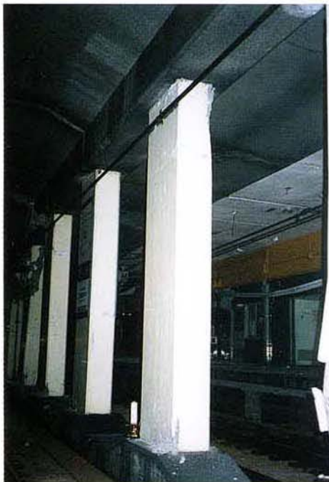
写真 3.1-21 頭部及び脚部の剥離（中柱28）
