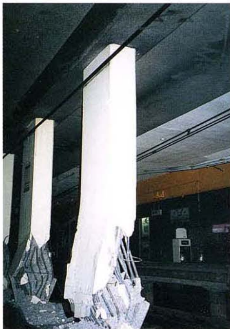
写真 3.1-22 脚部の圧壊（中柱31）
