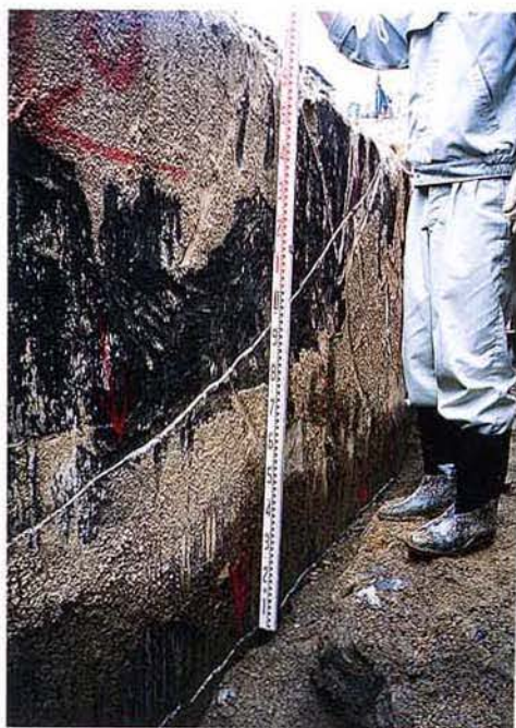
写真 3.1-80 新開地側端付近の側壁外面 に生じたひびわれ（海側）
