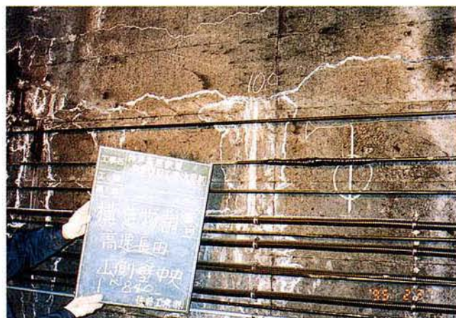
写真 3.1-65 一般路線部・高速長田側 側壁（山側）
