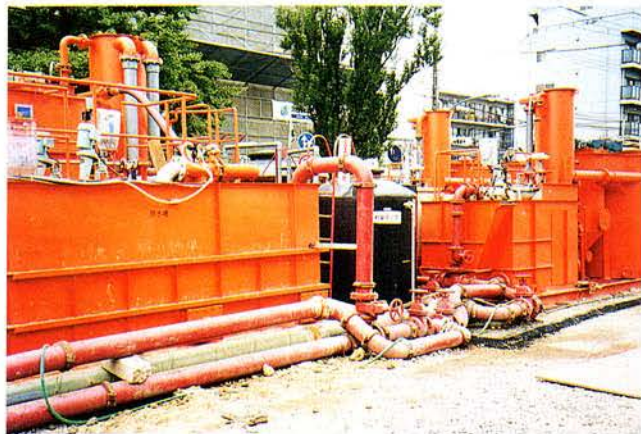
処理プラント
