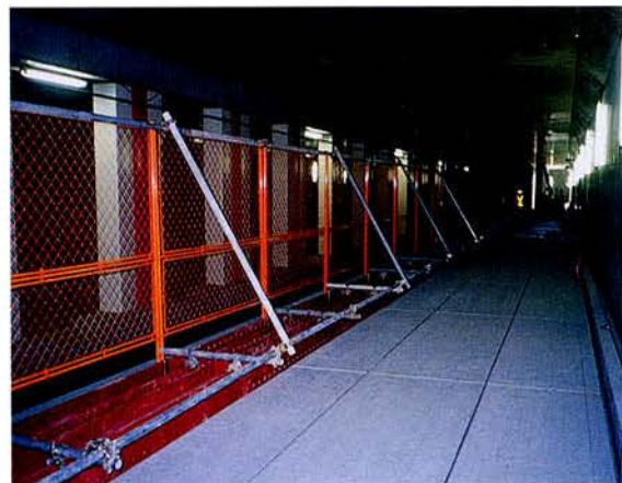
写真 5. 11. 4-2 線路防護網設置状況(2)
