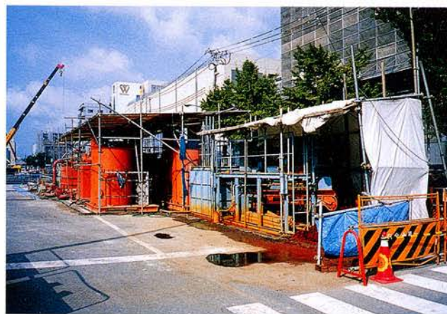
写真 6. 5. 2-1 プラント全景
