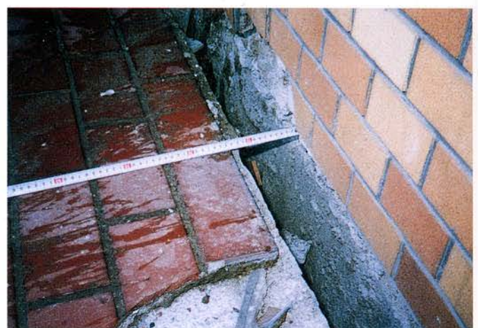
海側(高速長田側端部) 地割れ幅10cm
