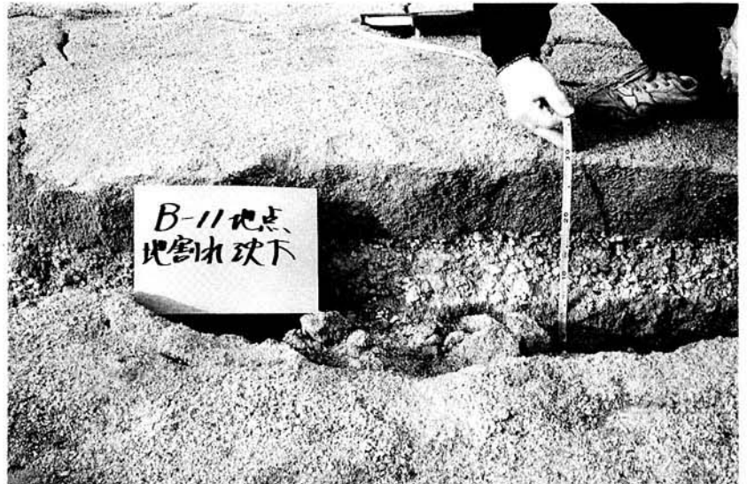
30cm以上の地割れによる段差（B11）
