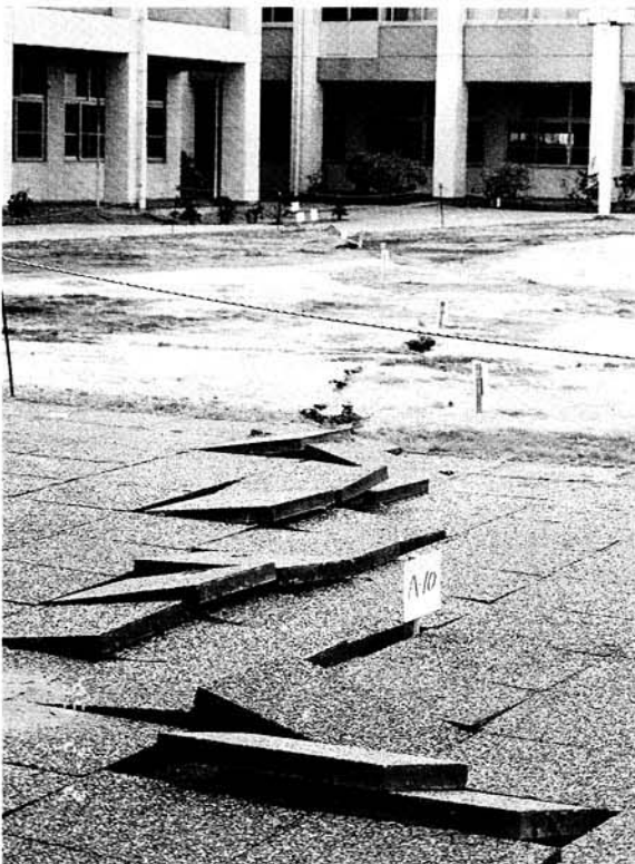
A11からA1方向の地割れ
