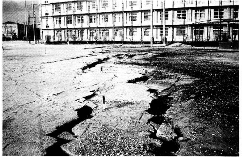
B1からB14方向の地割れ
