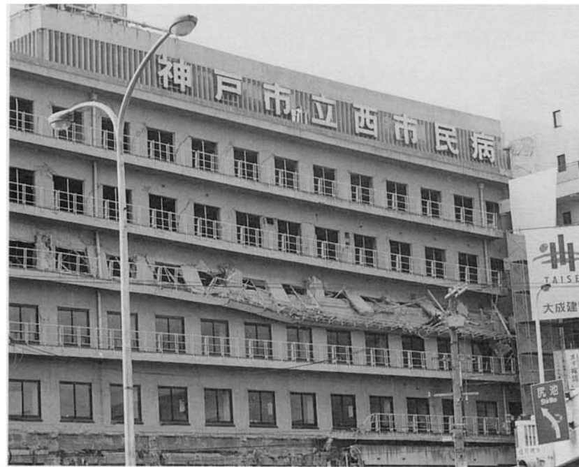
5階が潰れた病院。佐藤君は4階の病室にいた。
