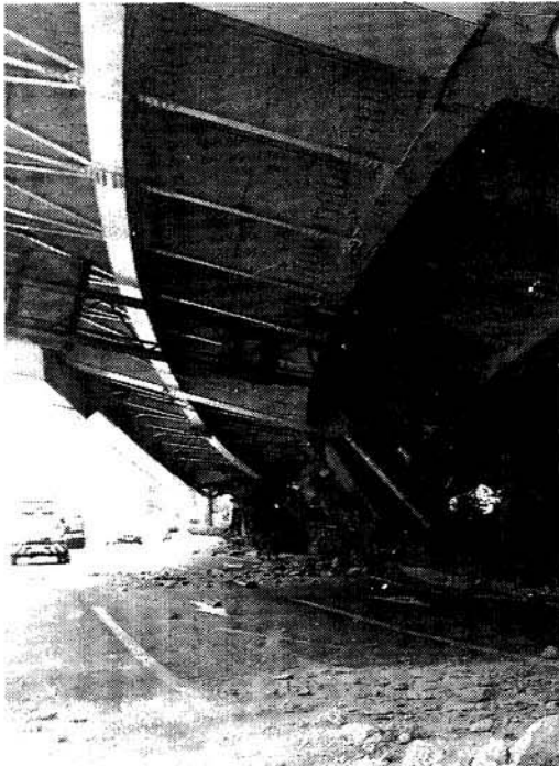
(崩れ落ちた阪神高速道路)
