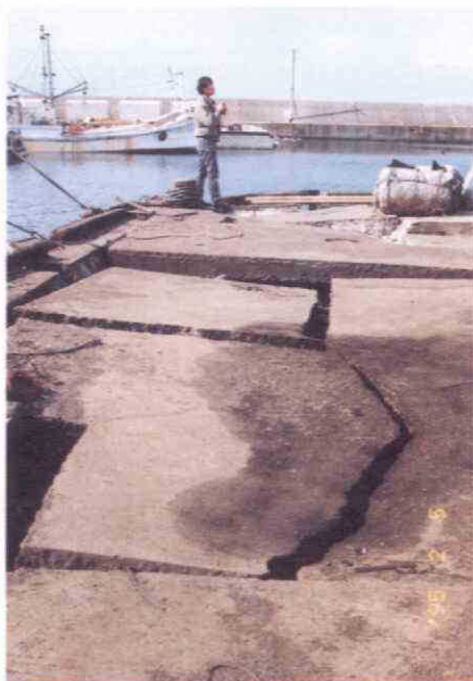
写真4.2-11 江井港の被災
