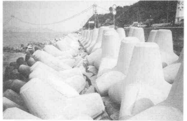
写真 4.1-34 テトラポットの乱れ
