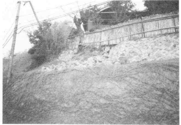
写真 4.1-53 県道山側での変状 石積みが一部崩れている
