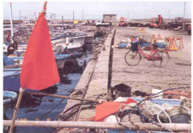
写真4.2-10 直立護岸の被災 (郡家港)
