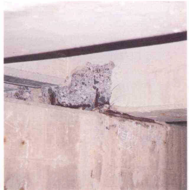
写真4.2-4 支承部コンクリートの破損（野島橋）
