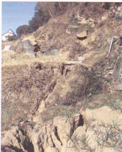
写真 4.1-12 野島断層沿いの被災状況 (野島轟木地区)
