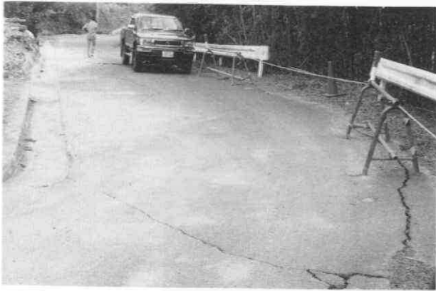
写真 4.1-117 町道を横切る路面の亀裂
