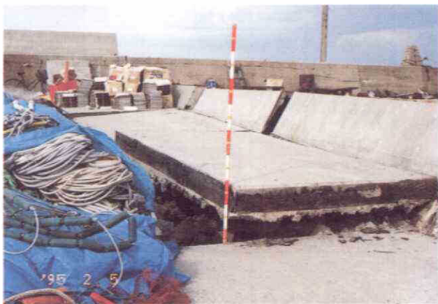
写真4.2-15 護岸背後の沈下（富島港）
