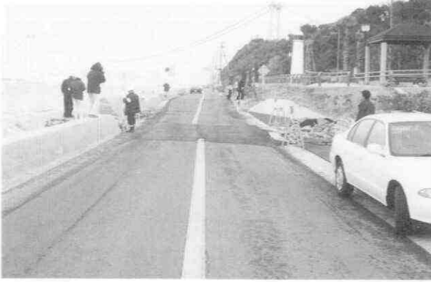
写真 4.1-33 県道センターラインの左横ずれ
