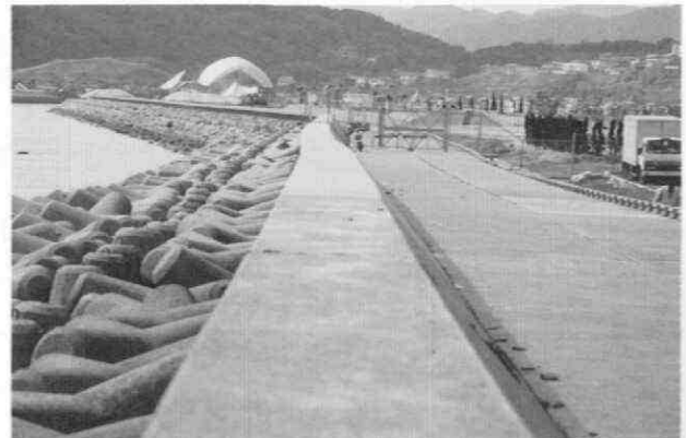
写真 4.1-116 防波護岸の海側(前面)への すべり出し
