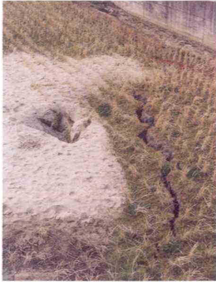
写真 4.1-27 田圃の亀裂と噴砂（松帆地区）
