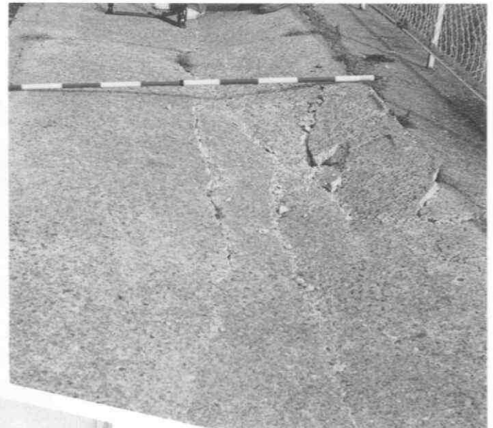
写真 4.1-110 ブロック積擁壁背面の陥没
