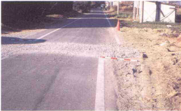
写真 4.1-16 町道を真横に横切る地震断層（小倉地区）
