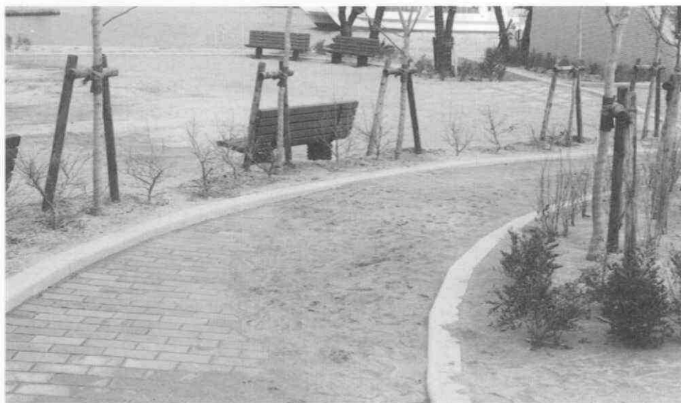
写真4.1-130 噴砂により埋積されたブロック舗装
