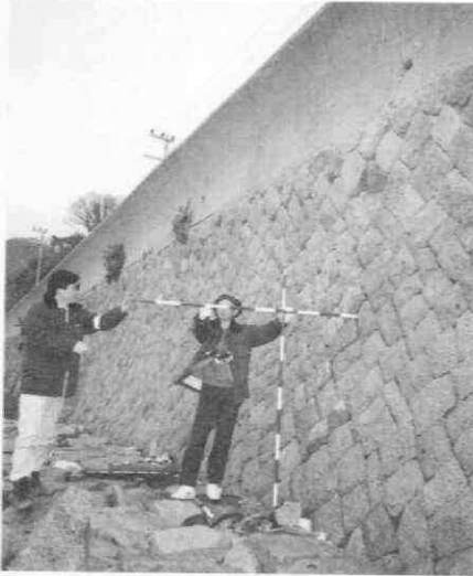
写真 4.1-52 道路護岸の変状 (石積部のはらみ出し)
