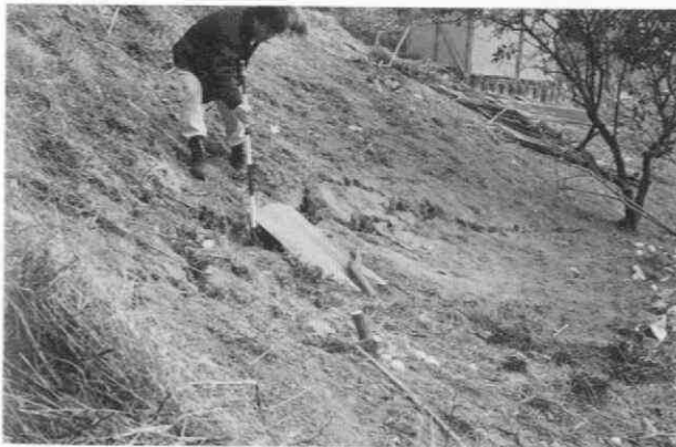
写真 4.1-119 畑地内に発生したクラック
