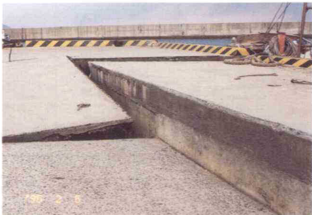
写真4.2-17 護岸背後の沈下（岩屋港）
