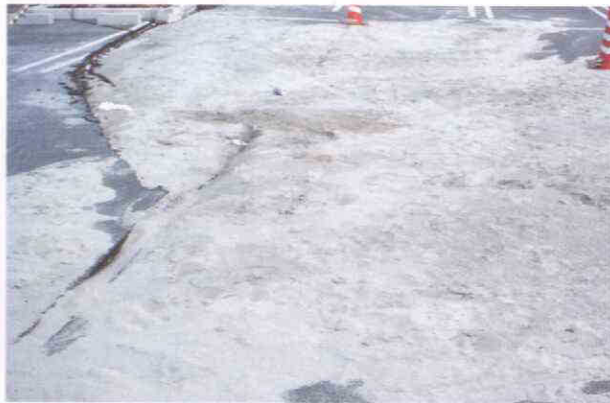
写真 4.1-25 SATY駐車場における噴砂 (志筑新島地区)
