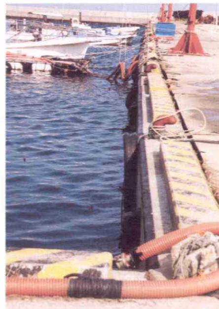
写真4.2-12 室津港の被災①
