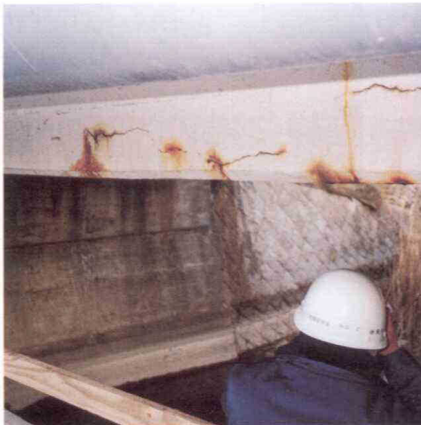
写真4.2-3 鉄筋の発錆（野島橋）
