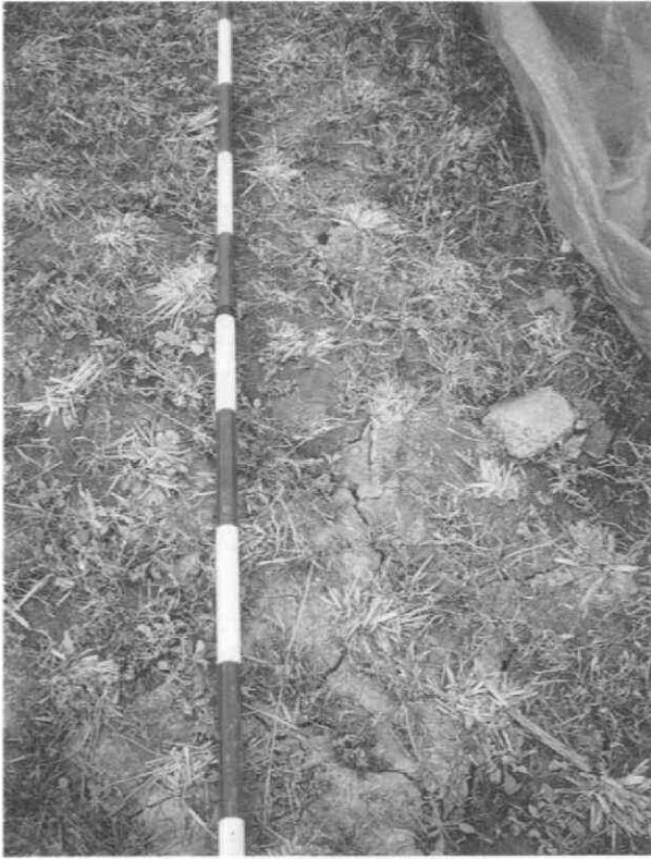
写真 4.1-124 岡田池北側における 水田中の亀裂
