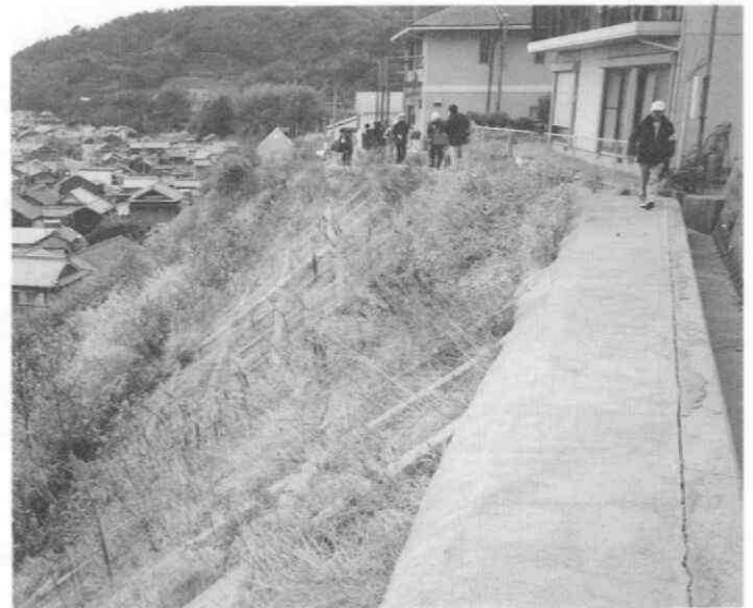
写真 4.1-108 吹付法枠の法肩に発生したクラック
