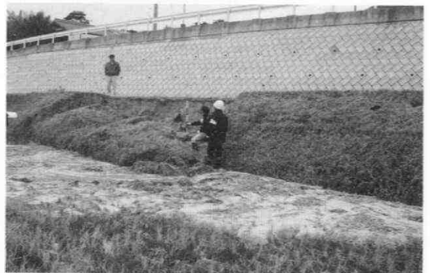
写真 4.1-107 液状化に起因すると思われる小崩壊
