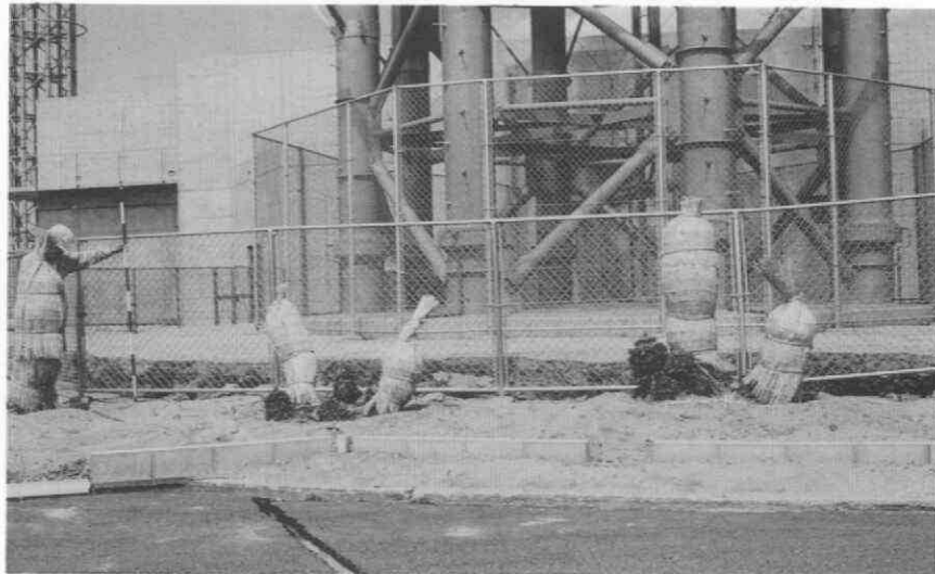
写真4.1-129 送信施設周囲の地盤の沈下
