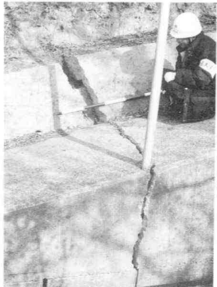
写真 4.1-38 コンクリート構造物の変状
