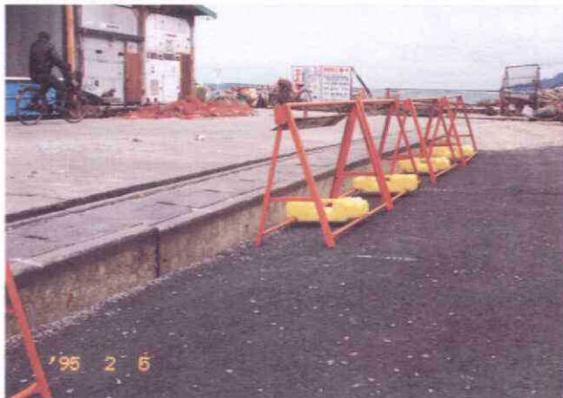
写真4.2-9 漁協前の路面の沈下 (郡家港)
