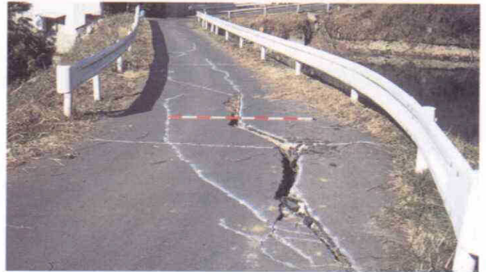
写真 4.1-11 溜池の堤体をかねた町道路路面の 変状 (野島轟木地区)
