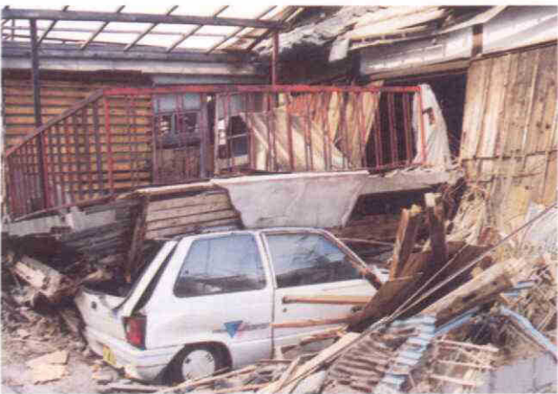
写真4.3-5 北淡町富島地区 建物の倒壊
