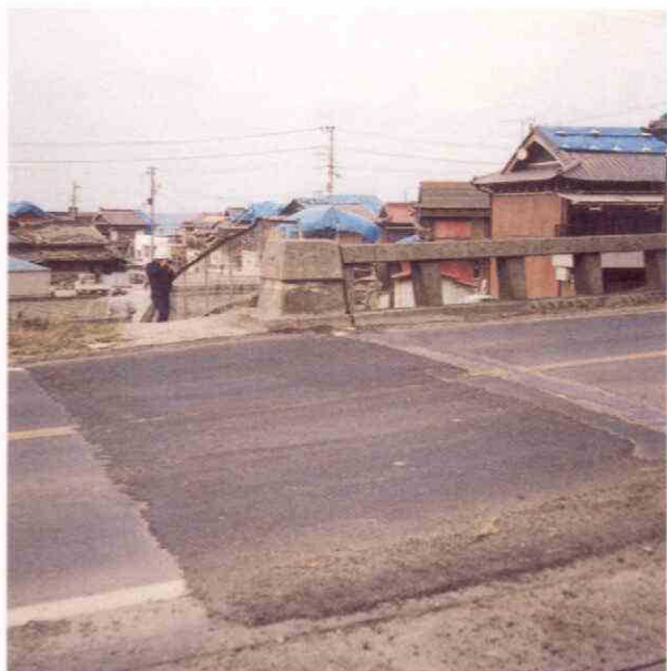
写真4.2-5 取付道路の沈下（新斗ノ内橋）
