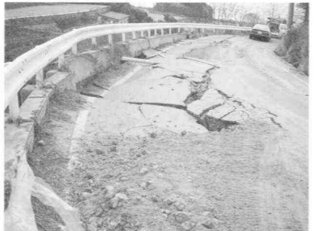
写真 4.1-49 町道の被災状況(路肩の著しい変状)
