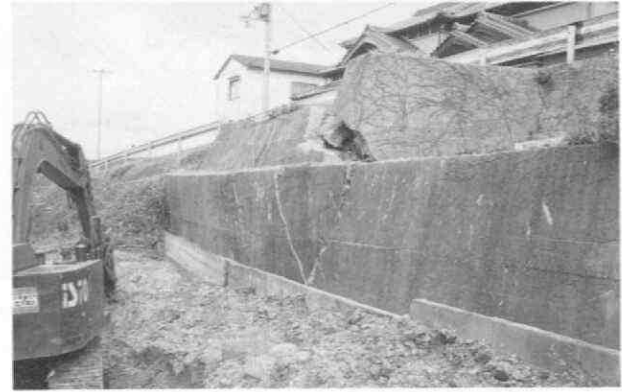
写真 4.1-99 コンクリート壁に生じた変状
