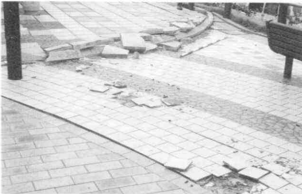
写真 4.1-35 公園施設の変状
