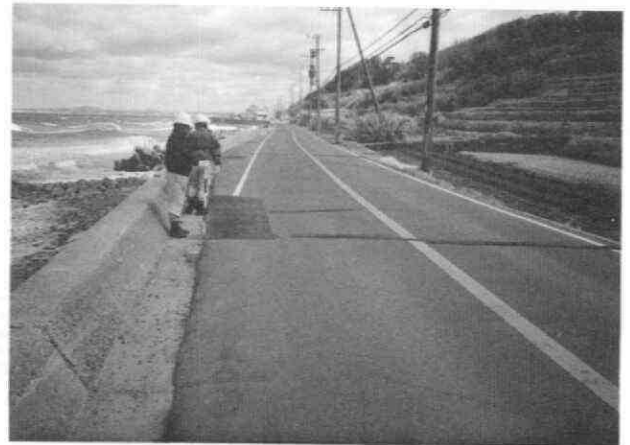
写真 4.1-61 県道路面の軽い沈下とクラック
