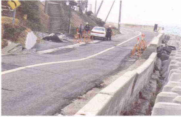
写真 4.1-1 県道と防波堤の被災状況 (野島江崎 江崎灯台地区)
