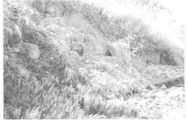
写真 4.1-41 倒壊した小規模擁壁
