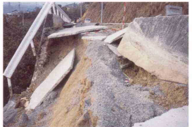
写真 4.1-7 町道の被災状況(路肩の崩壊) (平林地区)
