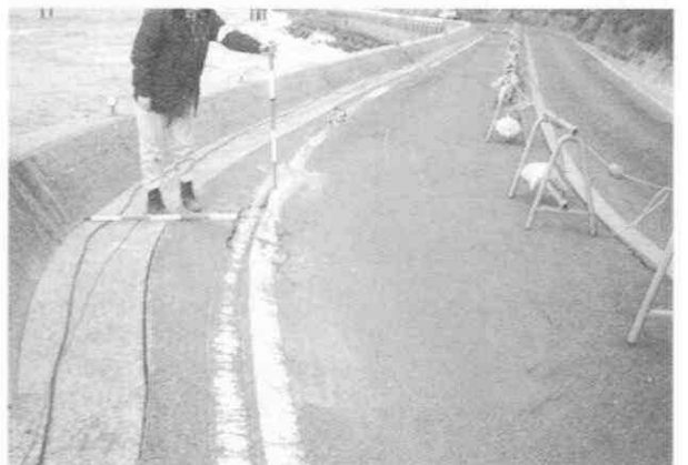
写真 4.1-51 県道路面の沈下(約20cm)
