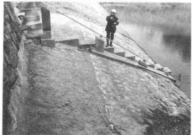
写真 4.1-57 溜池の被災状況
