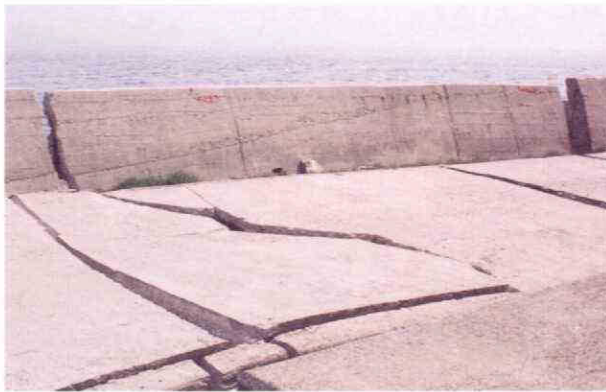
写真 4.1-29 液状化による護岸の変状（大磯地区）
