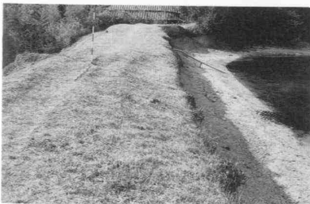
写真 4.1-121 上池の堤体に生じた亀裂
