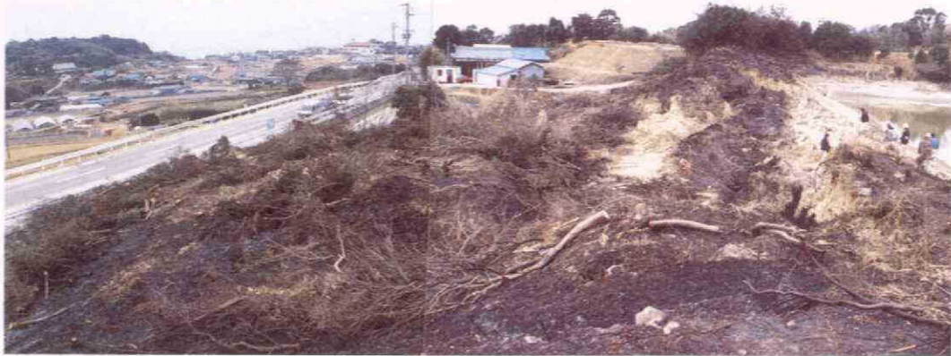
写真 4.1-22 井手の尻池堤体部の崩壊状況 (尾崎地区)
