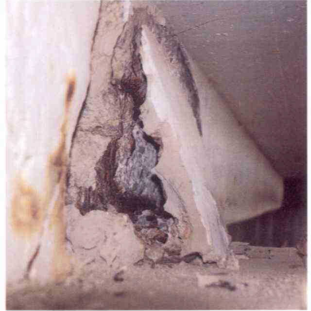
写真4.2-2 R C T桁の損壊（野島橋）
