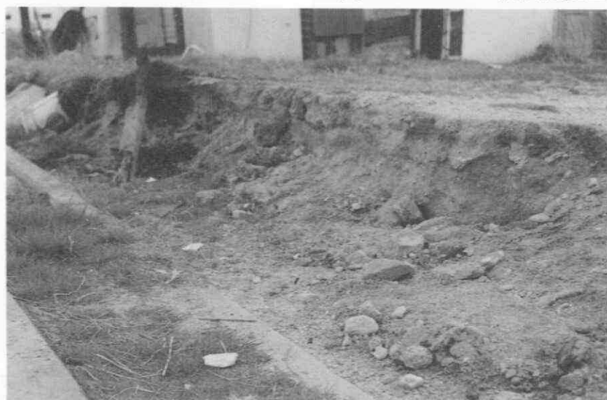
写真4.1-128 護岸背後の沈下(最高30cm)
