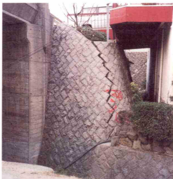
写真4.2-8 石積み橋台の亀裂（橋名不詳）
