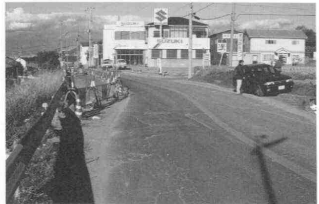
写真 4.1-97 県道を横断する亀裂 (亀裂は補修済み)
