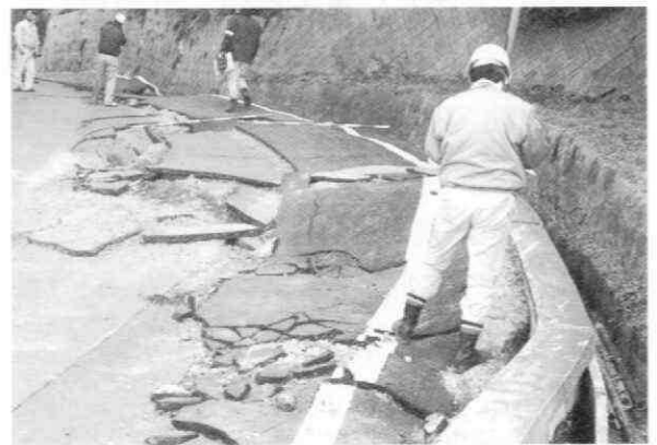
写真 4.1-45 断層沿いの町道の変状
