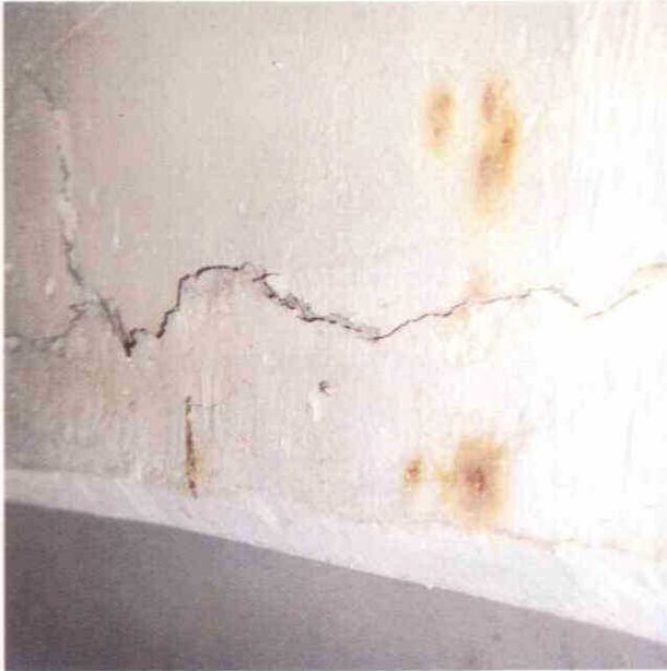
写真4.2-1 R C T桁のひび割れ（野島橋）
