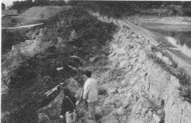
写真 4.1-104 堤体中央部付近における崩壊状況
