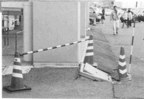
写真 4.1-112、113 建物と地盤の接触部における変状 (地盤の沈下による)
