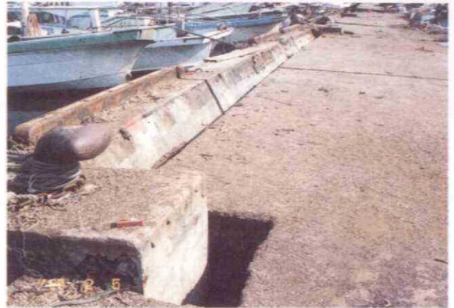
写真4.2-14 直立護岸の被災（富島港）
