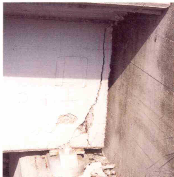
写真4.2-6 支承部コンクリートのひび割れ（新室津橋）
