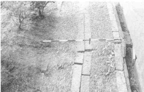
写真 4.1-37 階段状歩道の変状
