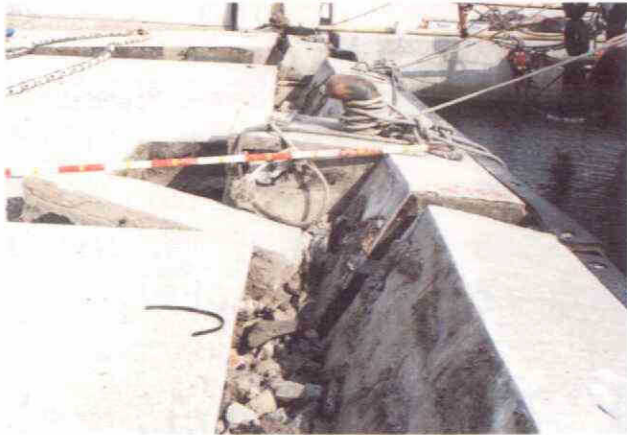
写真4.2-13 室津港の被災②
