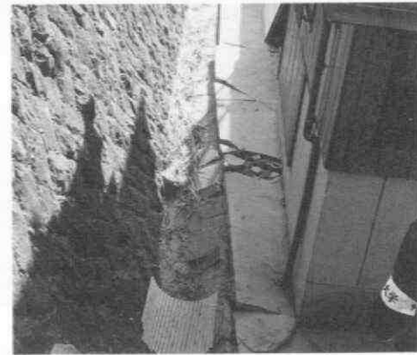
写真 4.1-101 石積擁壁と民家との間に 生じた変状
