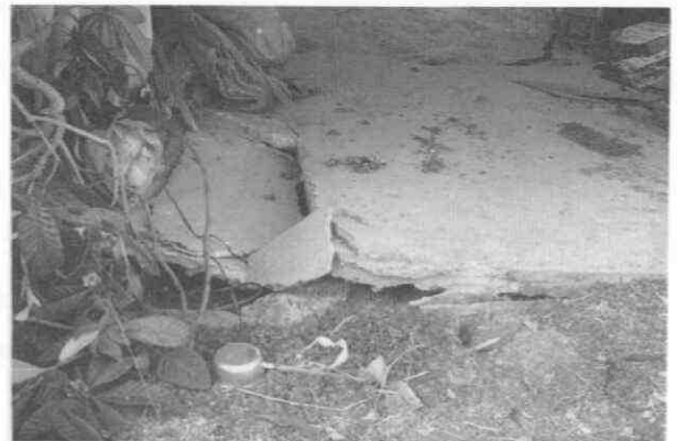
写真 4.1-67 断層運動による鶏舎基礎地盤の変状
