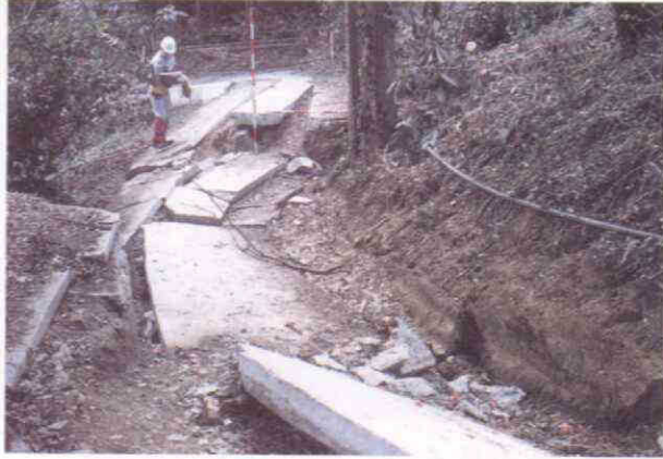
写真 4.1-8 山道の損壊状況 (野島大川地区)
