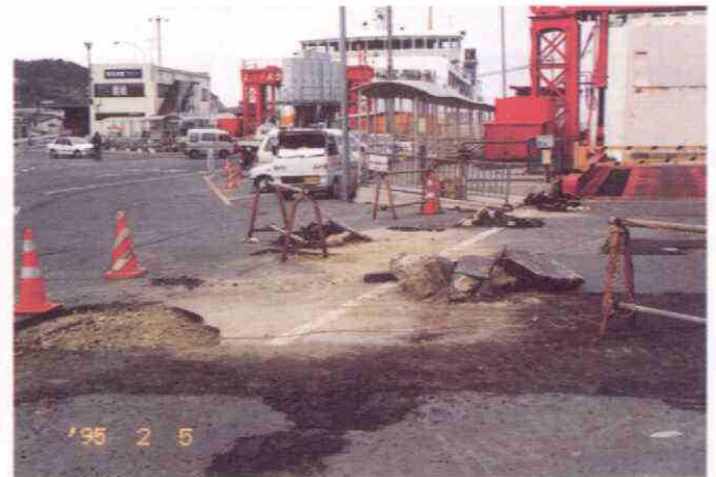
写真4.2-18 棧橋前の舗装面の被災（明石フェリー前）
