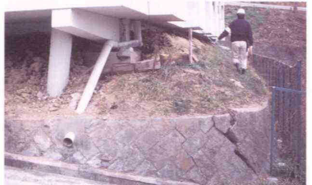
写真 4.1-19 コンクリート法枠工の被災状況（富島地区）
