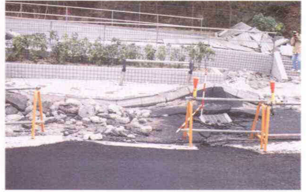
写真 4.1-2 公園施設の被災状況 (野島江崎 江崎灯台地区)
