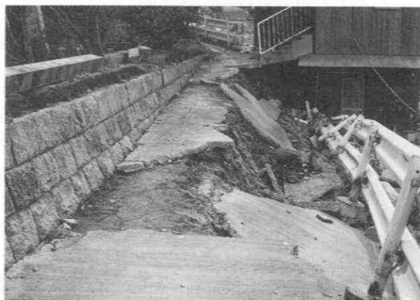
写真 4.1-75 八幡神社前の道路の損壊
