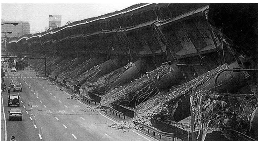
横倒しになった阪神高速道路（神戸市東灘区）
