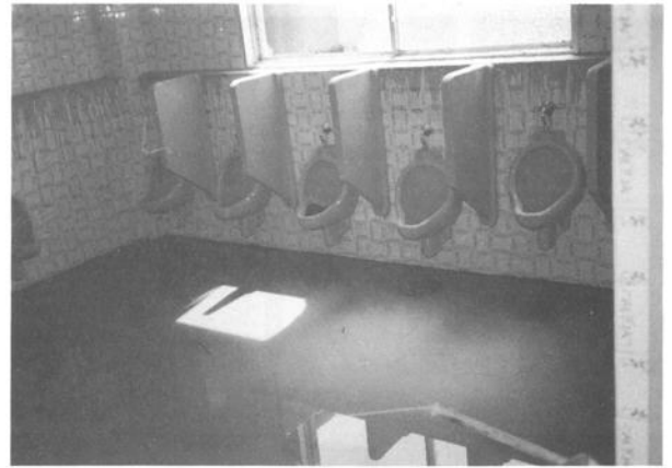
浸水後の男子トイレの風景。トイレの床は水が引き切らず小便器にも冠水して泥等が詰まったままである。
