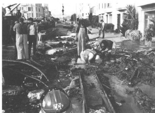
破損した水道管と住民による復旧作業。下水道管やガス管などの地下設備には大きな被害が発生した。
