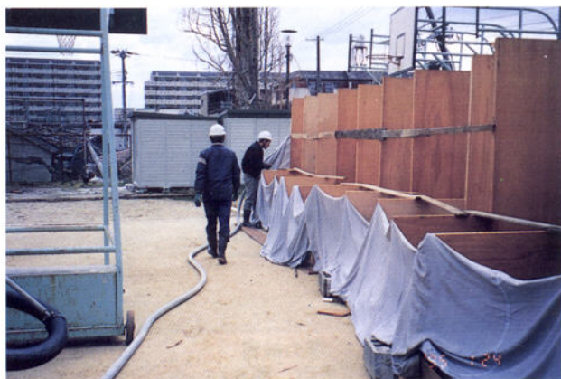
校庭の板囲いの素堀りトイレ (提供：静岡県環境整備事業協同組合)
