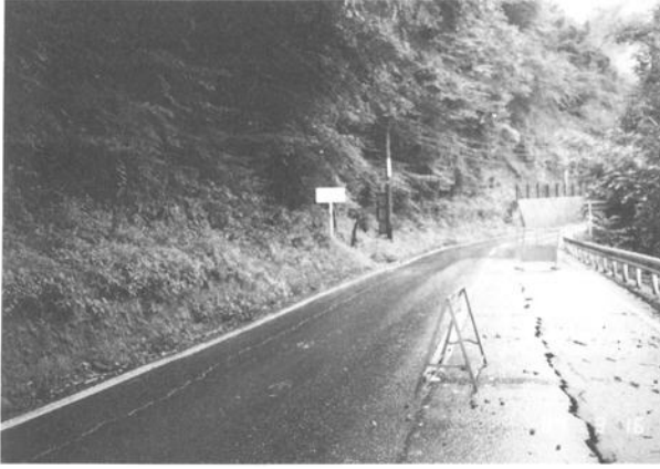
崖側の部分が地割れして道路に亀裂が生じている。
