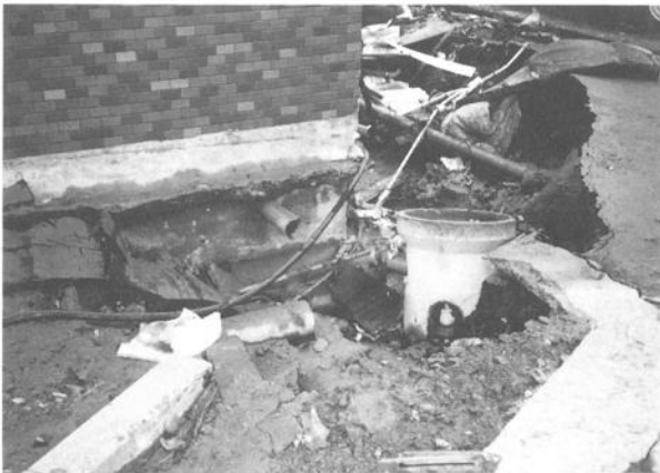
建物周辺のアスファルトや土が剥き出しとなり、下水道管等に破損が見られる。
