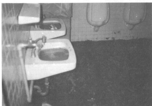
公共建物内のトイレも浸水している。水に運ばれた泥により配水管が詰まって使用できる状態ではない。
