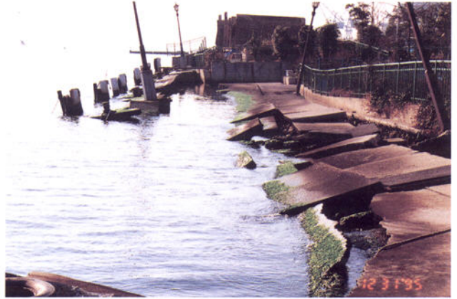
港の被害 (提供：同左)
