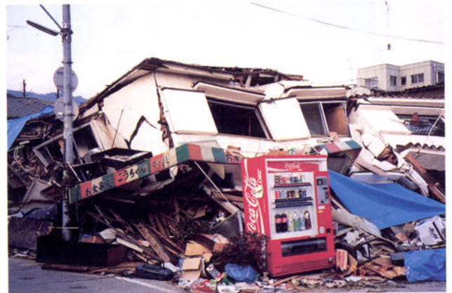
民家の倒壊（神戸市灘区） （提供：同左）
