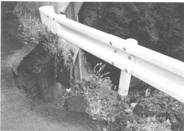
地震動により大きな亀裂が入り道路の一部が崩落している。
