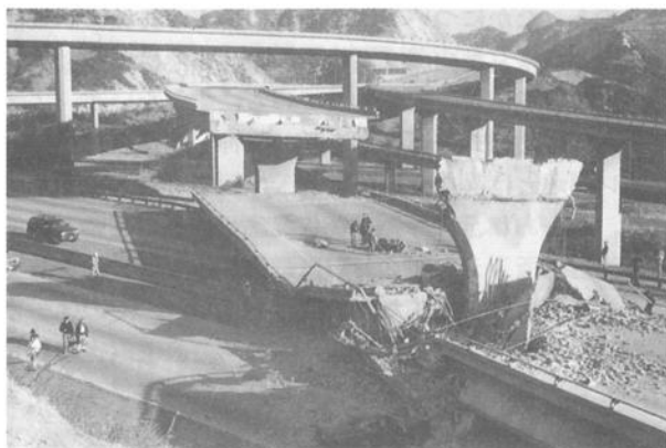
インターチェンジでの落橋崩壊
