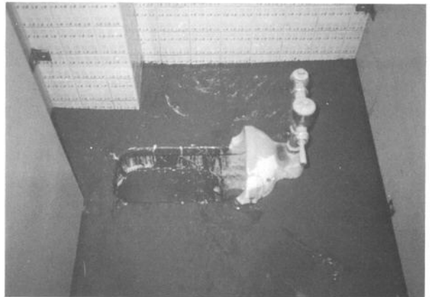
トイレの大便器の中に泥が流れ込み滞留したままである。
