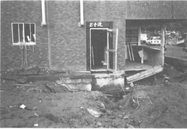
建物の壁や土台が津波によって削り取られ、地下配管等が見えている。
