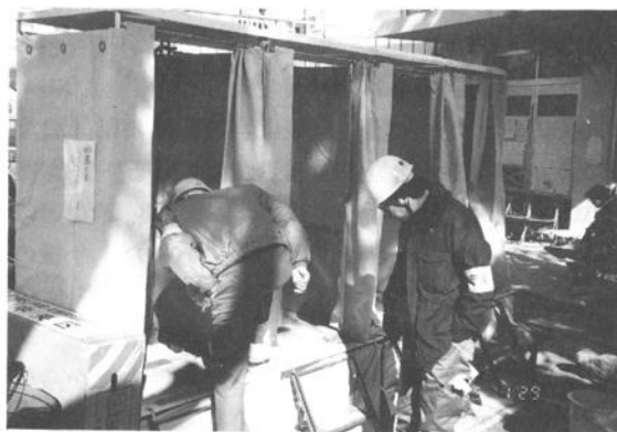
仮設トイレの点検（小黒小学校にて） （提供：静岡県環境整備事業協同組合）
