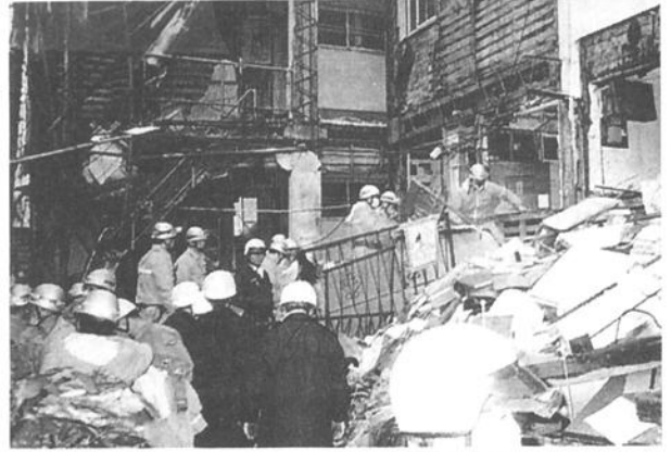
倒壊家屋の救助活動（写真提供：西宮市）
