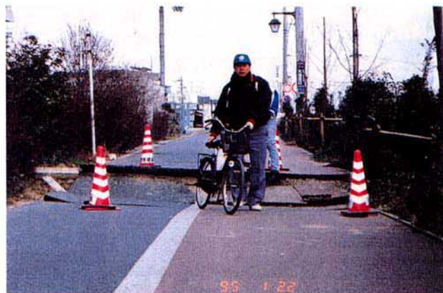
写真4.2.28 歩道部の段差約30cm
