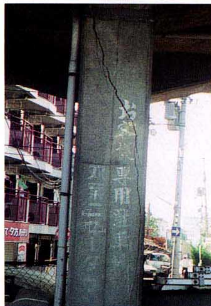
写真3.2.17 せん断ひびわ れ
