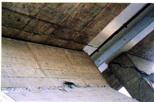
写真4.2.6 名神高速道路壁式橋脚の被害
