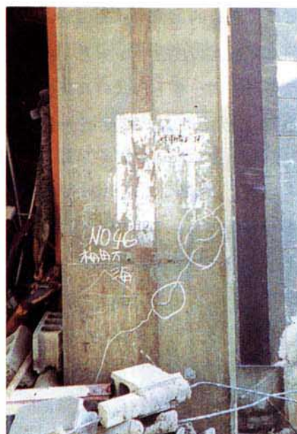
写真3.2.16 軽微なせん断 ひびわれ
