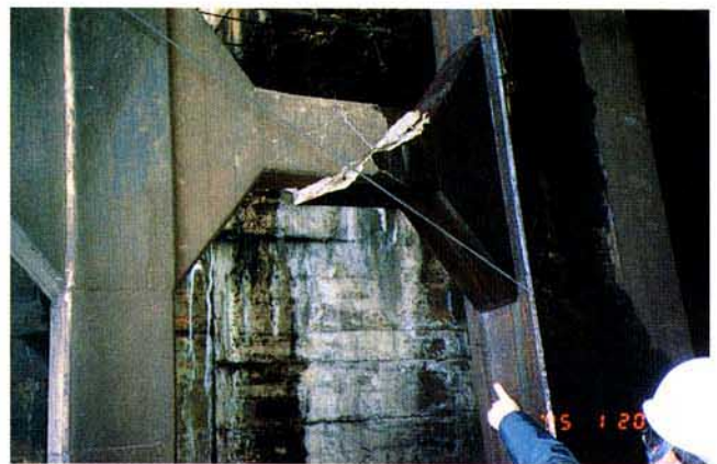
写真4.3.44 ラーメン横梁部のせん断破壊
