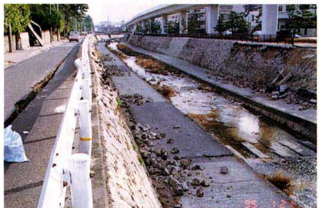
写真4.2.39 堤防道路石積の崩壊と道路部の被害
