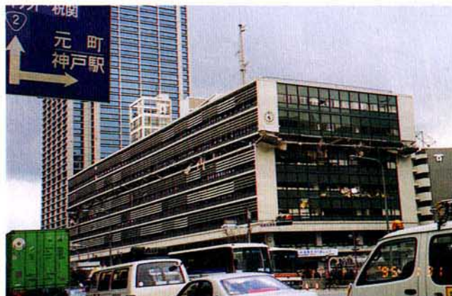
写真1.1.12 6階部分が圧壊した神戸市役所旧館ビル
