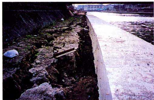
写真5.3.5 鋼管背面の沈下と鋼管の傾斜
