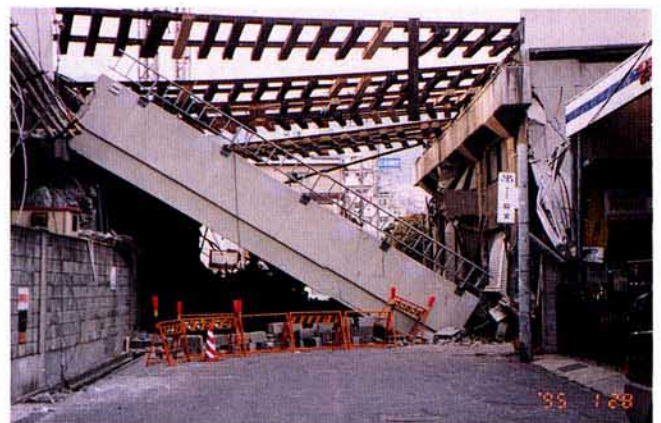
写真3.2.39 車庫内架道橋のPC桁の落下
