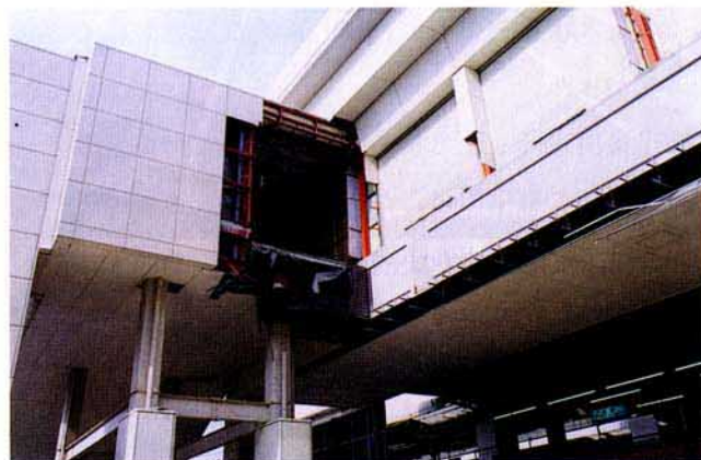
写真3.2.89 自由通路との接続部の被害
