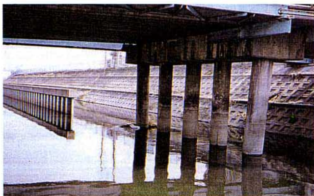
写真4.3.21 傾斜したパイルベント橋脚
