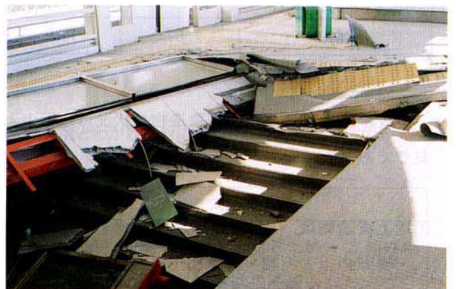
写真3.2.96 階段廻りの手摺壁倒壊
