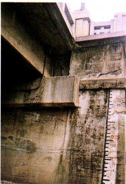
写真4.3.7 同上（橋台パラ ペットの亀裂）
