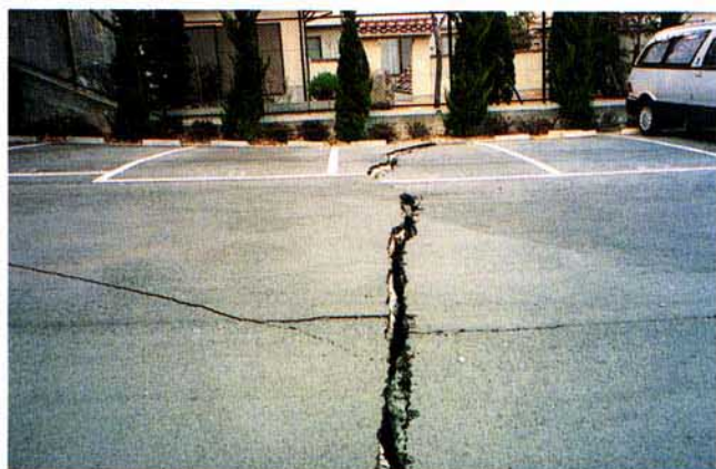
写真2.3.6 重力性の地盤変位による亀裂
