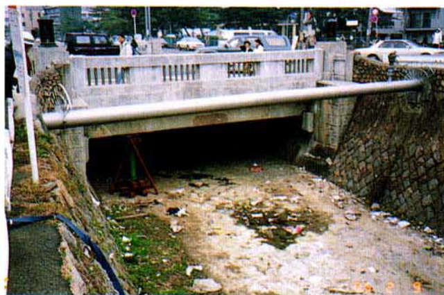
写真4.3.9 同上（桁端部の剝離とクラック）
