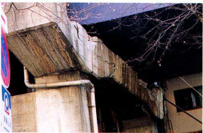
写真3.2.44 ラーメン橋台の桁受部の被害
