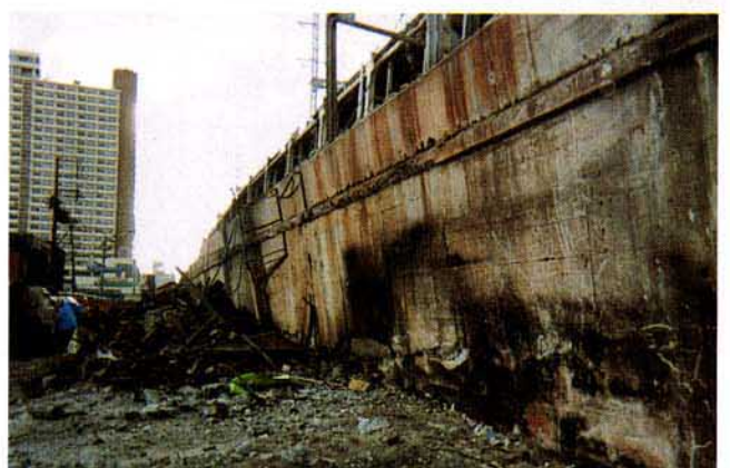
写真3.2.72 盛土高架区間の線路の被害
