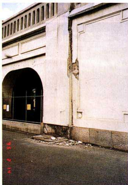
写真4. 3. 12 同上（擁壁継目 部の欠落）
