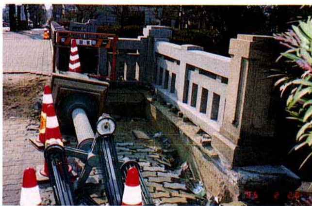
写真4.3.5 単径間橋梁の被害例（橋面損傷）
