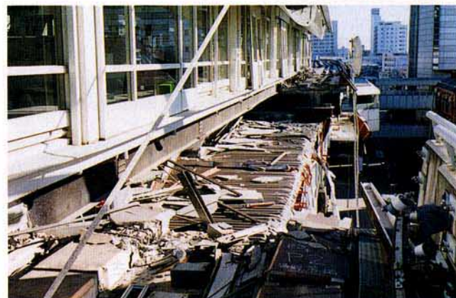
写真3.2.90 軌道桁落下によるコンコース屋根の変形
