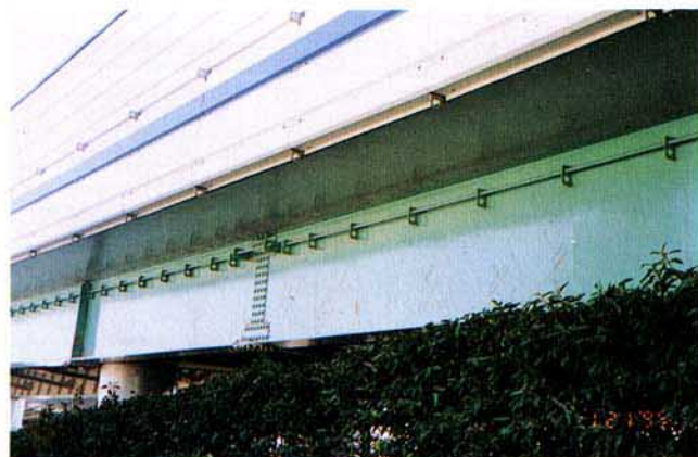
写真4. 2. 34 主桁（腹板）の座屈による斜め45° 方向 の塗装のはがれ
