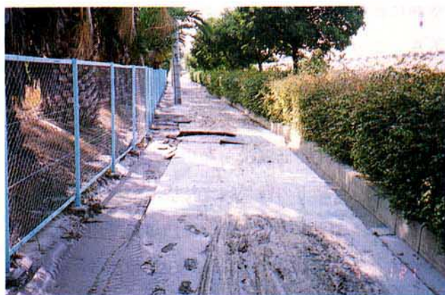
写真4.2.2 自転車・歩行者専用道路に噴出した大量の土砂
