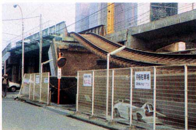
写真3.2.14 下り線のみ倒壊したラーメン高架橋
