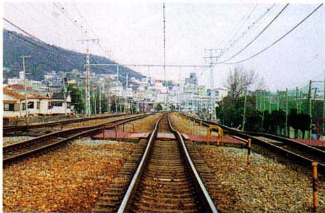
写真3.2.67 JR摂津本山～住吉間 盛土法面崩壊箇所の線路変状
