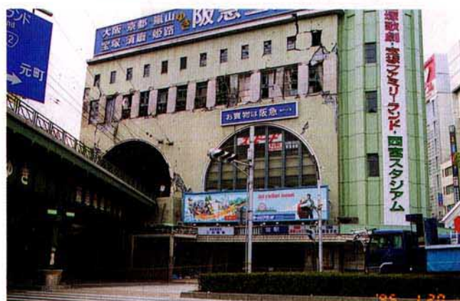
写真3.2.21 三宮駅 東館ビルの被害
