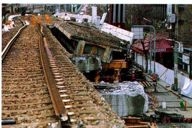
写真3.2.47 桁式高架橋落下寸前のPC桁
