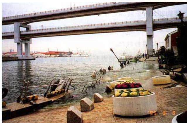
写真1.1.4 側方移動と沈下で海中に没したハーバーランド西側の護岸
