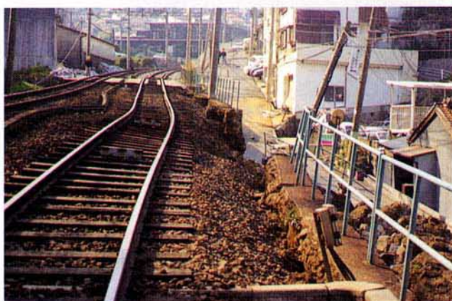
写真3.2.77 土留擁壁・盛土の崩壊と軌道の変状
