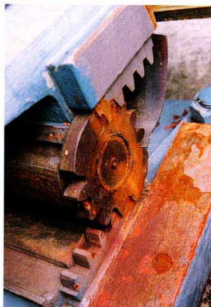
写真4.3.18 橋梁支承の破損
