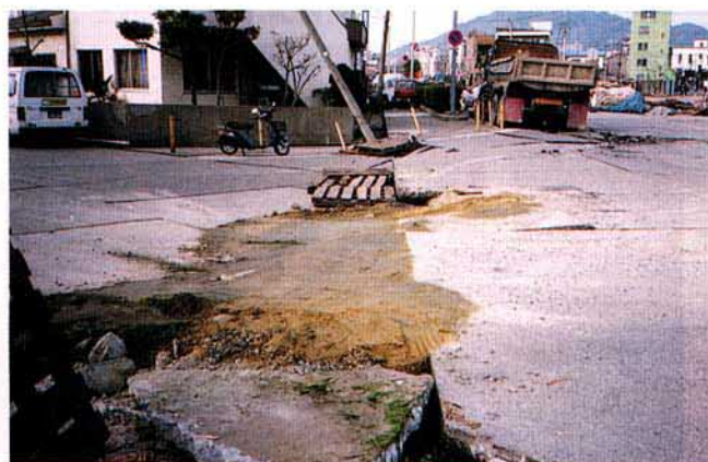
写真4. 2. 59 コンクリート舗装版の被害
