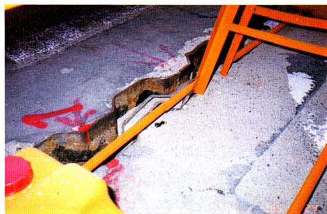
写真4.3.51 旧橋台の沈下による縦目地部の段差
