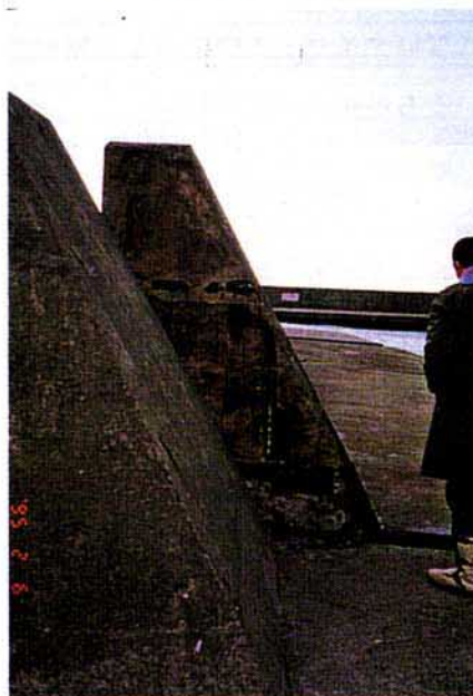
写真5.2.8 ケーソンの沈下 によるパラペ ットの目違い
