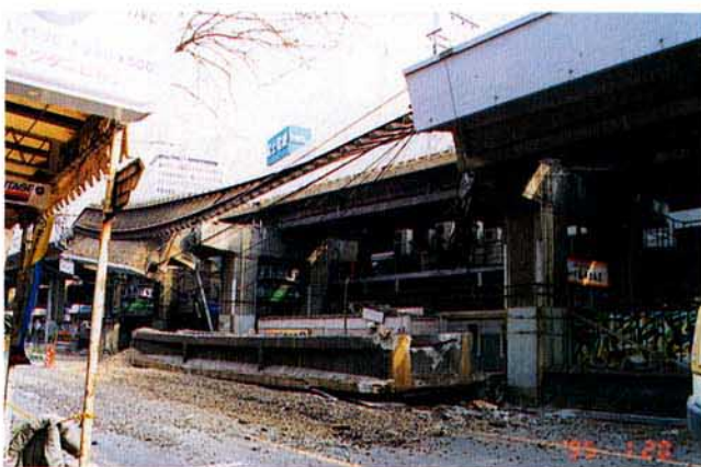
写真3.2.48 同上 PC桁の落下
