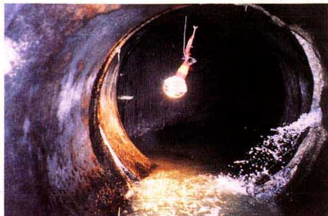
写真6.2.5 伏越し管渠の破断
