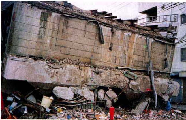
写真3.2.29 架道橋の桁受部の崩壊
