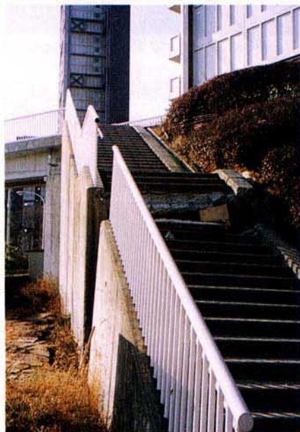
写真4. 2. 30 歩道橋階段部取 付け擁壁の沈下
