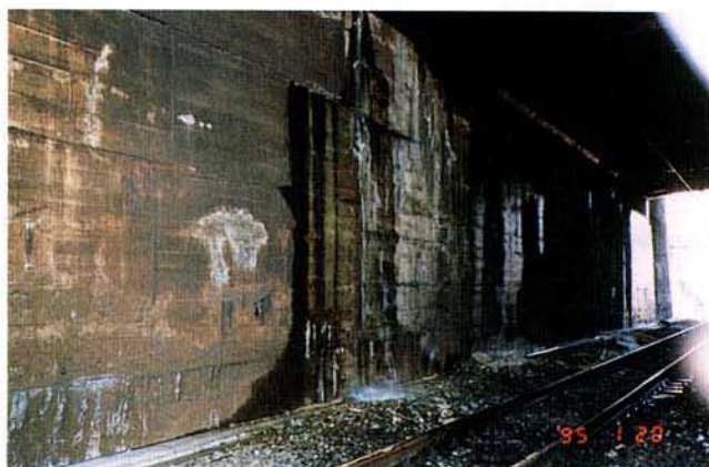
写真4.3.42 橋台前面からの漏水
