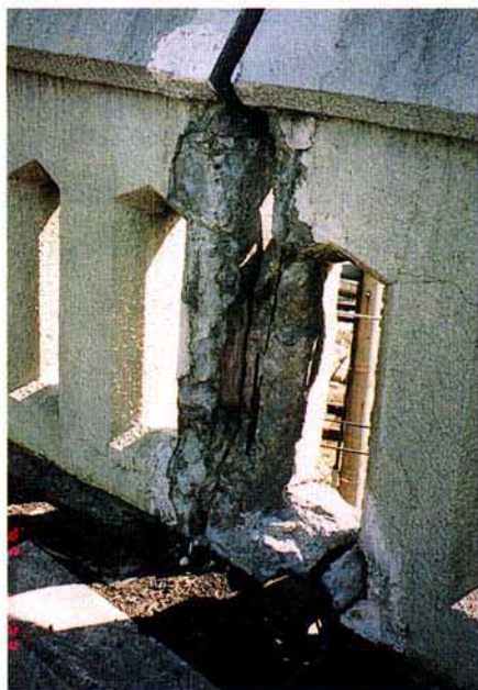
写真4. 3. 11 単径間橋梁の被害例（RC高欄 の欠落）
