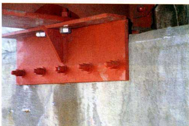
写真4.3.62 緊急に設置された落橋防止装置
