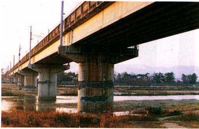
写真3.2.6 桁式橋梁橋脚の被害
