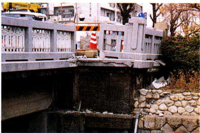
写真4.3.6 同上（コンクリート高欄損傷）
