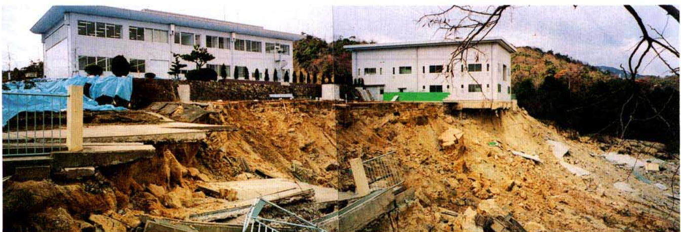
写真2.3.5 地すべり地上部の滑落崖
