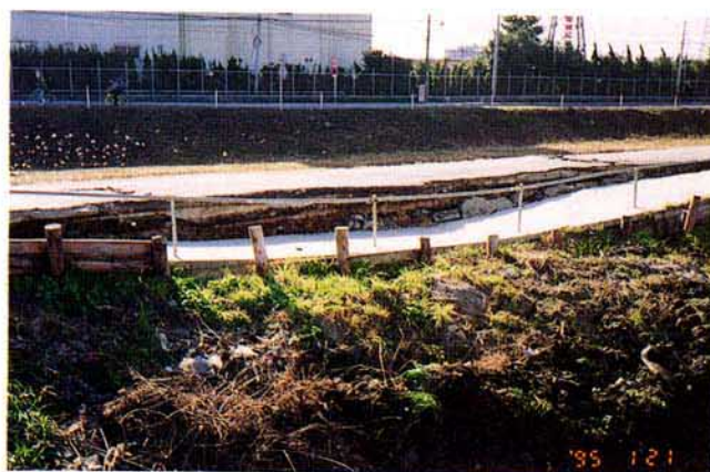
写真4.2.8 盛土法面の崩壊と路面の陥没
