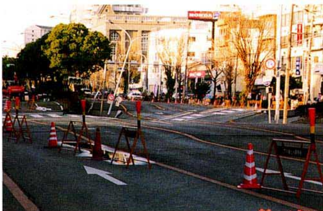
写真4. 2. 58 損壊した地下鉄駅直上の路面陥没
