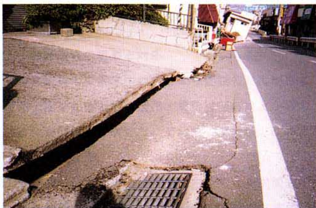
写真4.2.1 平面道路の段差
