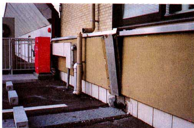
写真3.2.80 パラペット及び排水管の破損
