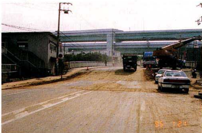
写真4.2.36 橋梁取付部の段差
