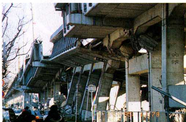
写真3.2.3 二層ラーメン高架橋の被害
