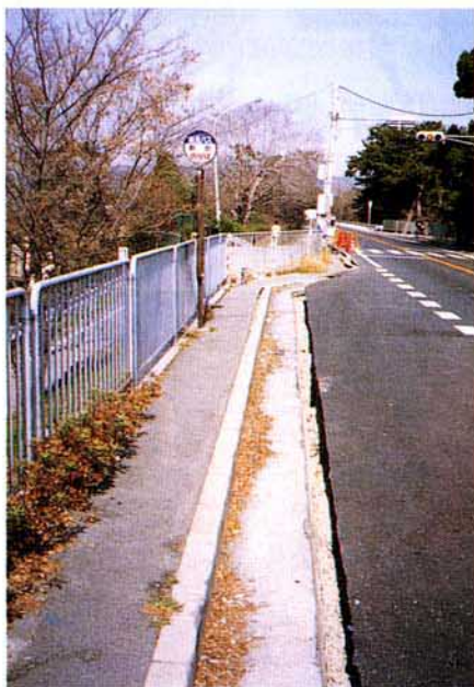
写真4.2.12 堤防道路の亀裂
