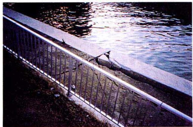
写真5.3.4 笠桁コンクリートのクラック
