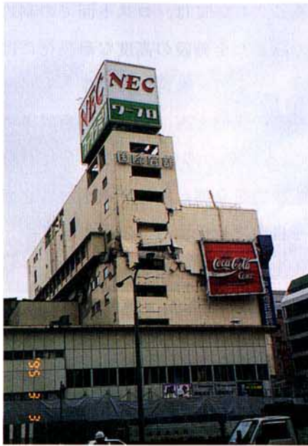
写真1.1.14 中間階層が破壊した国際会館ビル
