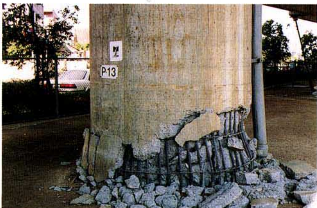
写真4.3.33 橋脚基部の被災状況
