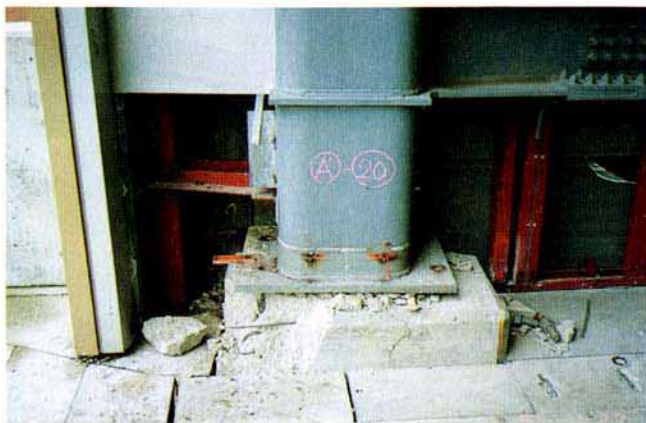
写真3.2.84 角型柱基礎のアンカーボルトの破断
