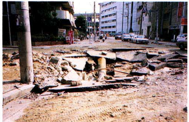
写真4.2.49 平面道路の被害
