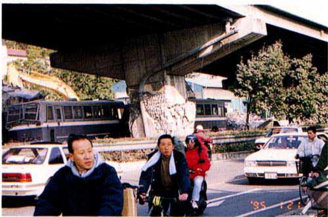
写真4.2.48 阪神高速道路橋脚の被害
