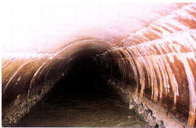
写真6.2.3 ヒューム管の縦断方向クラック
