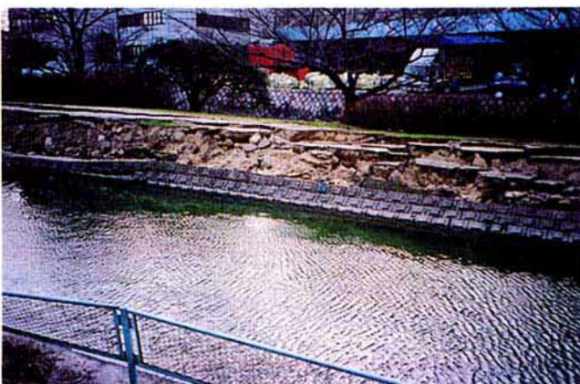
写真5.3.1 ブロック積護岸の崩壊
