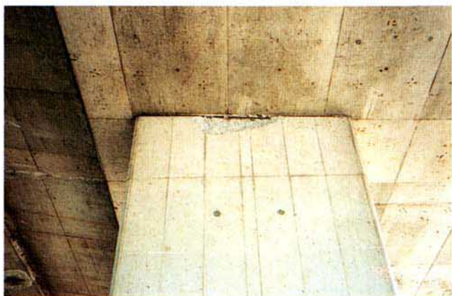
写真4.2.23 橋脚上部コンクリート剝離
