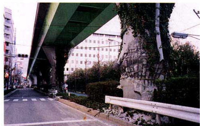
写真3.2.57 同 RC橋脚の被害
