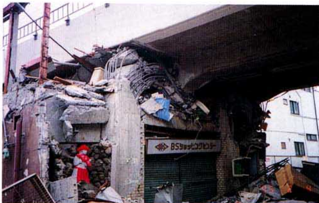
写真3.2.31 高架橋柱上部の破壊
