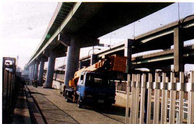
写真3.2.58 ポートアイランド島内 直接基礎区間の橋脚の傾き
