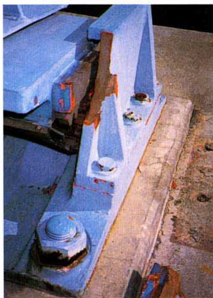
写真4.3.19 橋梁支承の破損
