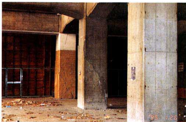
写真3.2.42 ラーメン高架橋支柱のひびわれ
