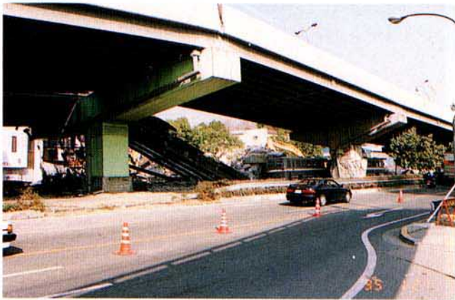
写真4.2.47 阪神高速道路ランプの桁落下
