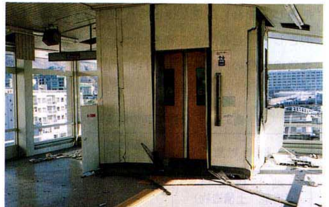
写真3.2.95 エレベーター付近の内装材破損
