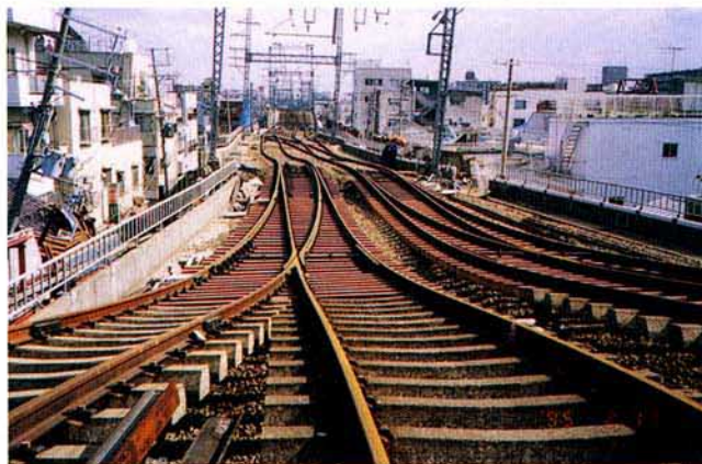
写真3.2.27 阪神電鉄本線 軌道部の変状
