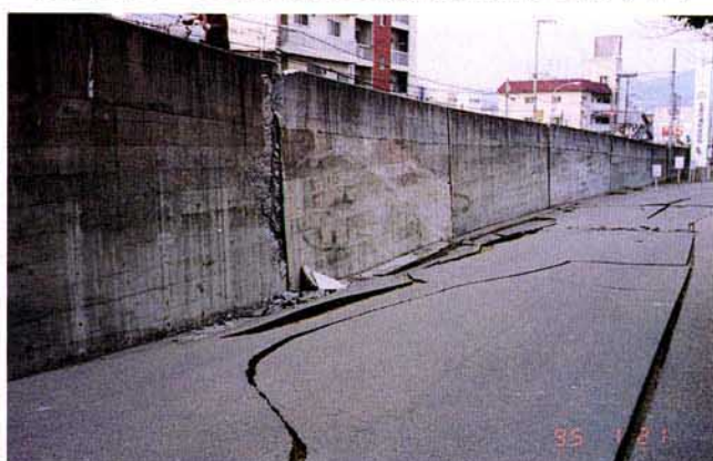
写真4.2.21 擁壁部の破損、及び歩道部の隆起
