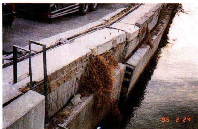
写真4.3.48 取付け護岸の変位
