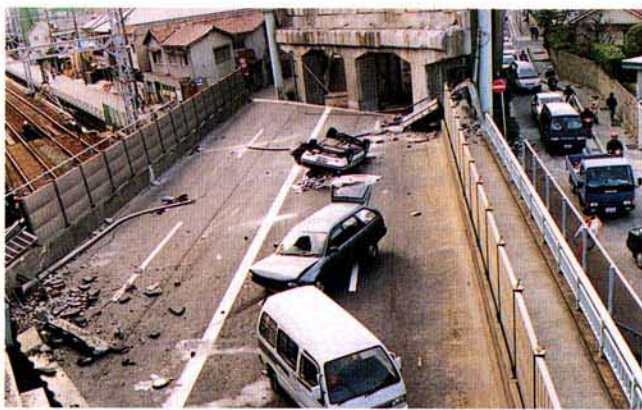
写真4.3.32 落橋した跨線橋部
