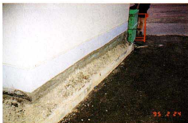
写真4.3.49 周辺地盤の沈下
