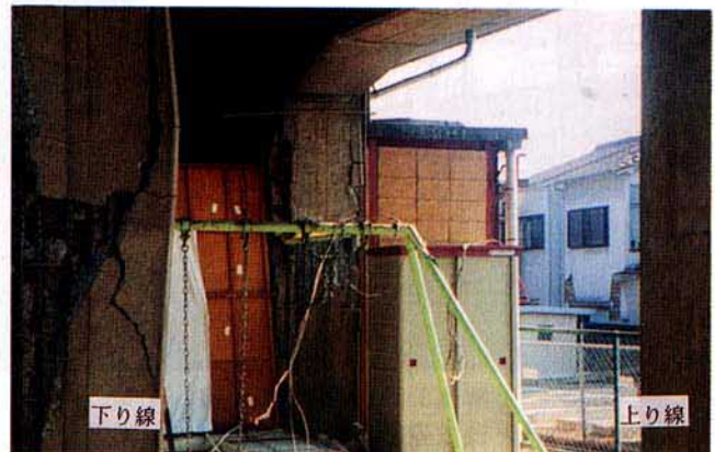
写真3.2.11 上下線支柱の典型的なせん断破壊
