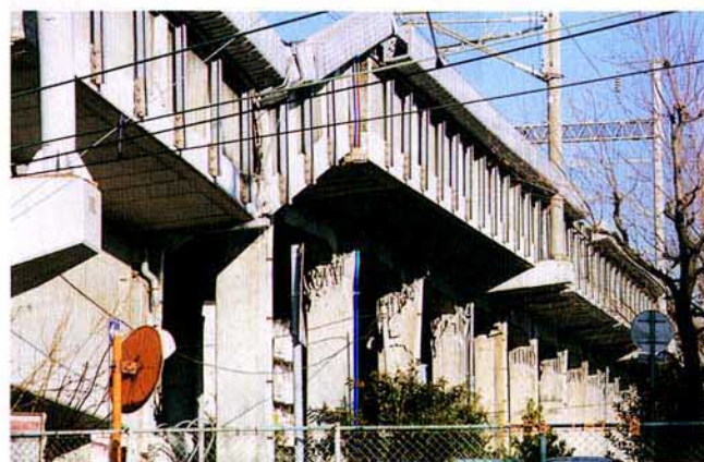
写真3.2.5 一層ラーメン高架橋の被害
