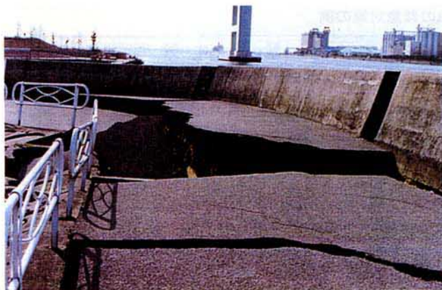
写真5. 2. 9 埋立地角部での破損
