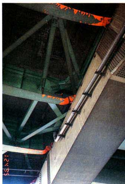
写真4. 3. 26 桁端部の大変形 により落橋の恐れのある上部工 (対策前)
