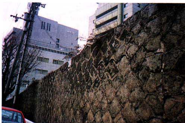
写真4.3.63 石積擁壁部の破損
