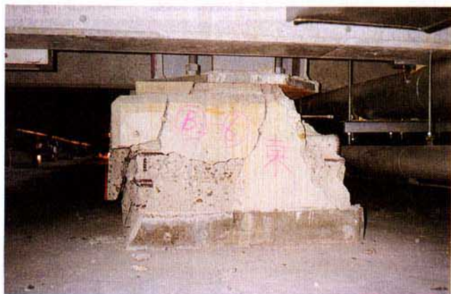
写真3.2.83 ホーム下クロスH型柱基礎の被害
