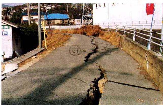
写真4.2.22 長い区間に渡る地割れ
