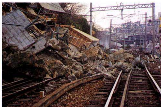
写真3.2.76 神戸電鉄湊川～長田間 切取法面の崩壊
