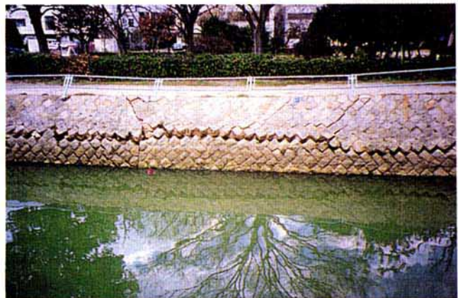
写真5.3.3 不同沈下による亀裂
