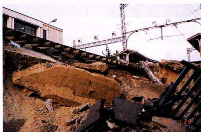
写真3.2.75 駅部擁壁の崩壊
