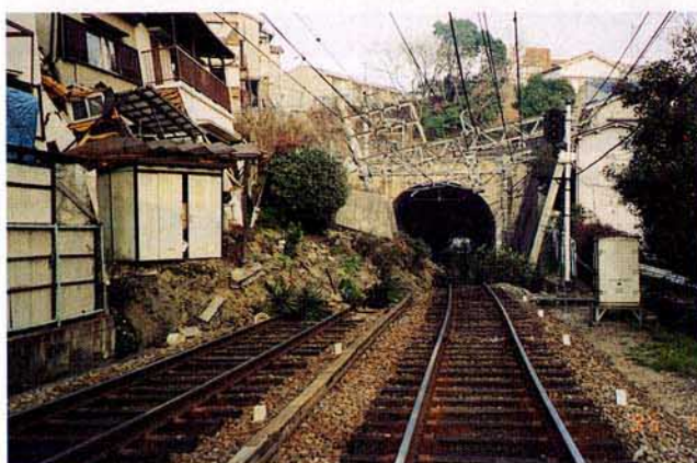
写真3.2.78 トンネル坑口付近の被害
