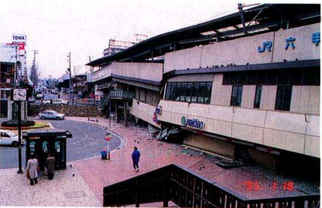
写真3.2.9 駅部ラーメン高架橋・駅舎・ホーム・ 上家の被害
