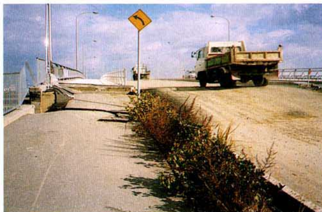
写真4.2.14 橋梁取付部の段差
