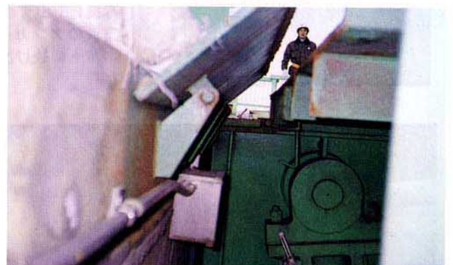
写真4.3.58 跳ね上がった伸縮装置
