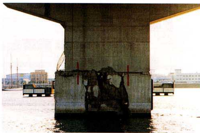
写真4.3.37 P3可動橋脚の損傷
