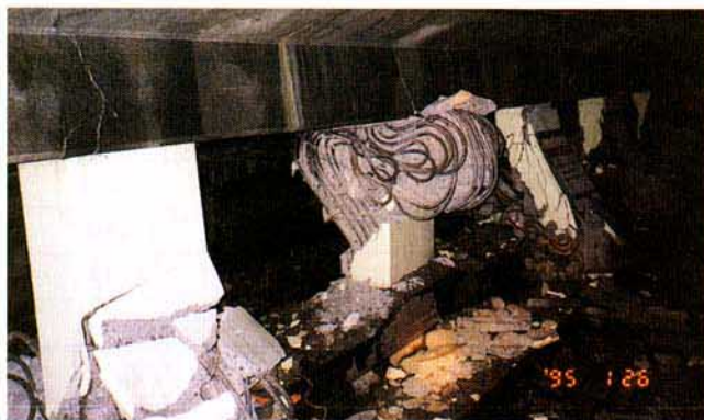
写真3.2.51 同 地下2階中柱の被害
