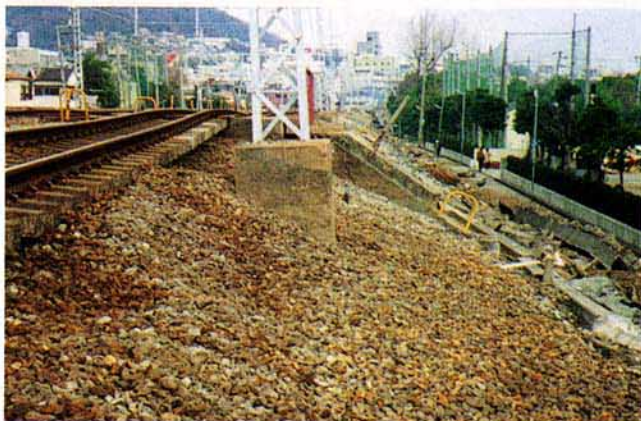
写真3.2.68 法面が崩壊し道床バラストが流出
