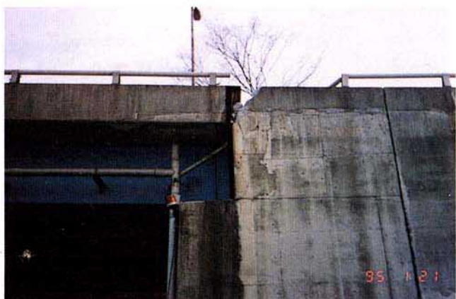
写真4.2.24 擁壁一部破損
