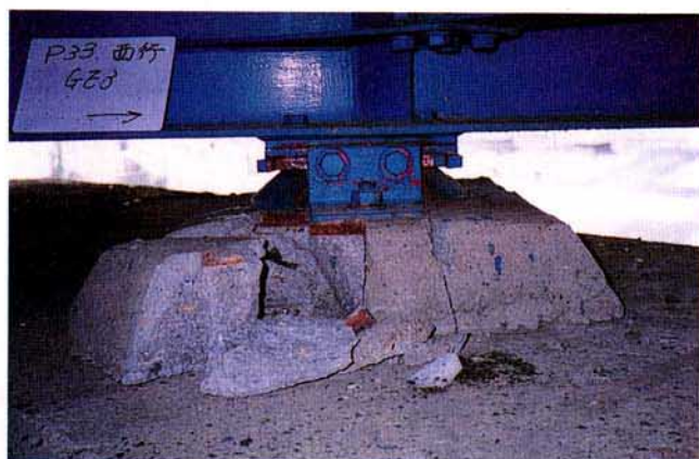
写真4.3.15 高架橋沓座の破損
