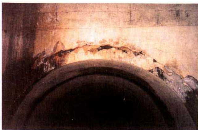
写真6.2.9 管渠と人孔の接続部の破損
