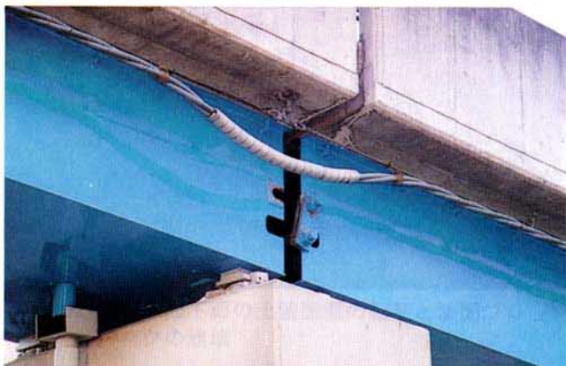
写真3.2.60 耐震連結板の破断
