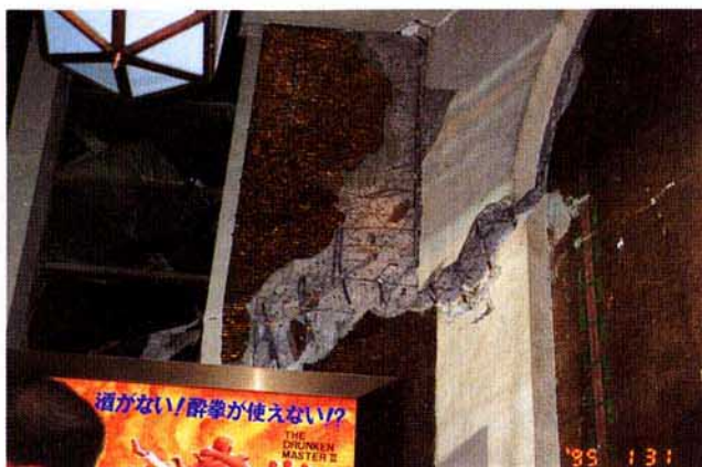
写真3.2.22 東館ビル内 アーチの被害
