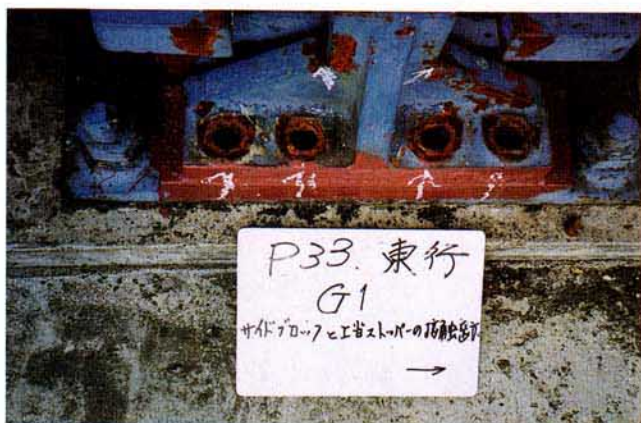
写真4.3.17 高架橋沓座の破損
