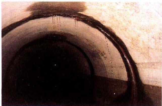
写真6.2.1 管渠の目地からの漏水
