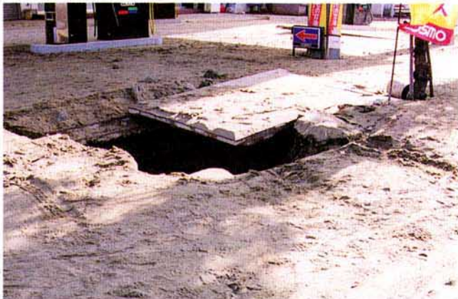
写真4.2.35 浮き上がったマンホール
