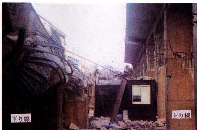
写真3.2.12 高架橋支柱のせん断破壊による倒壊
