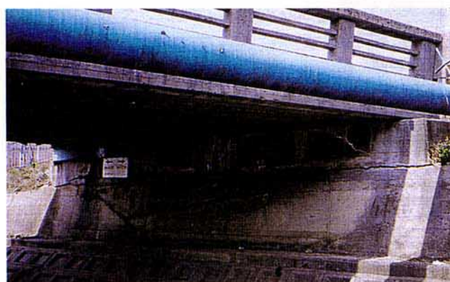
写真4.3.22 橋台のクラック
