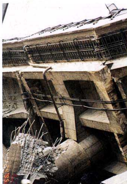
写真4. 3. 23 倒壊したピルツ式PCゲルバー 桁高架橋
