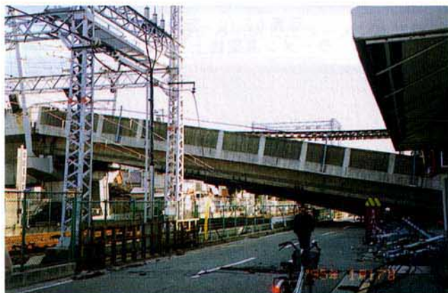
写真3.2.1 山陽新幹線 ラーメン橋台の損傷により落下したPC桁
