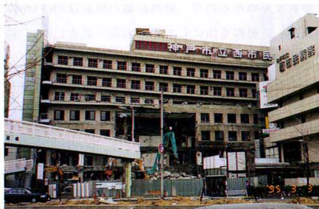
写真1.1.13 5階部分が圧壊した神戸市立西市民病院ビル
