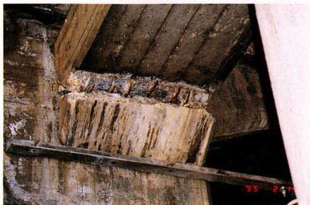
写真4. 3. 13 単径間橋梁の被害例（RC隅角部欠落）
