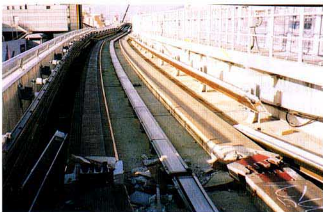
写真3.2.61 六甲アイランド線 走行路の被害
