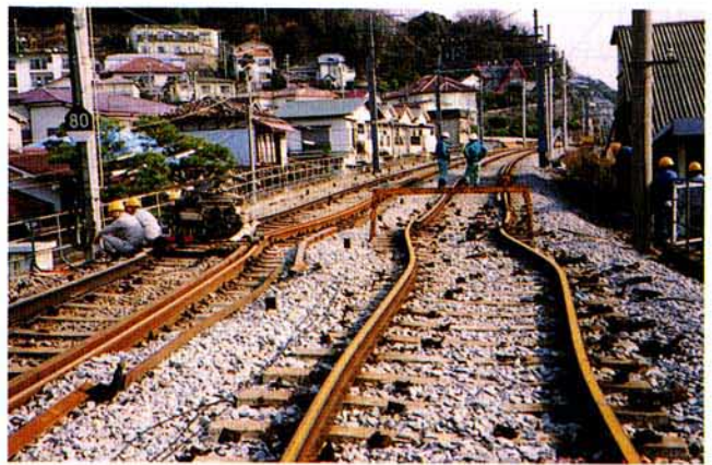
写真3.3.4 山陽電鉄塩屋駅構内被害状況調査
