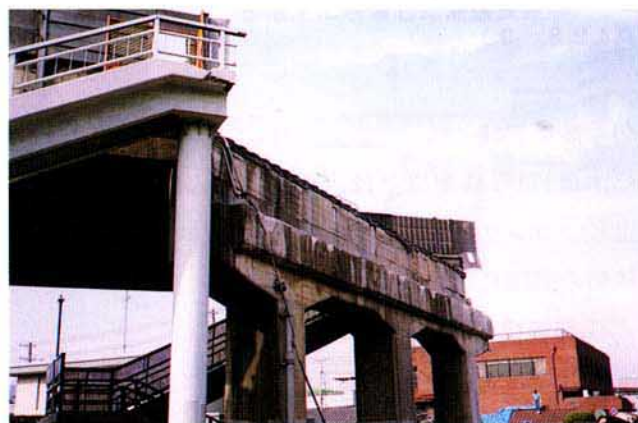
写真4.2.16 桁が落下した国道跨線橋
