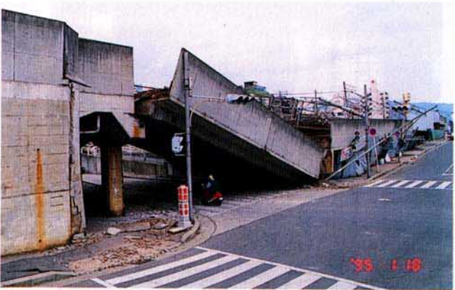
写真3.2.8 架道橋の被害
