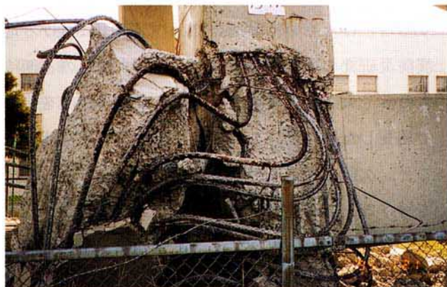
写真1.1.21 山陽新幹線高架橋損傷部
