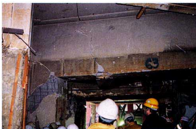
写真3.2.24 同上 軌道桁を受ける梁・柱の被害
