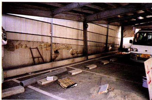
写真4.3.66 重力式擁壁の破損
