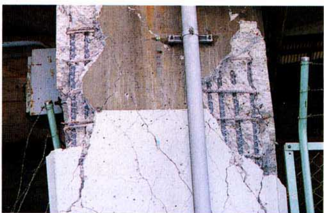
写真3.2.43 同上 コンクリートの欠落
