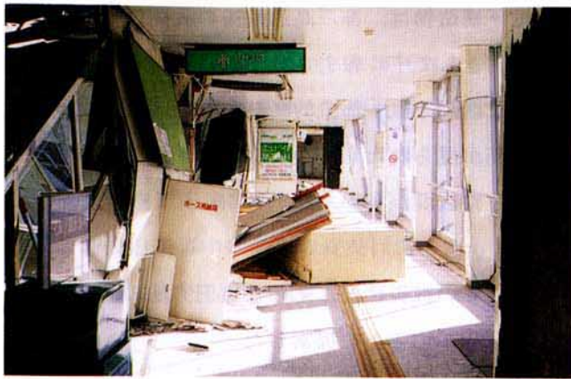
写真3.2.91 コンコース階 軌道桁落下による内装破損
