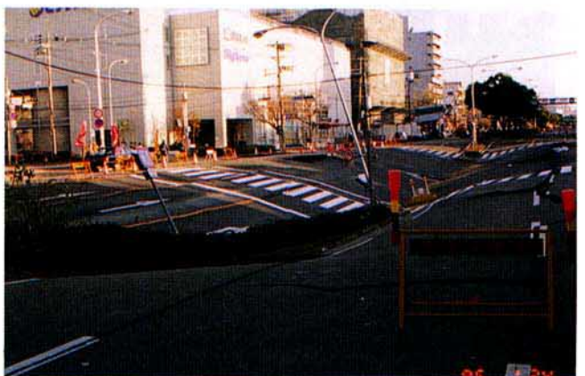
写真4.2.57 損壊した地下鉄駅直上の路面陥没
