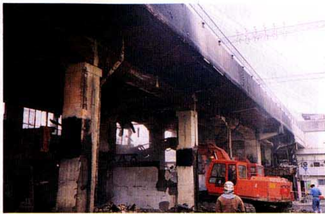
写真3.2.35 地震火災の被害を受けた高架橋
