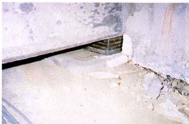
写真4.3.52 新橋端横桁のコンクリート剝離とゴム沓のズレ
