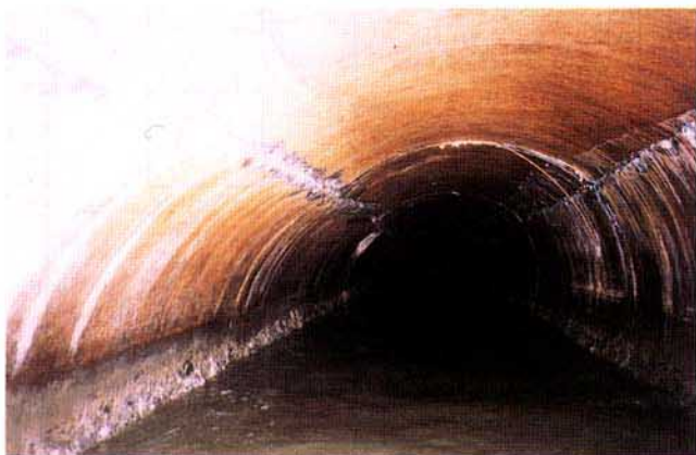
写真6.2.4 ヒューム管の縦断方向クラック
