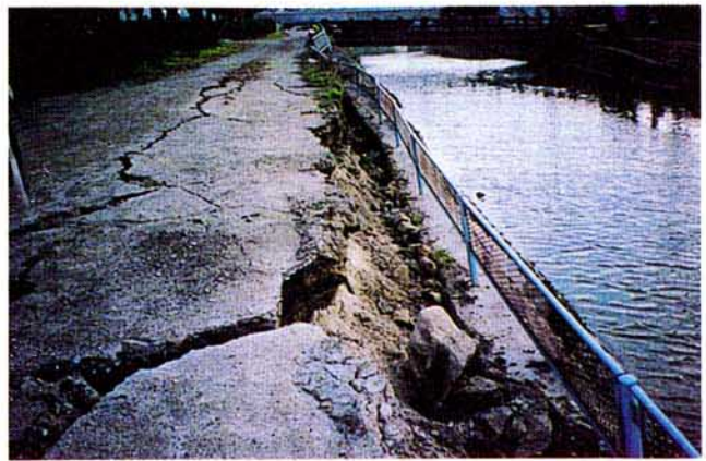
写真5.3.2 地盤の沈下状況とブロック積のすべり崩壊
