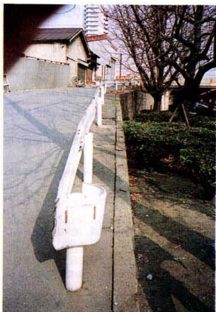
写真4.3.65 重力式擁壁と路 体と隙間
