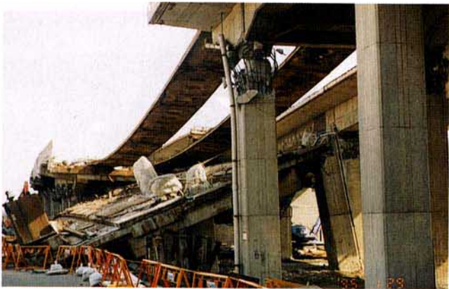
写真3.2.7 JR東海道線 ラーメン高架橋の被害
