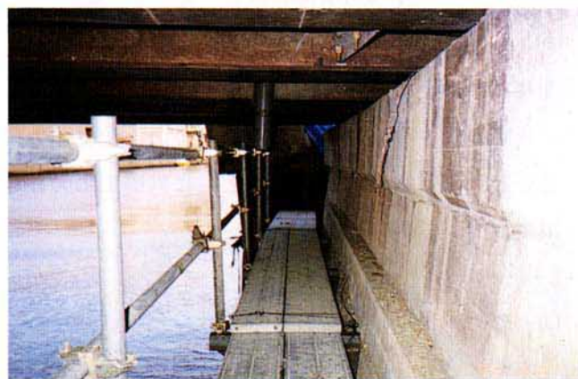
写真4.3.50 旧橋台の打継目部のズレ
