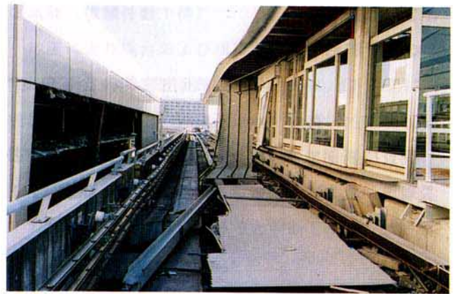
写真3.2.94 プラットホーム階 軒先部の変形及び軒天井の落下
