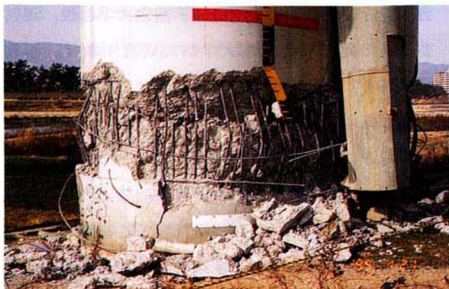
写真1.1.20 山陽新幹線武庫川橋梁の損傷（鉄筋段落 ち部にクラック，鉄筋が圧接部で破断）
