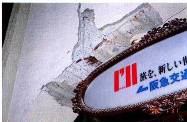
写真3.2.25 同上 梁のアーチ状ひびわれ
