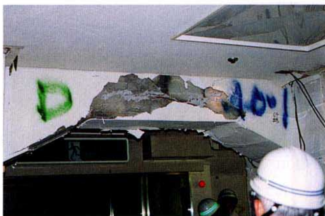
写真3.2.23 同上 アーチ部の被害
