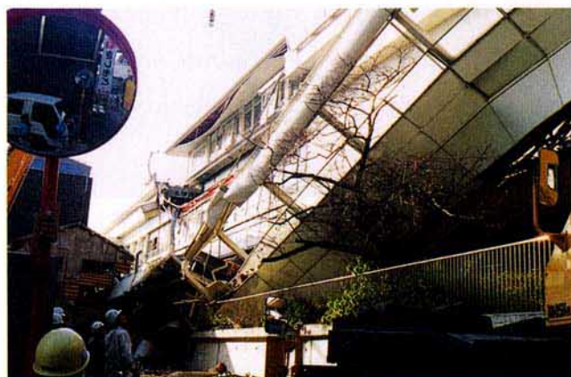
写真3.2.88 新交通住吉駅 軌道桁落下による連絡通路の落下
