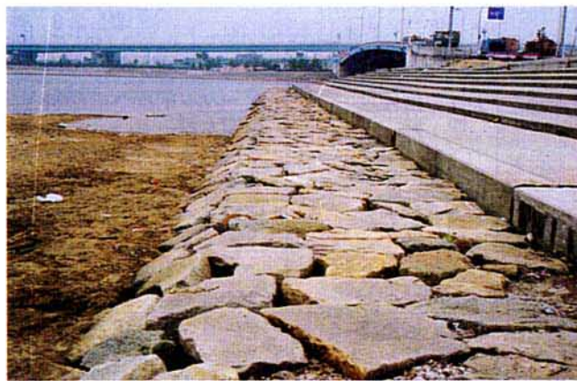
写真5. 2. 12 被害の小さい石積部
