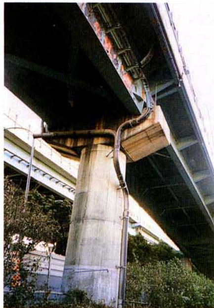
写真4.3.28 橋脚の傾斜により落橋の恐れのある上部工 （対策前）
