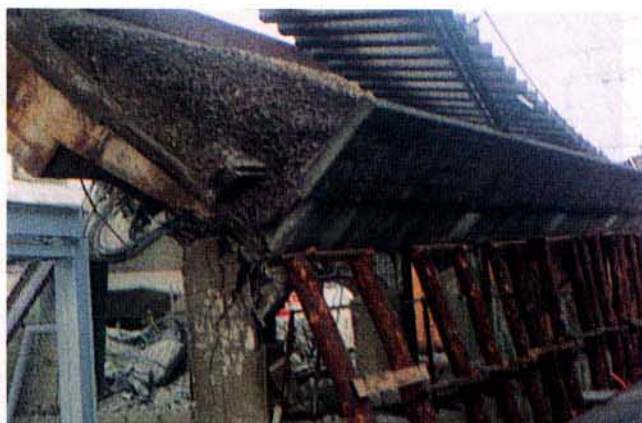
写真3.2.15 上下線とも倒壊したラーメン高架橋
