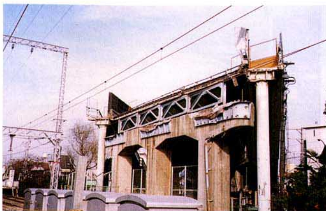
写真4.2.17 桁が落下した国道跨線橋
