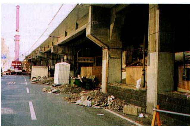
写真3.2.49 同上 橋脚の被害と桁のズレ
