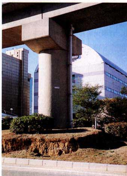
写真3.2.59 液状化により 沈下した橋脚 周辺地盤
