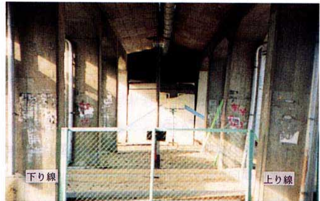
写真3.2.10 阪急電鉄 ラーメン高架橋上り線の傾斜
