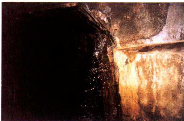
写真6.2.2 管渠の目地からの漏
