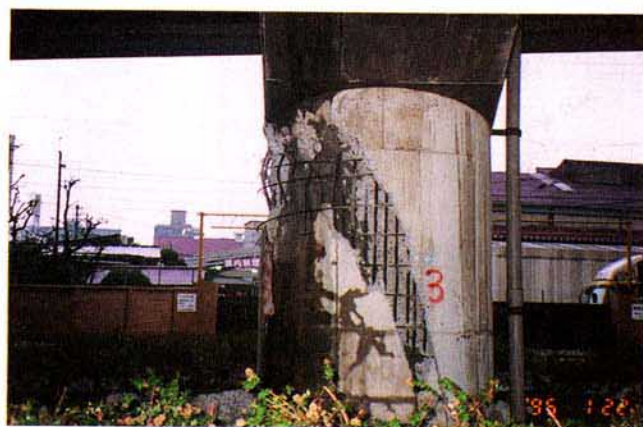
写真4.2.10 高架橋橋脚のせん断ひび割れ
