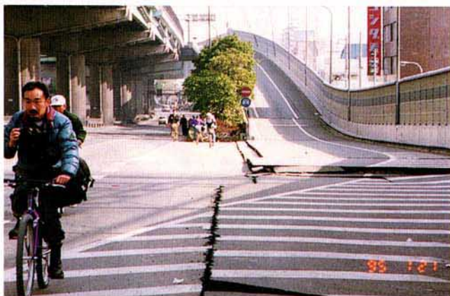
写真4.2.37 ランプ出口の段差
