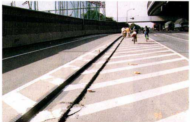
写真4.2.38 ランプ出口のクラック
