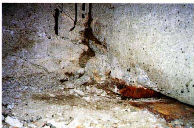
写真4.3.53 旧橋桁端部の損傷とロッカー沓のズレ
