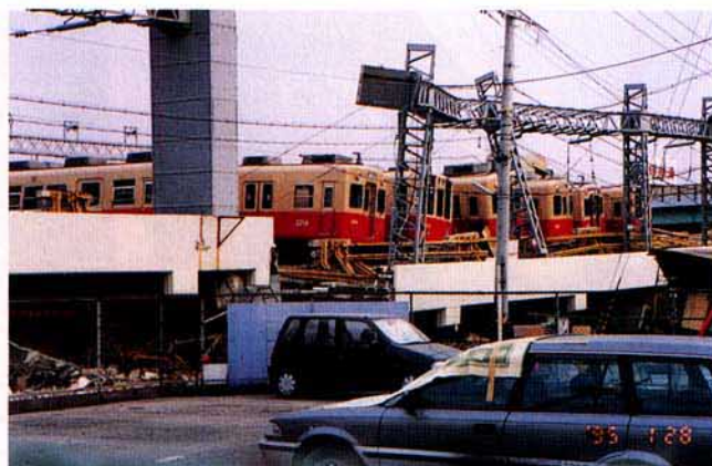
写真3.2.38 留置線高架橋軌道面の落下
