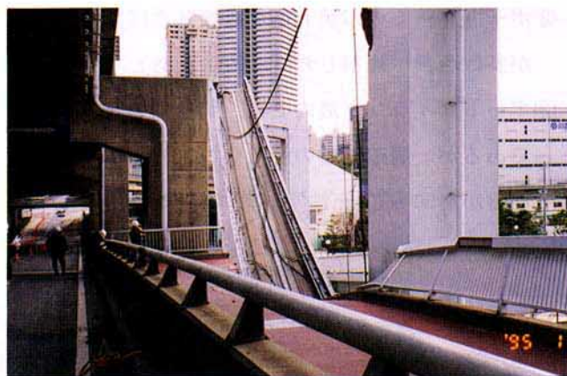
写真3.2.64 落下した軌道桁
