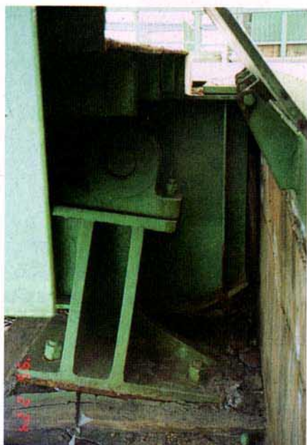
写真4.3.61 支承のアンカー ボルトの抜け出 し
