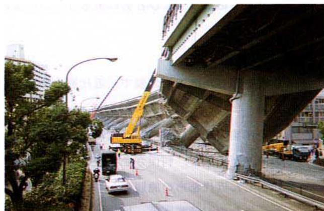
写真1.1.3 横転した阪神高速道路（東灘区魚崎本町付近）
