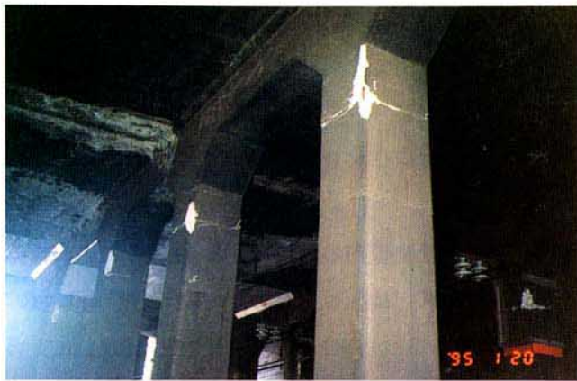
写真4.3.43 ラーメン柱上端部クラック
