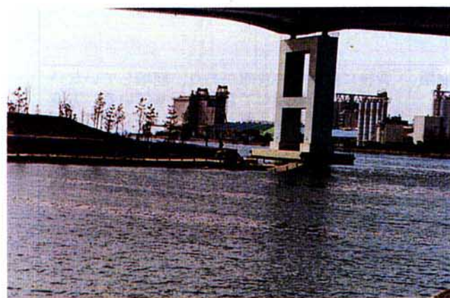
写真5. 2. 11 埋立地角部の沈下
