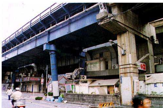
写真3.2.46 架道橋ラーメン橋脚の鋼管支柱の破断
