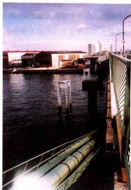
写真6.2.10 下水管橋の落橋
