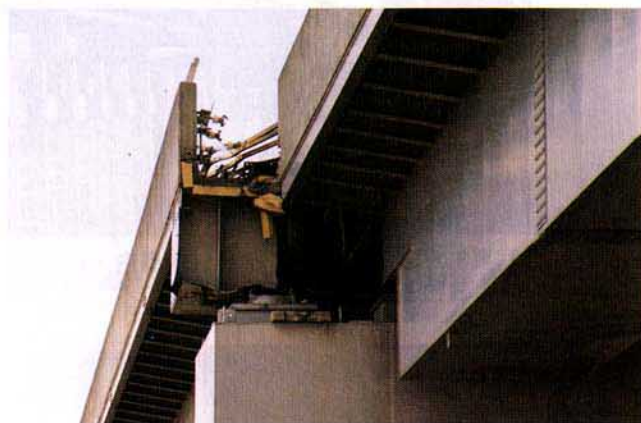
写真3.2.65 六甲大橋起点側の桁のズレ
