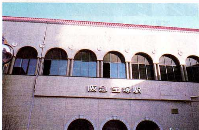
写真3.2.79 阪急電鉄宝塚駅 ジョイント部がズレ外部へ押し出された壁
