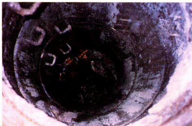
写真6.2.8 ブロックの破損
