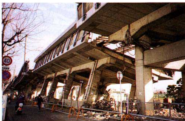
写真1.1.1 山陽新幹線高架橋が崩壊
