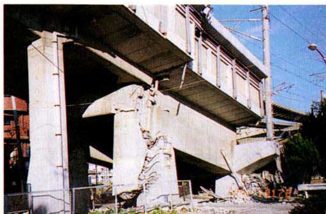
写真3.2.2 ラーメン橋台の被害
