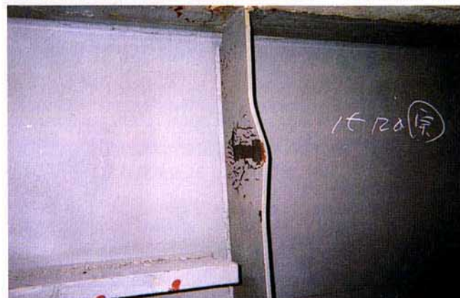
写真3.2.87 スチフナーの座屈
