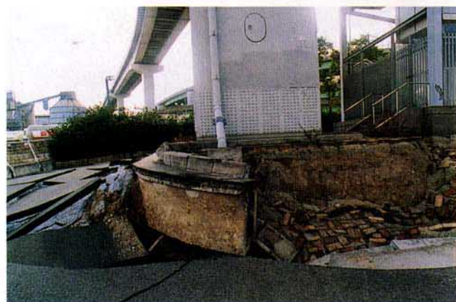
写真3.2.66 液状化による橋脚根巻き部分の地盤沈下
