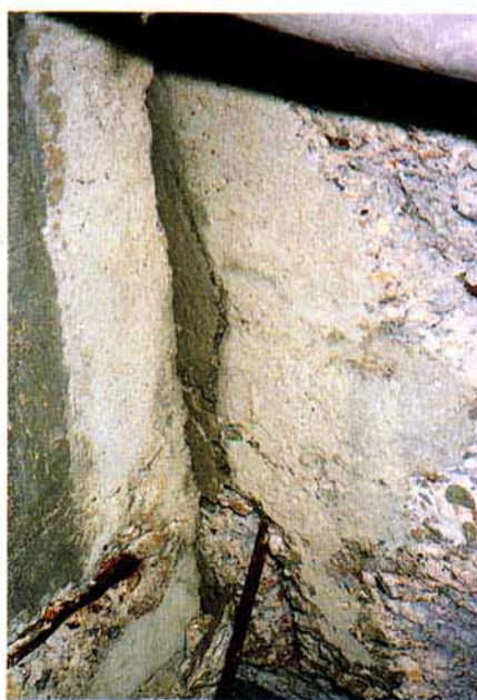
写真4.3.8 単径間橋梁の被 害例 （橋台パラペッ トの亀裂）
