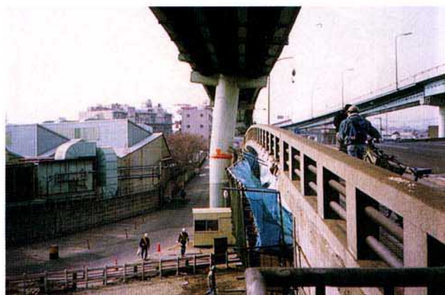
写真4. 2. 61 阪神高速道路の鋼製橋脚の座屈
