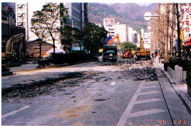
写真4.2.53 沿道建物の倒壊による路面の凹凸
