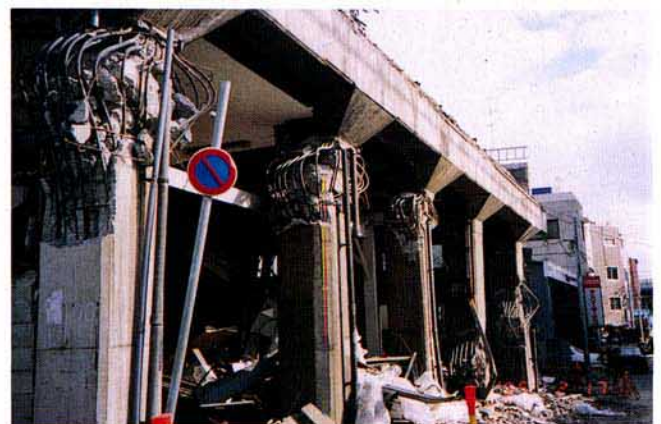
写真3.2.40 車庫取付部ラーメン高架橋の破壊
