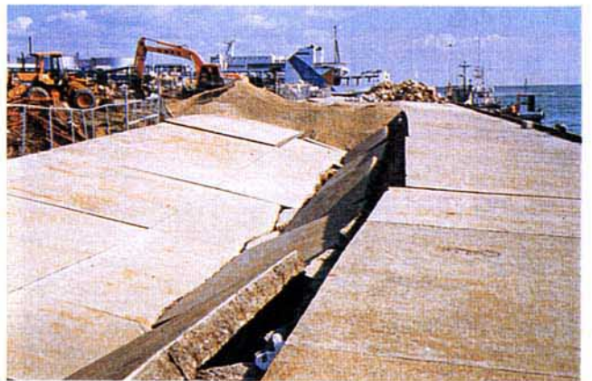
写真5.2.2 ケーソンの沈下、滑動に伴う背後エプロン陥没
