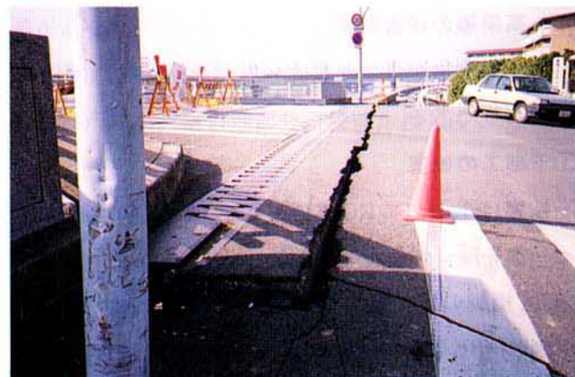
写真4.2.5 橋梁取付部の亀裂
