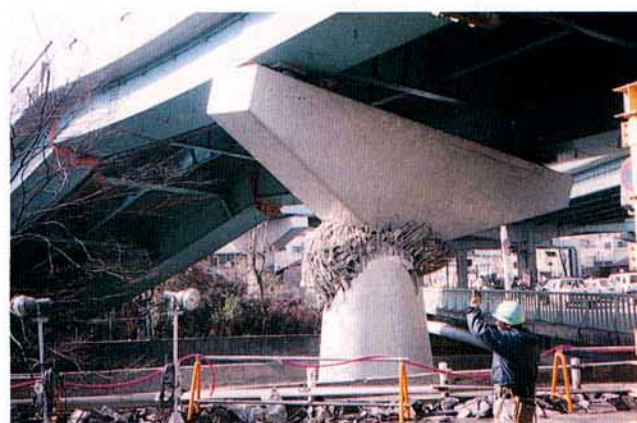
写真4. 2. 63 RC橋脚の被害
