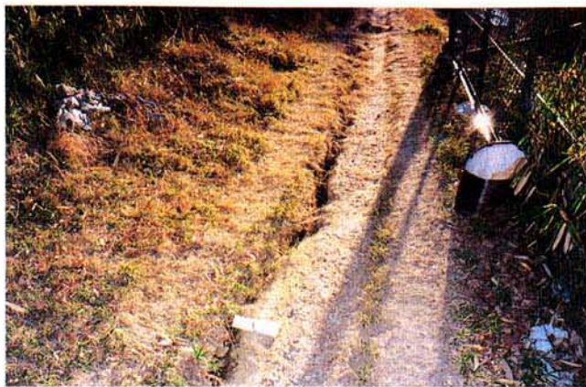
写真2.3.10 活断層に沿う亀裂
