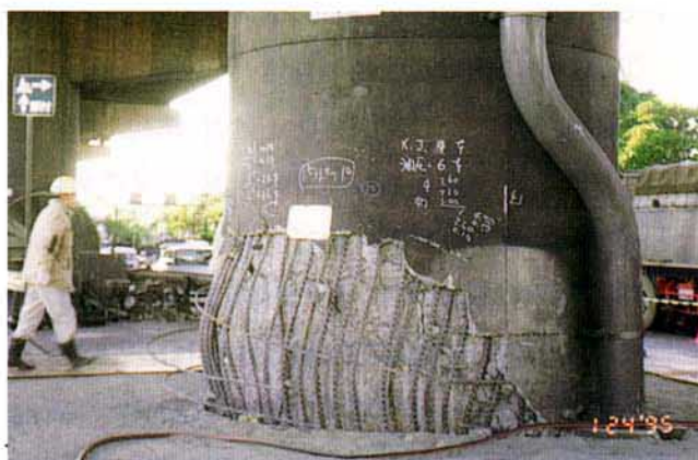
写真4. 3. 25 鉄筋が変形した橋脚
