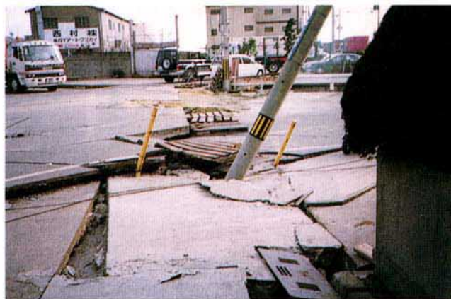
写真4. 2. 60 コンクリート舗装版の被害
