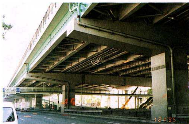
写真4. 2. 33 鋼製ラーメン橋脚の座屈による塗装の はがれ
